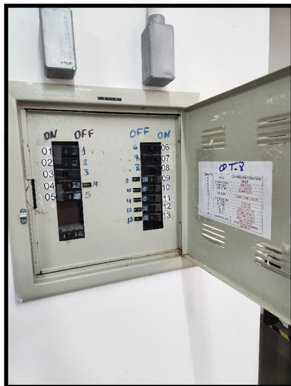
Figura 10. UTILIZAÇÃO DE QUADROS DE DISTRIBUIÇÃO COMO INTERRUPTORES, QUADROS COM DISJUNTORES DO TIPO NEMA, E SEM A PRESENÇA DE DISPOSITIVOS DPS E DR.
