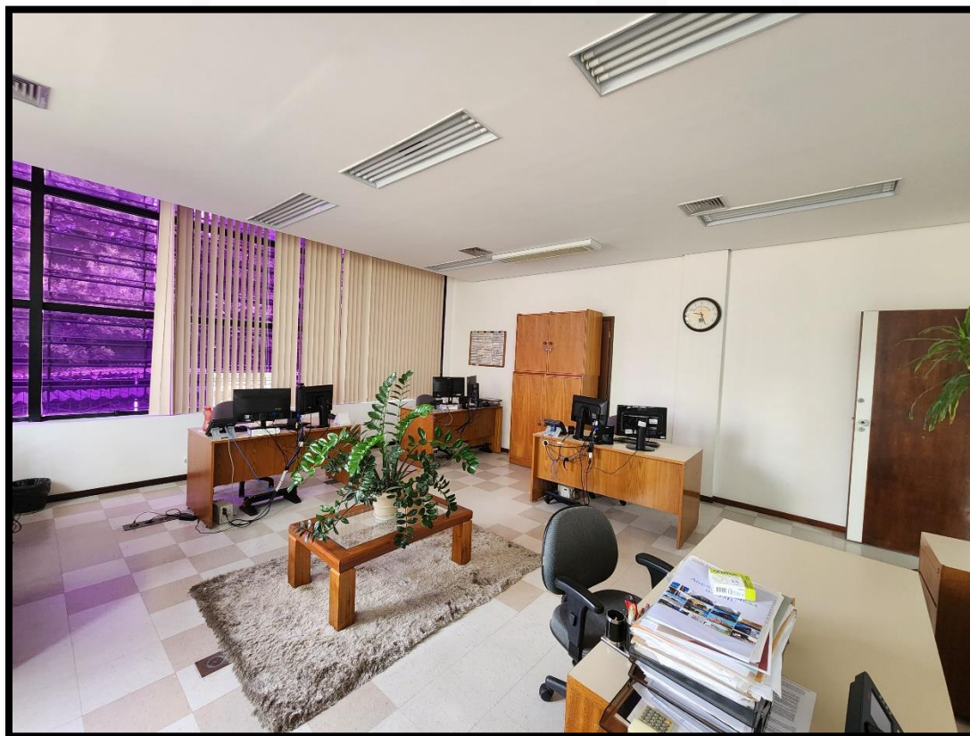
Figura 6. UTILIZAÇÃO DE TOMADAS DE PISO QUE DEVEM SER INUTILIZADAS CONFORME SOLICITADO.
