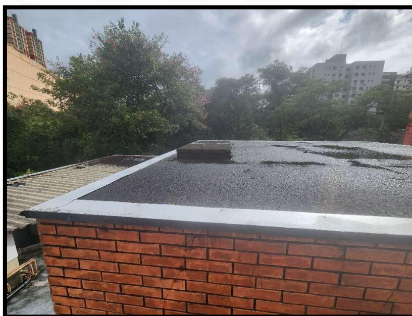
Figura 8 - Reservatório de Concreto e Patologias
