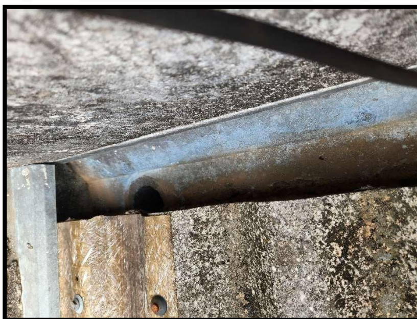
Figura 4 - Calhas e Patologias.
