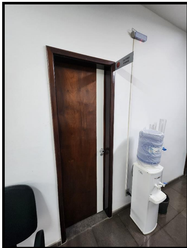
Figura 7. INFRAESTRUTURA ELÉTRICA DE ILUMINAÇÃO DE EMERGÊNCIA EM DESCONFORMIDADE COM AS NORMAS.
