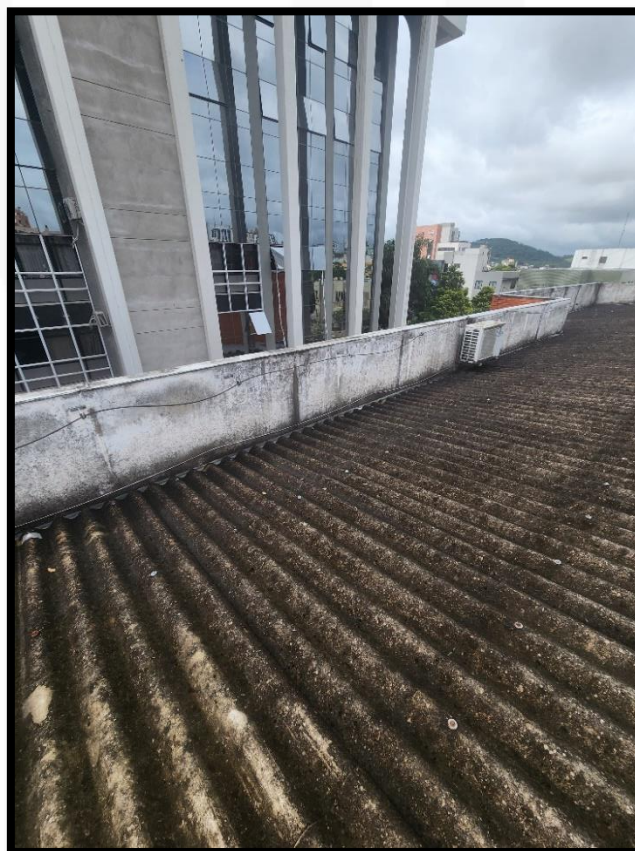
Figura 2. ISOLADORES E CORDOALHAS DE SPDA COM FALHAS NA FIXAÇÃO.
