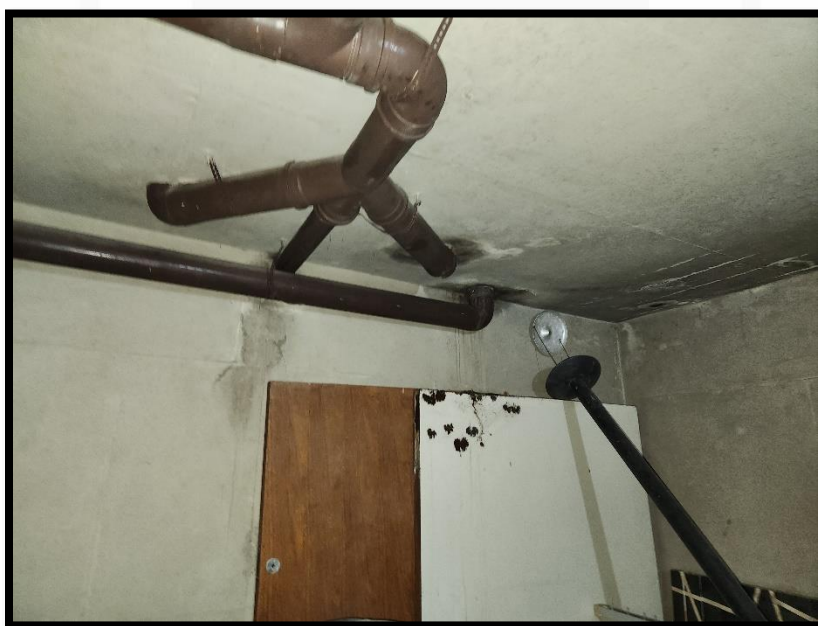
Figura 4 – Vazamento em junções de tubulações
