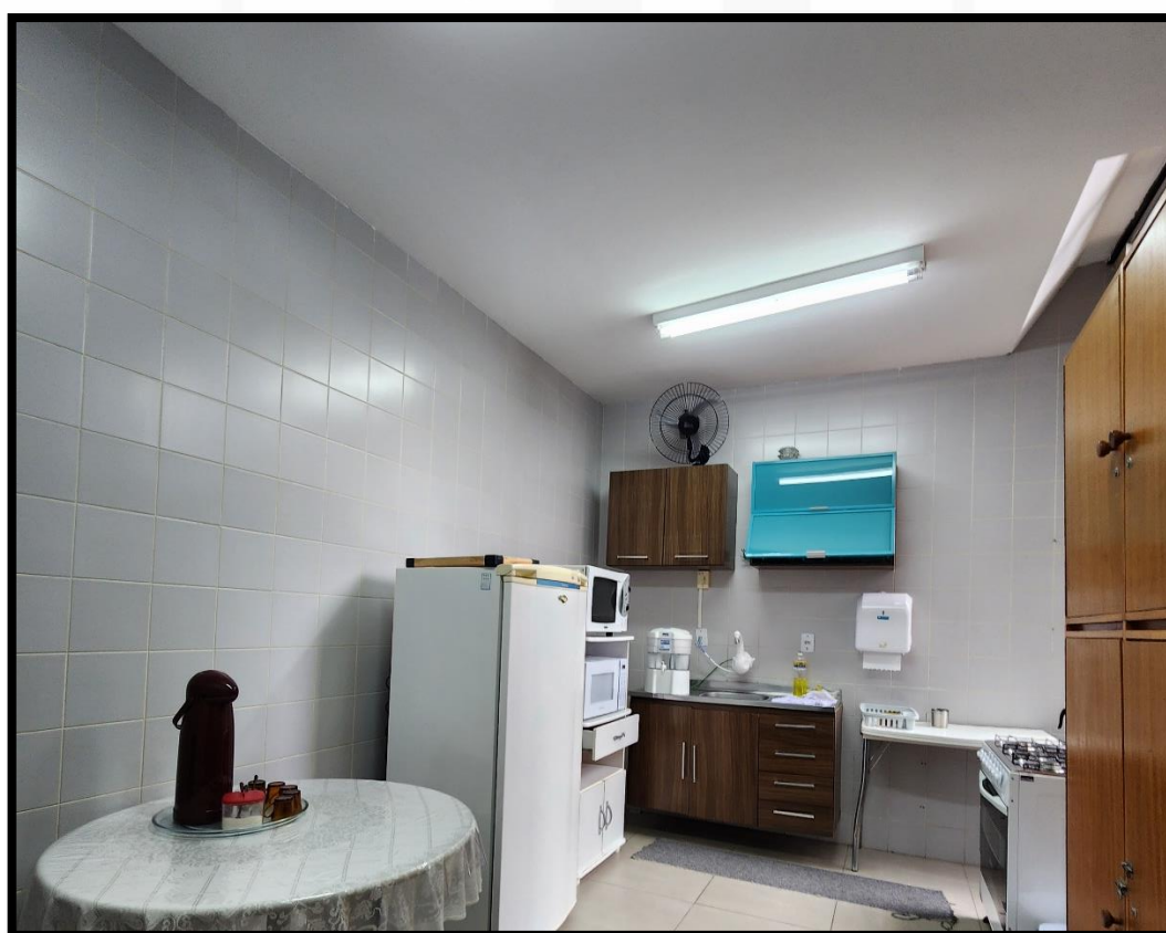
Figura 4. INSTALAÇÕES ELÉTRICAS INADEQUADAS EM ÁREAS MOLHADAS.
