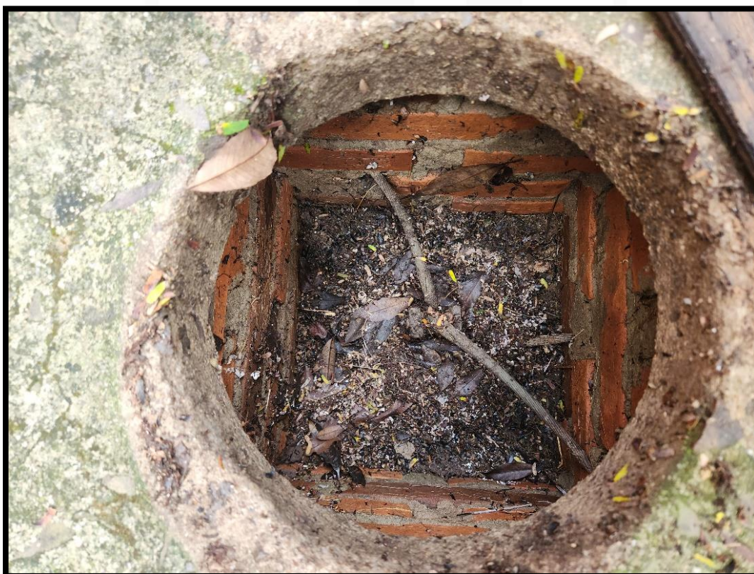
Figura 4. CAIXAS DE INSPEÇÃO SPDA COM ACUMULO DE SUJEIRA, E OXIDADAS.
