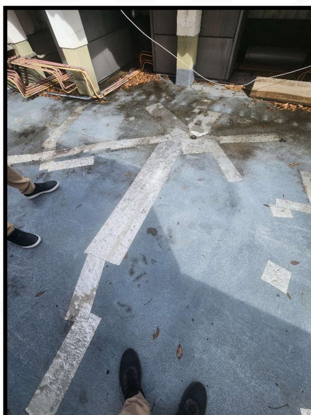
Figura 9 - Patologias Laje de Cobertura
