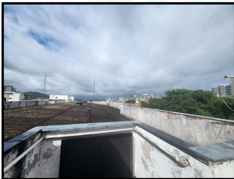
Figura 3 - Rufos de proteção das Alvenarias
