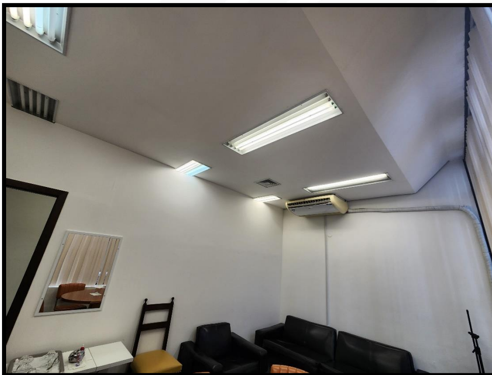
Figura 3. AMBIENTES COM ILUMINAÇÃO INCOMPATÍVEL COM O LAYOUT DOS AMBIENTES E COM LUMINÂNCIA ABAIXO DO PRECONIZADO PELAS NORMAS.
