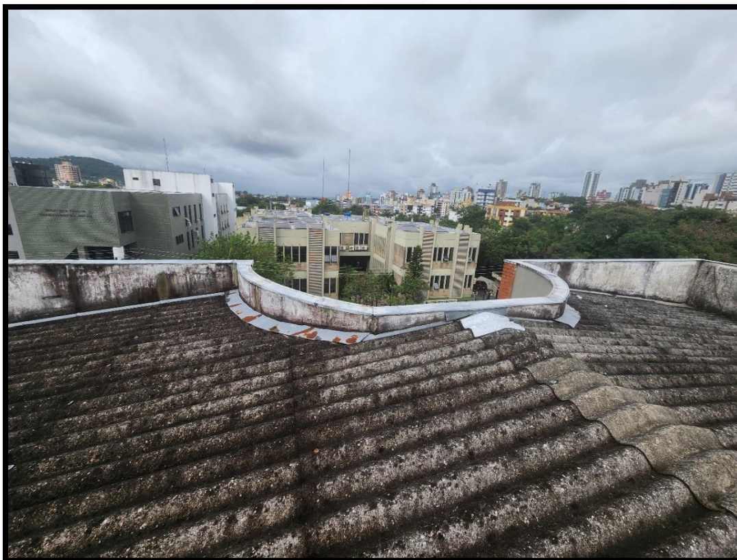
Figura 3. TRECHOS DA EDIFICAÇÃO SEM COBERTURA DO SPDA.
