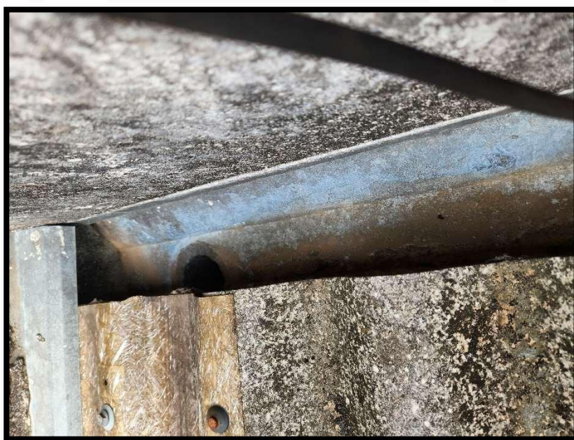
Figura 4 - Calhas e Patologias.
