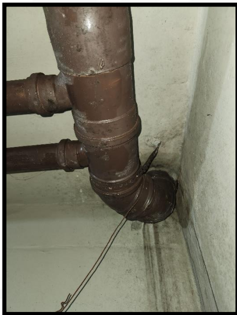
Figura 3 – Vazamento em conexão de esgoto
