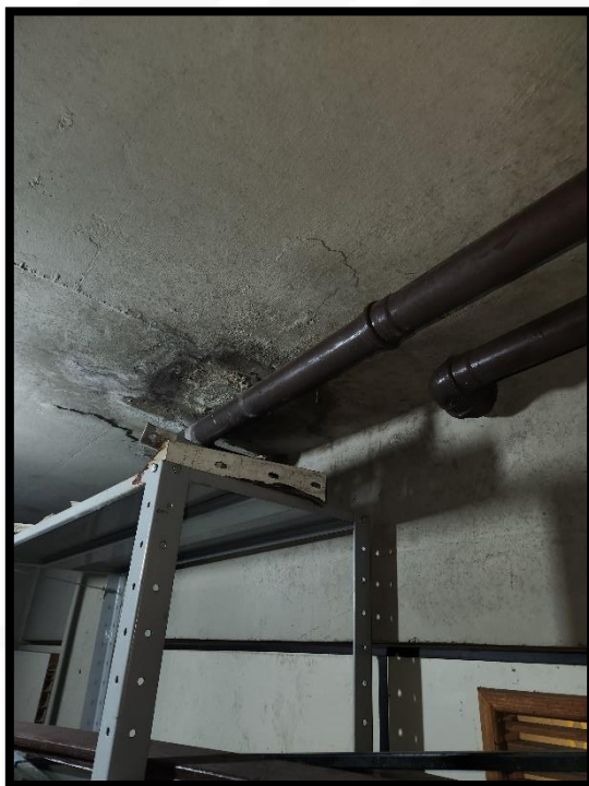
Figura 5 – Laje com infiltração
