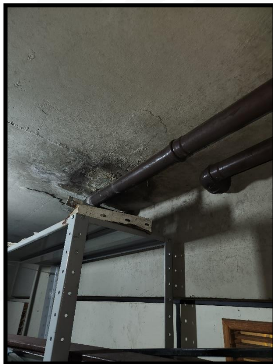
Figura 5 – Laje com infiltração
