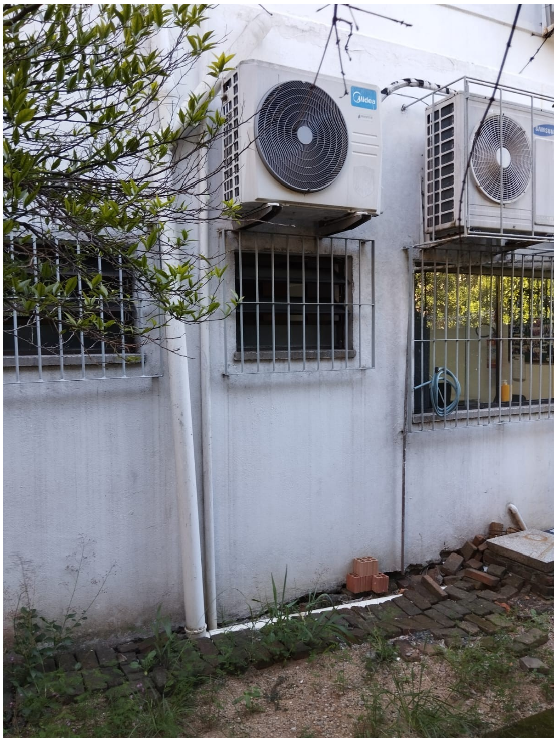
Foto 02: Condensadora do equipamento.
