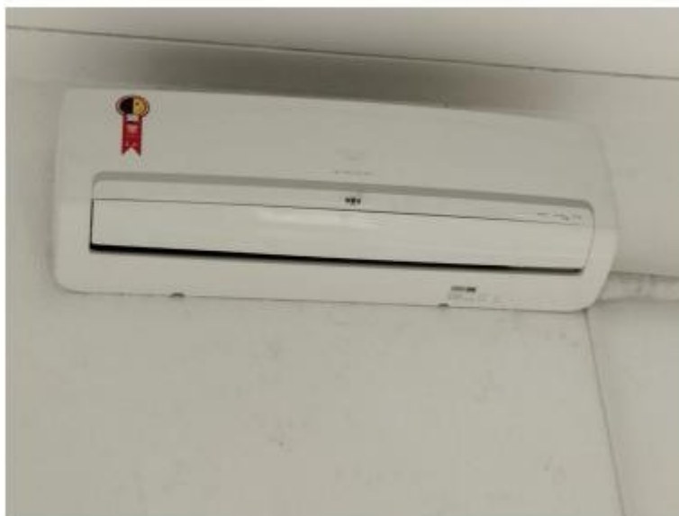
Foto 01: Evaporadora do equipamento.
