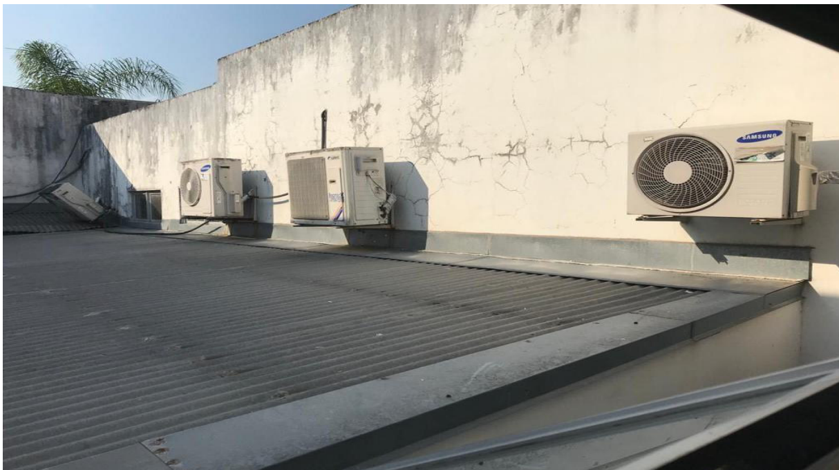
Foto 03: Condensadoras dos aparelhos.
