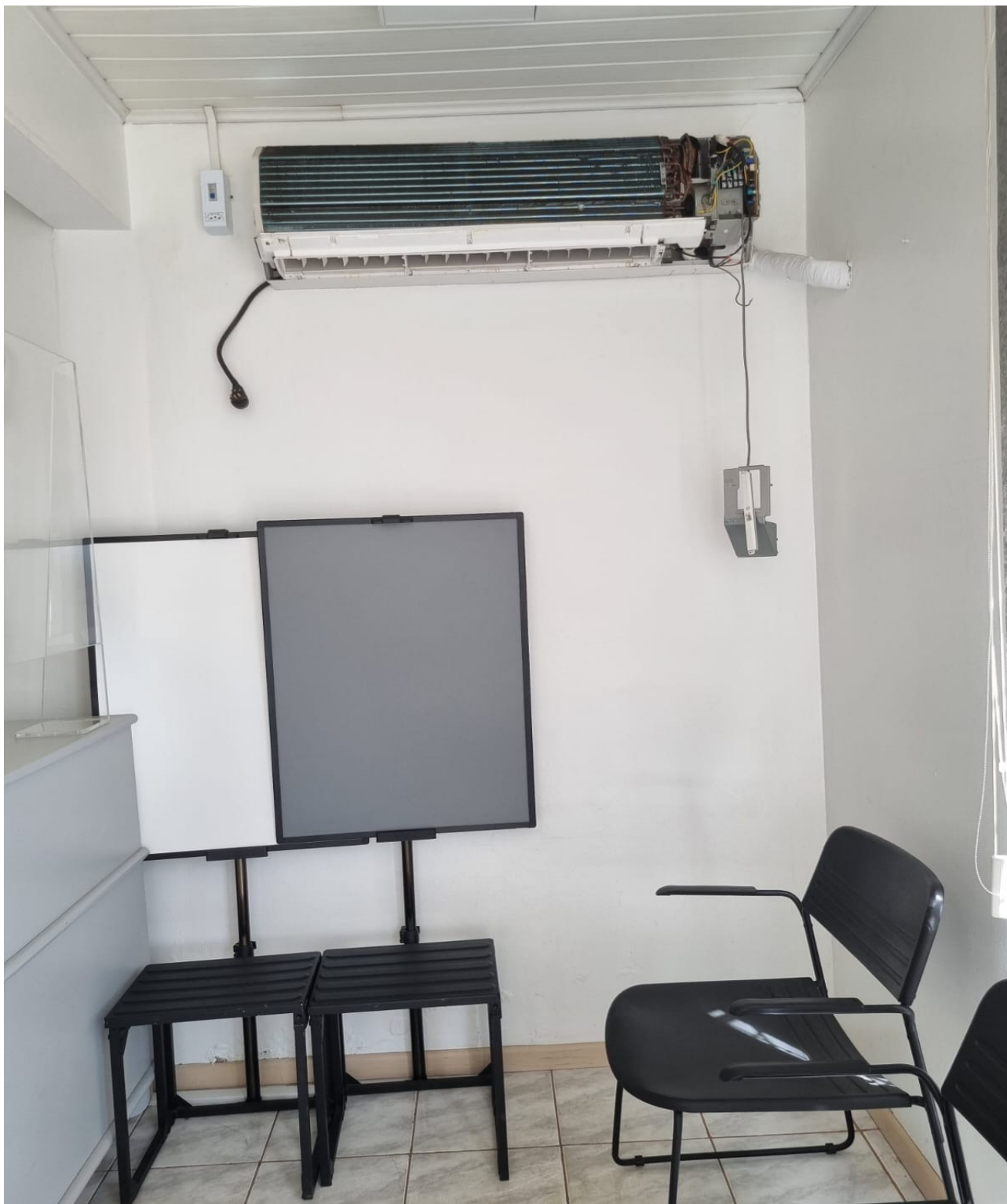
Foto 01: Evaporadora do equipamento a que se refere o item 1.
