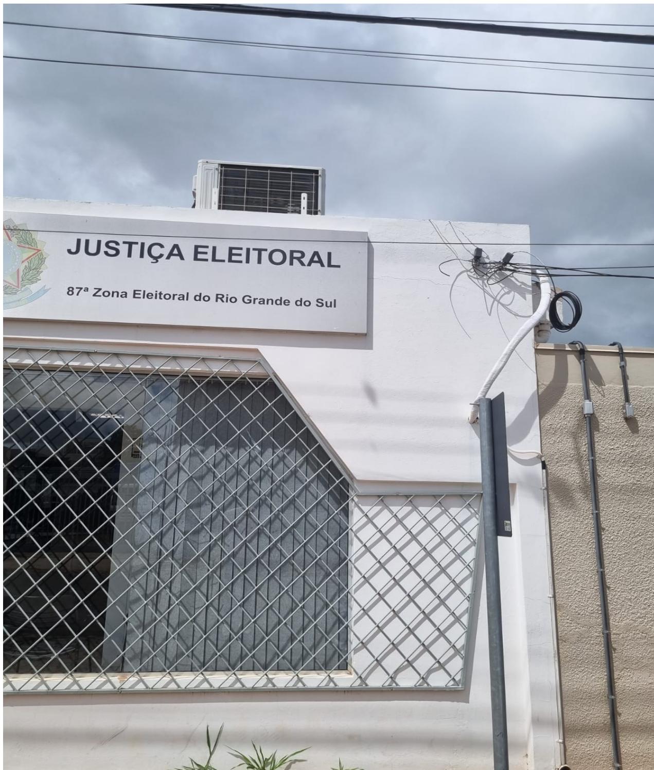
Foto 02: Condensadora do equipamento a que se refere o item 1.
