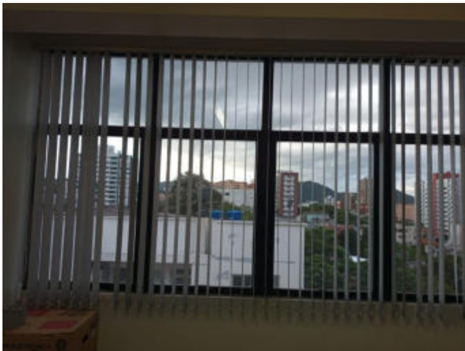
Foto 07: Persiana para manutenção, conforme descrito no item 3.2.
