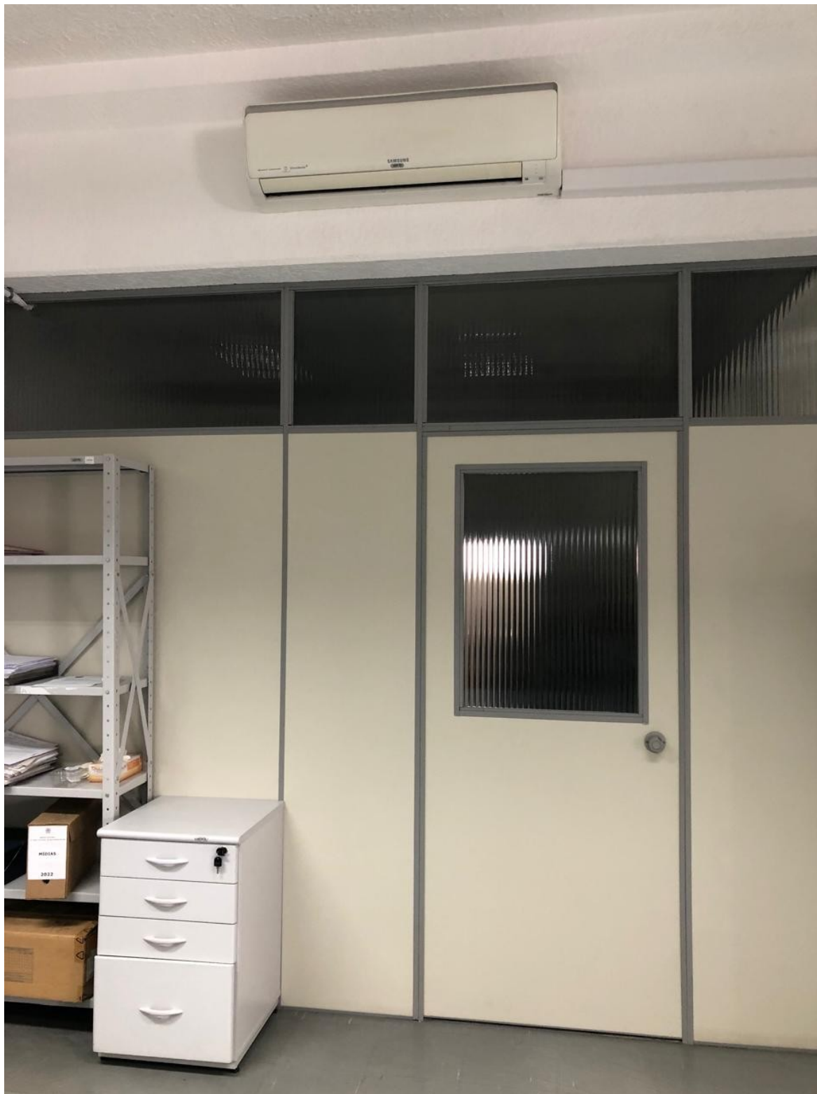
Foto 02: Evaporadora do aparelho item 02.
