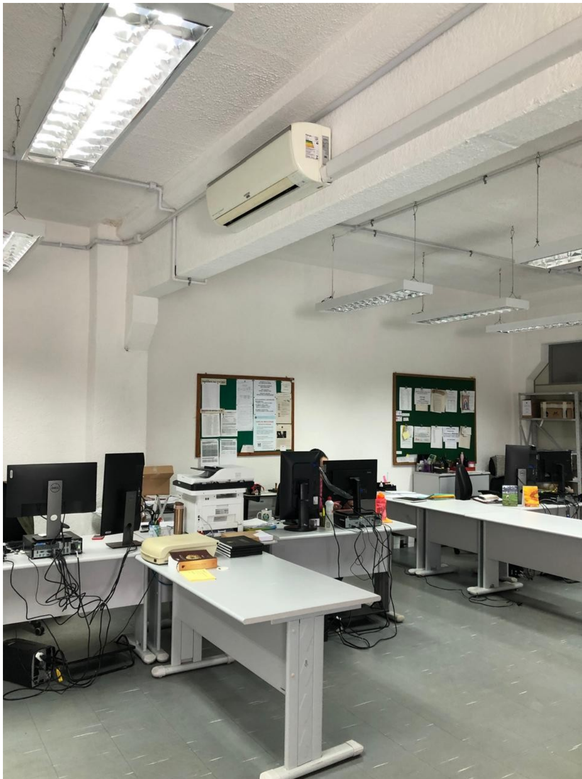
Foto 01: Evaporadora do aparelho item 01.
