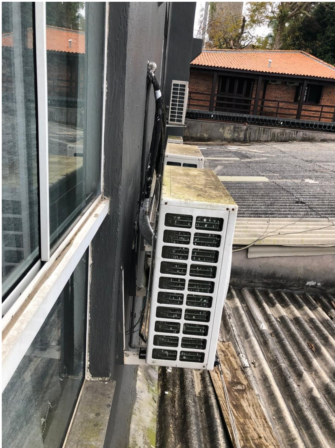
Foto 03: Condensadoras dos aparelhos.
