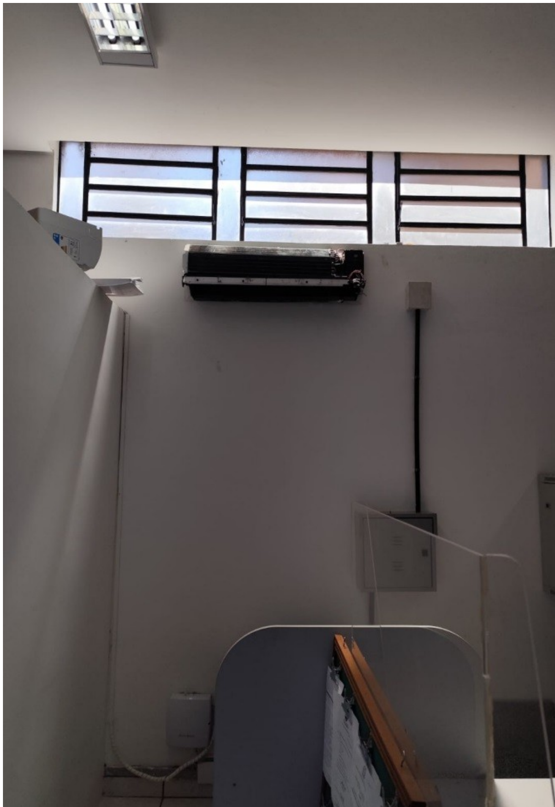
Foto 01: Evaporadora do equipamento.
