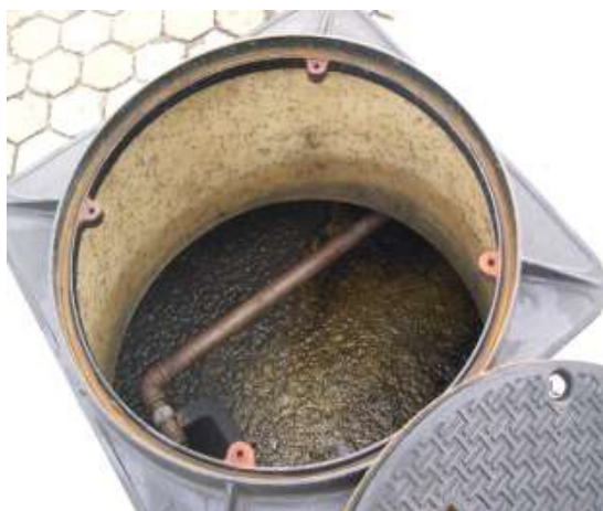
Figura 04 – divisão anaeróbia (entrada) do tratamento.
