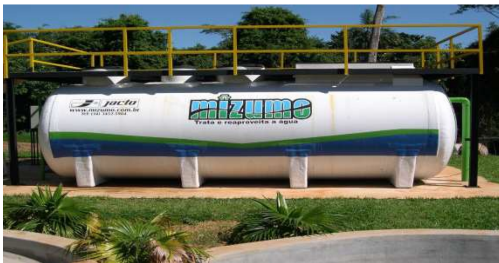
Figura 02 – Mizumo instalado e em funcionamento na Usina de Açúcar e Alcool.
