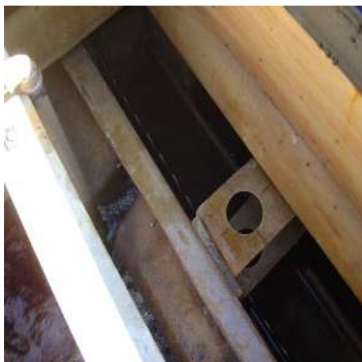
Figura 10 – detalhe do suporte do tubo clorador.
