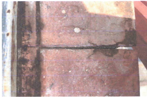
Foto 23 - Peitoril: falha ou falta de rejunte
