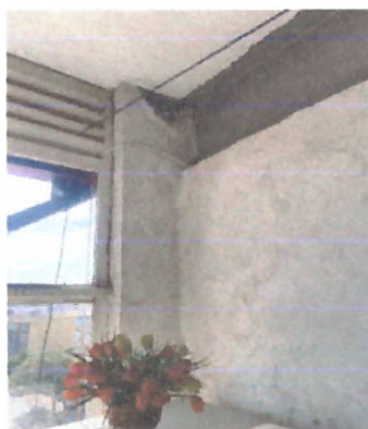
Foto 19 - Sala adm: infiltrações
