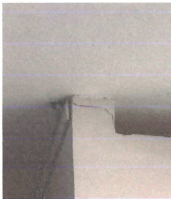
Foto 27 - Banheiro / Copa: trinca
