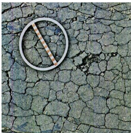
Figura 3 – Trinca interligada – tipo jacaré. Adaptado de (DNIT, 2003).
