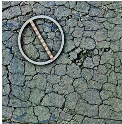
Figura 3 – Trinca interligada – tipo jacaré. Adaptado de (DNIT, 2003).
