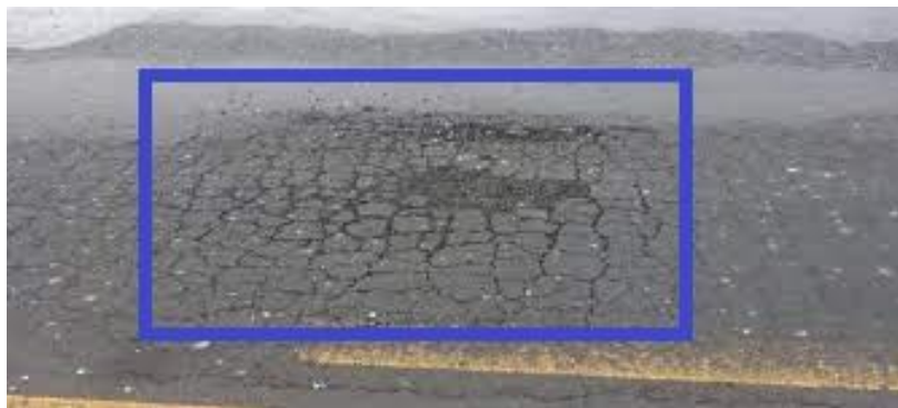
Figura 4 – Área de remoção do revestimento com trincas interligadas.
