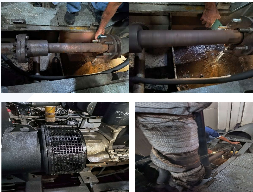
Figs. 4 Eixos empenados, folgas, vazamentos, reversores com vazamento, falta de isolamentos nas descargas dos propulsores principais.
