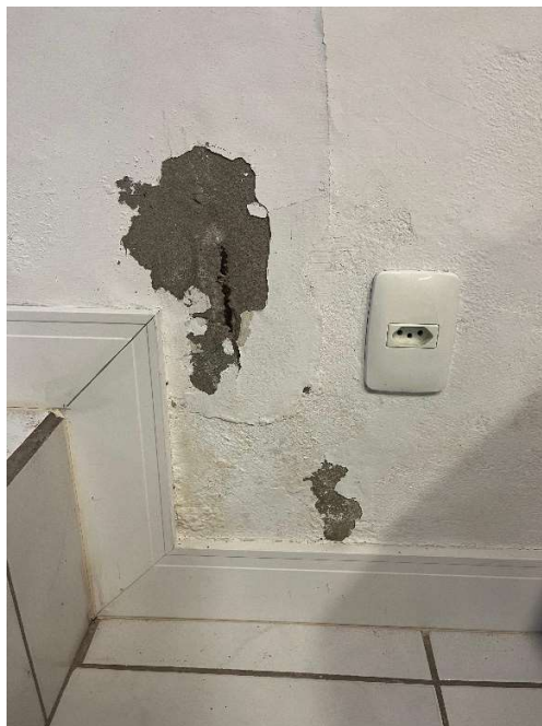
Imagem 2 – Aço aparente sem cobertura mínimo exigido por Norma
