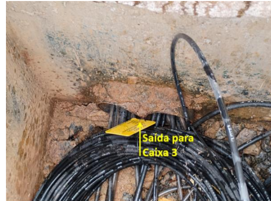
Foto 6 – Detalhe – Caixa 2: Saída do cabeamento em direção à Caixa 3.
