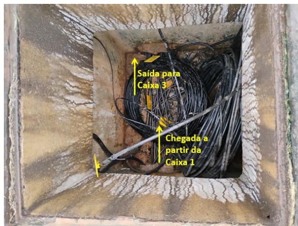
Foto 4 – Caixa 2 (aberta): Passagem do cabeamento por baixo do gramado do LNCC.
