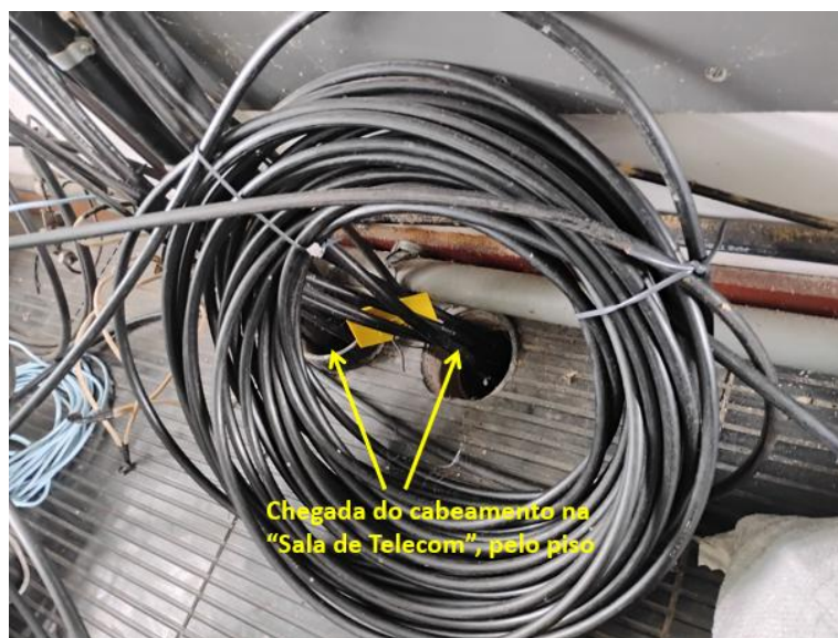
Foto 11 – “Sala de Telecom”: Entrada do cabeamento de telefonia no prédio do LNCC, chegando a esta sala pelo piso.
