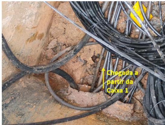
Foto 5 – Detalhe – Caixa 2: Chegada do cabeamento a partir da Caixa 1.
