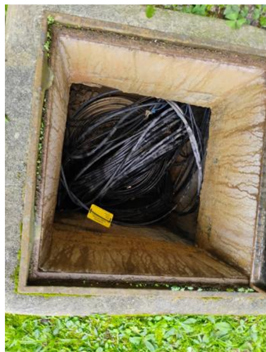
Foto 8 – Caixa 3 (aberta): Passagem subterrânea do cabeamento, próximo à fachada do prédio do LNCC.
