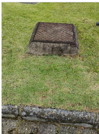
Foto 3 – Caixa 2 (fechada): Passagem do cabeamento por baixo do gramado do LNCC.
