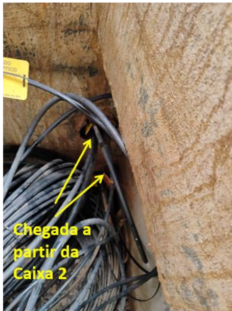
Foto 9 – Detalhe – Caixa 3: Chegada do cabeamento a partir da Caixa 2.
