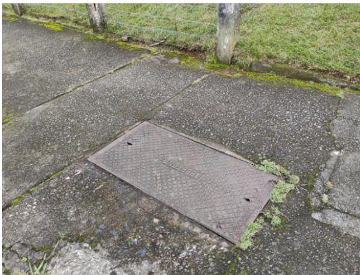
Foto 1 – Caixa 1 (fechada): Entrada do cabeamento de telefonia para o LNCC.
