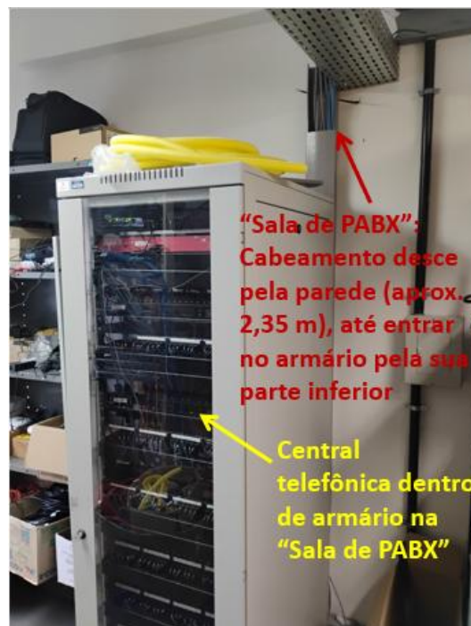
Foto 13 – “Sala de PABX”: Cabearamento de telefonia desce, pela parede, da eletrocalha até a parte inferior do armário dentro do qual está a Central Telefônica.
