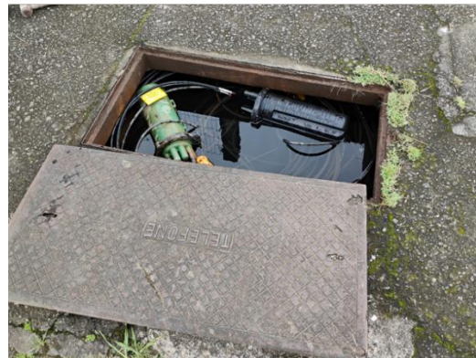
Foto 2 – Caixa 1 (aberta): Entrada do cabeamento de telefonia para o LNCC.
