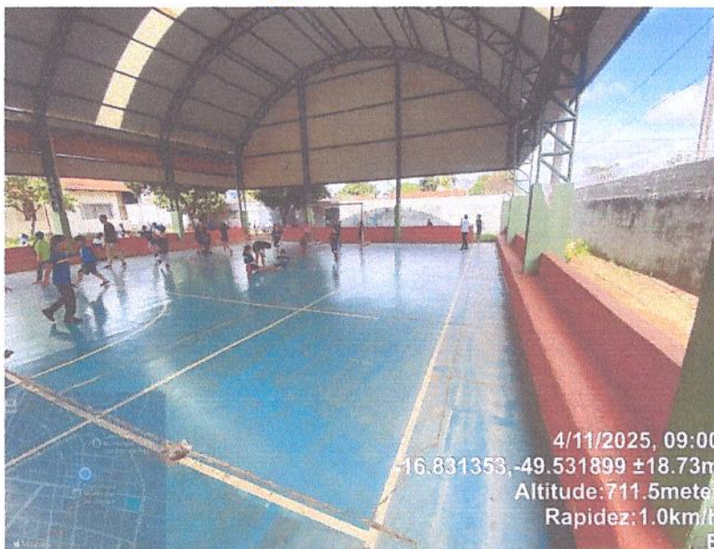
Figura 7. Situação interna da quadra e arquibancadas.
