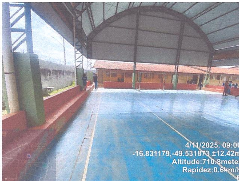
Figura 2. Pintura desgastada e fissuração excessiva no piso.
