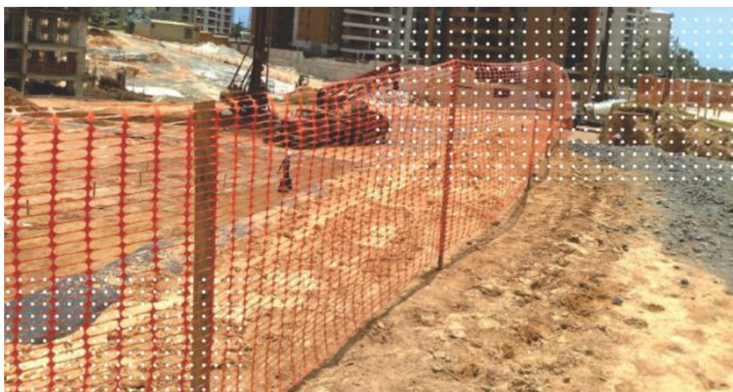
Figura 7 - Rede de isolamento de área em obra.
