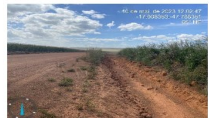
Ausência de drenagem.
