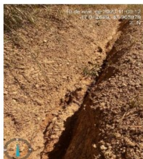
Erosões por falta de dispositivo de drenagem
