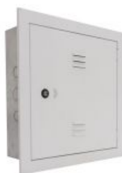
Figura 6: Distribuidor Geral de Telefonia - DGT
