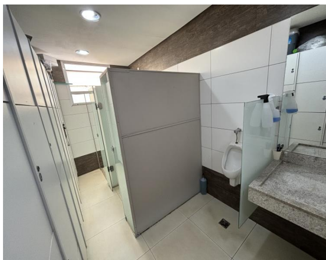
Figura 2: GAECO – Boxes do Banheiro Masculino
