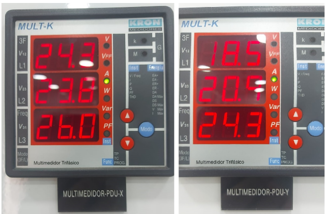
Figura 02 - Data Center DETRAN – Corrente instantânea (Ampéres - A) medida no Multimetro Local
