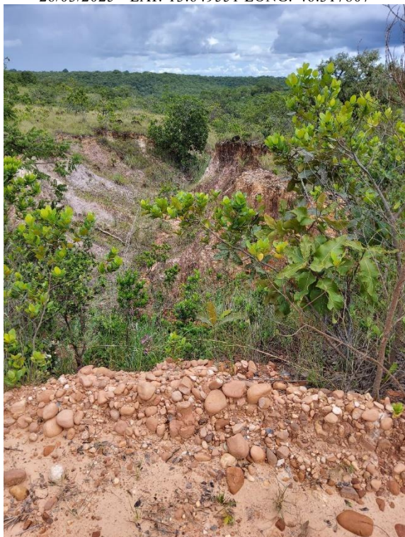
Foto 9 – Erosão na faixa de domínio – km 11,3.
