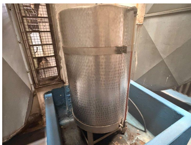
Foto 82: Reservatório de combustível Gerador.
