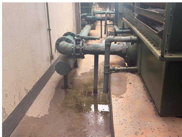
Foto 8: Tubulação torre de resfriamento chiller.
