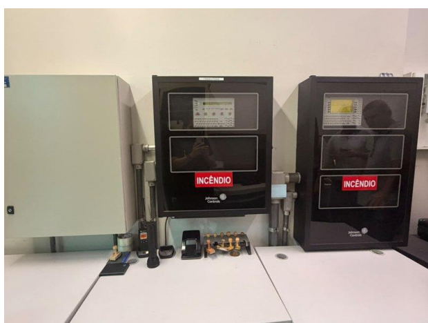
Foto 65: Automação do sistema de combate a incêndio.
