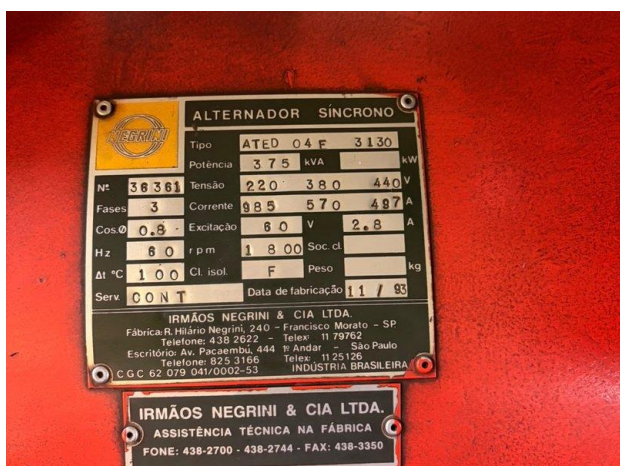
Foto 87: Placa de identificação Gerador.
