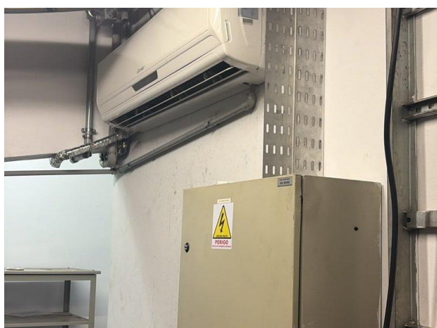
Foto 107: Refrigeração do Banco de Baterias e Nobreaks subestação.
