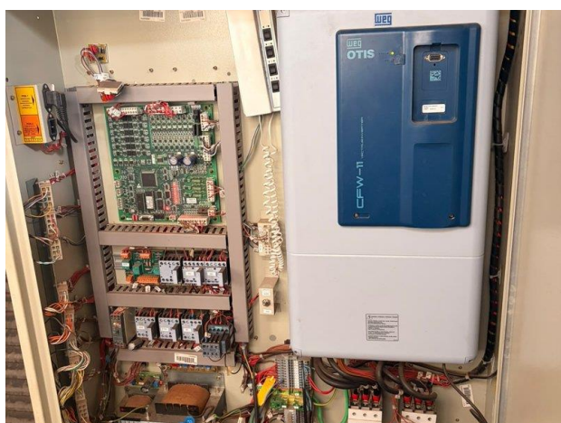
Foto 29: Quadro de comando elevador.
