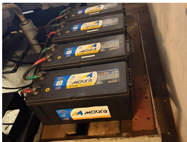
Foto 90: Baterias Grupo Gerador de Energia.
