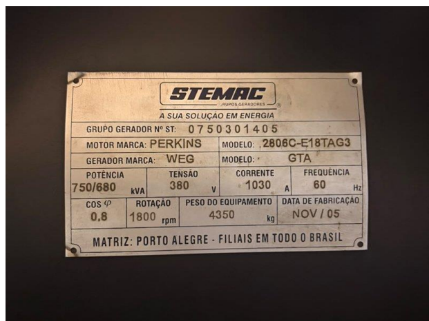
Foto 89: Placa de identificação Grupo Gerador de Energia.
