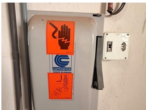
Foto 13: Chave fusível elevador.
