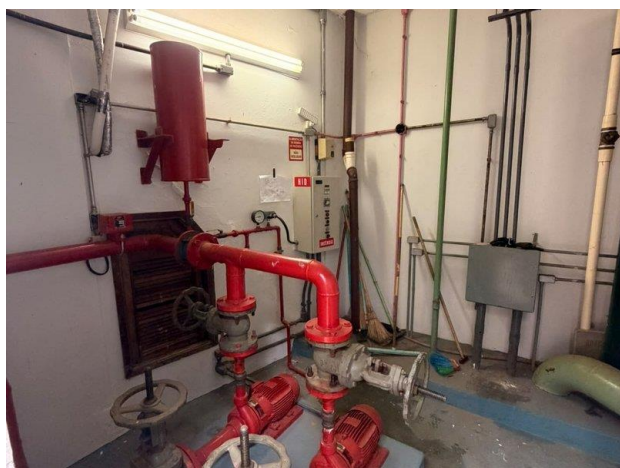
Foto 25: Sistema de combate a incêndio.
