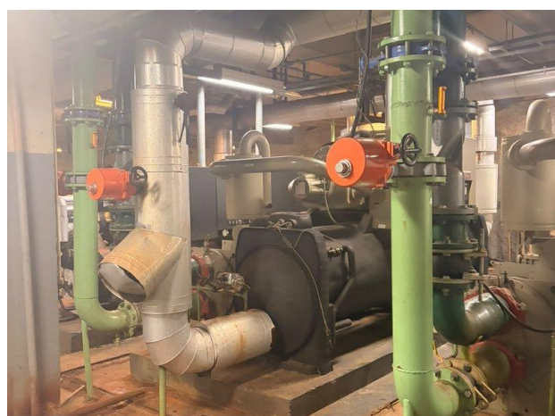
Foto 93: Central de Água Gelada.
