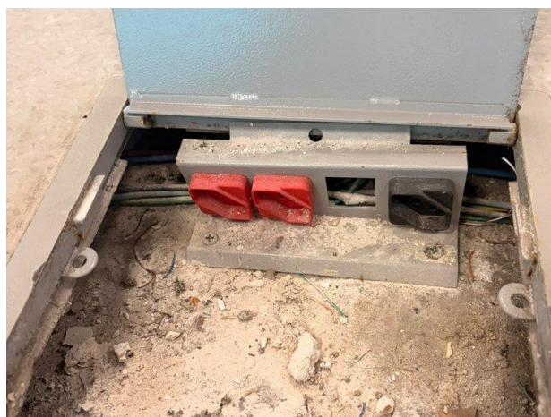
Foto 58: Caixa de passagem.
