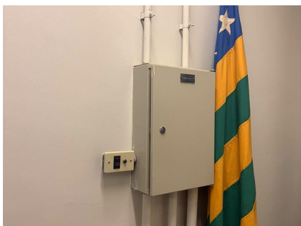
Foto 73: Quadro elétrico do auditório.
