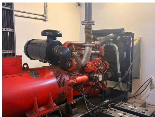
Foto 86: Grupo Gerador de Energia.
