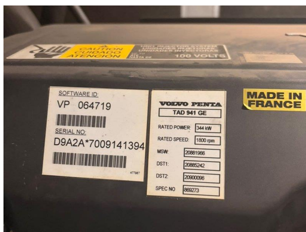
Foto 108: Placa de identificação motor grupo gerador.
