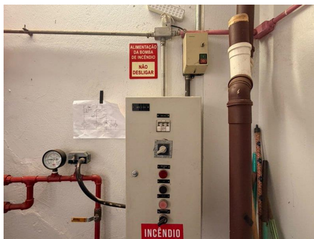
Foto 26: Quadro de comando Sistema de combate a incêndio.
