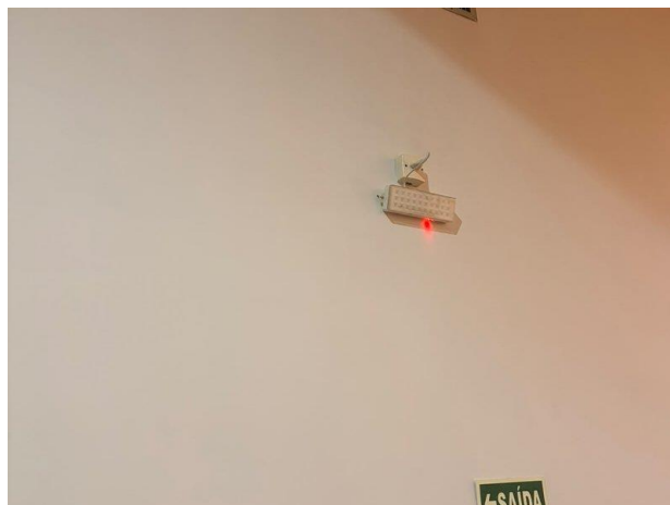
Foto 70: Luminária de emergência.
