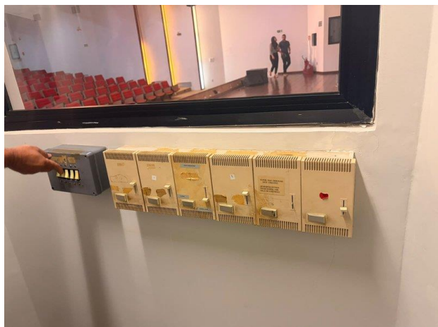
Foto 71: Interruptores do auditório.
