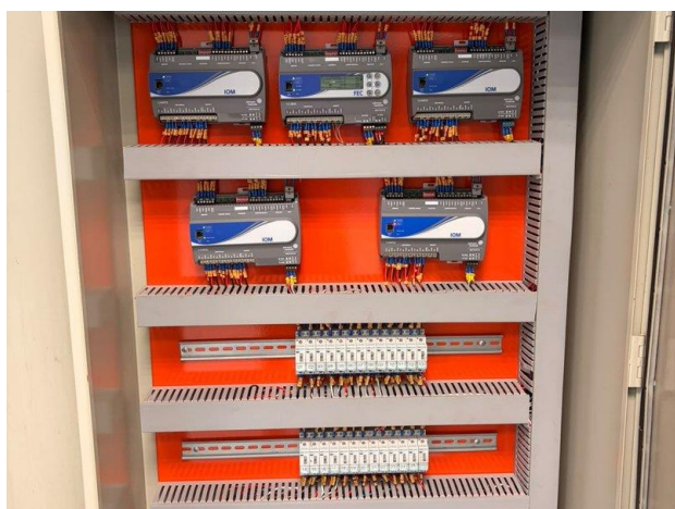
Foto 53: Quadro do sistema de automação.
