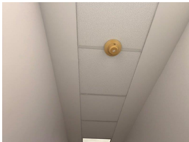
Foto 46: Forro e detector de fumaça.
