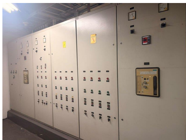
Foto 91: Quadros da Subestação.
