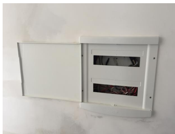
Quadro sem fiação e disjuntores
