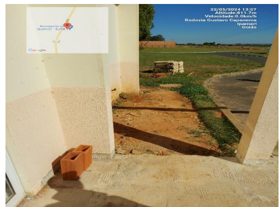
Falta calçada em volta do prédio
