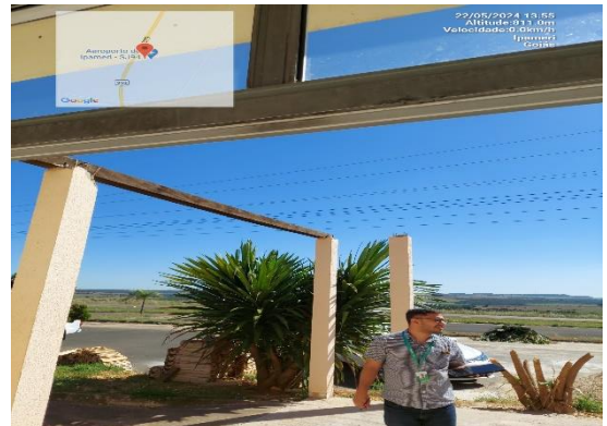
Falta telhado geral
