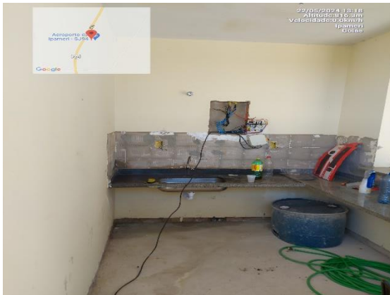
Quadro de comando existente
