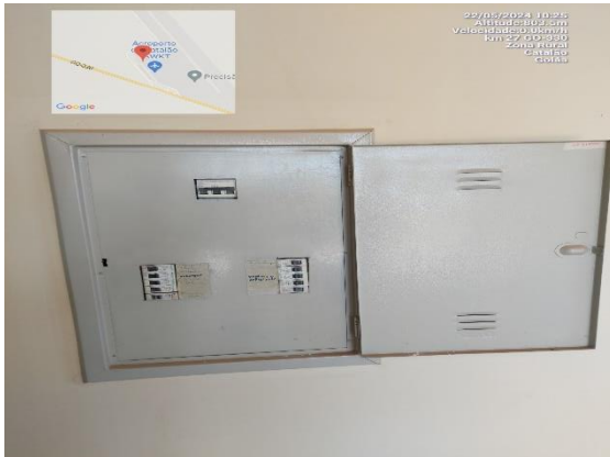
Quadro de comando novo
