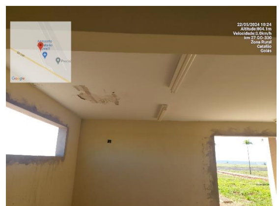
Tetos com infiltrações
