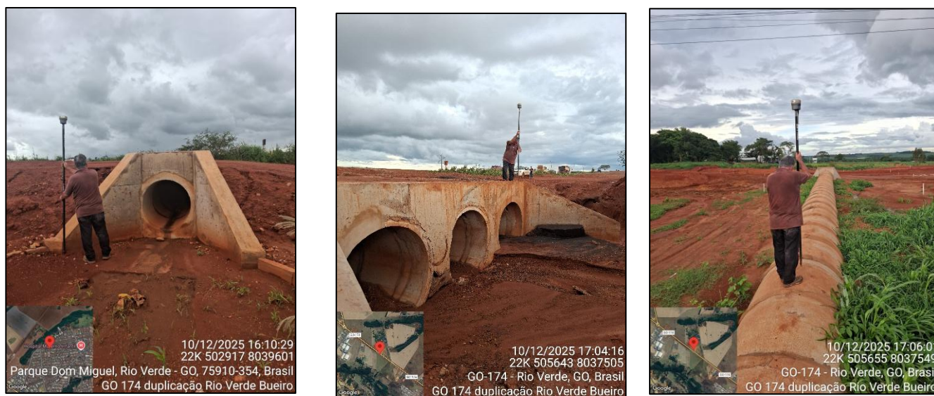
Figura 15 - Mosaico de fotos do cadastro de dispositivos de drenagem
