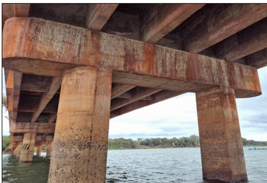
Figura 121 – Travessa existente diverge do memorial de cálculo original
