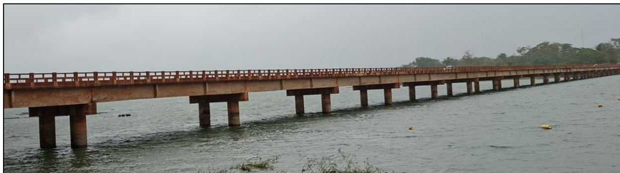
Figura 122 – Travessa existente diverge do memorial de cálculo original
