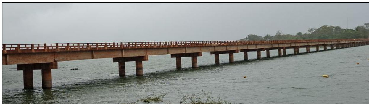
Figura 125 – Pilares existentes divergem do memorial de cálculo original
