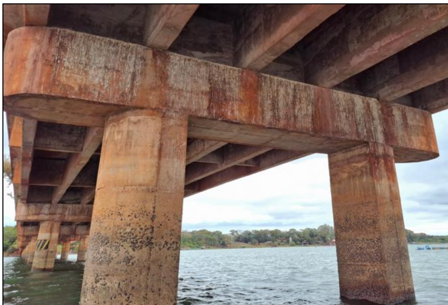
Figura 88 – Pilar existente diverge do memorial de cálculo original
