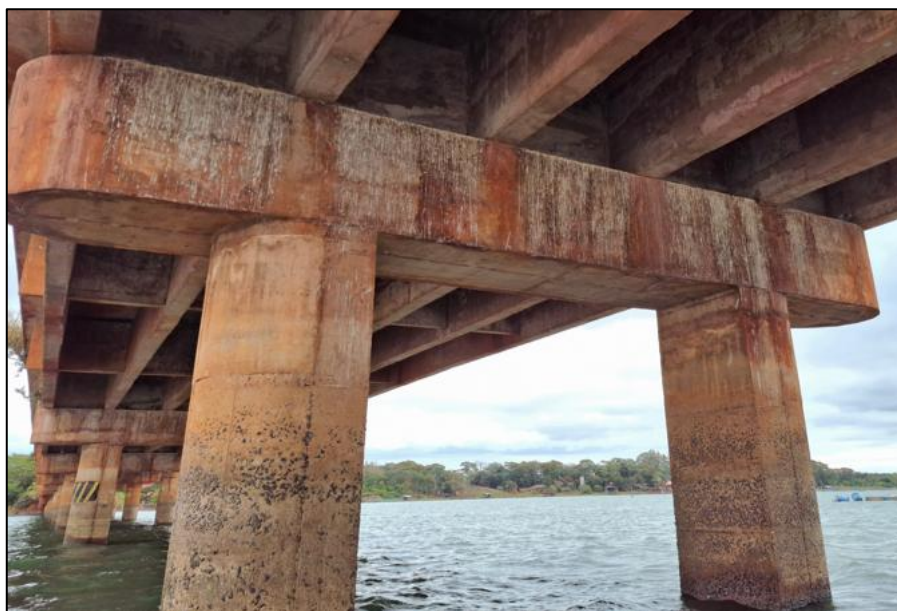
Figura 81 – Travessa existente diverge do memorial de cálculo original 1/2
