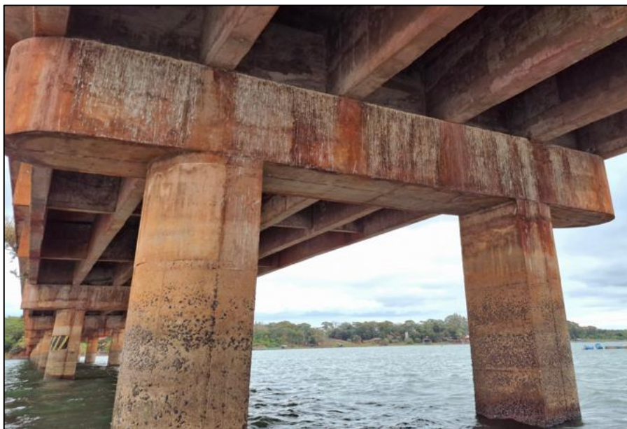
Figura 124 – Pilares existentes divergem do memorial de cálculo original
