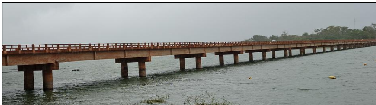
Figura 89 – Pilar existente diverge do memorial de cálculo original
