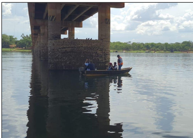
Figura 91 – Imagem de novembro de 2023, em que é possível identificar parede de travamento- Fonte: Relatório de vistoria
