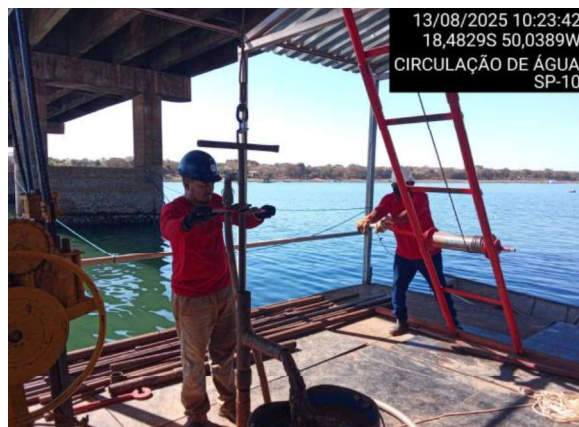
CIRCULAÇÃO DE ÁGUA
