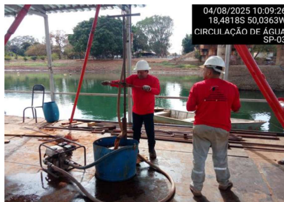
CIRCULAÇÃO DE ÁGUA
