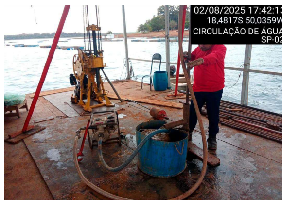
CIRCULAÇÃO DE ÁGUA
