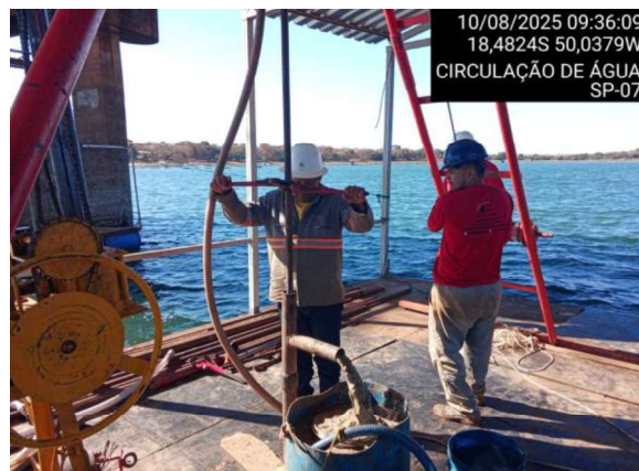
CIRCULAÇÃO DE ÁGUA
