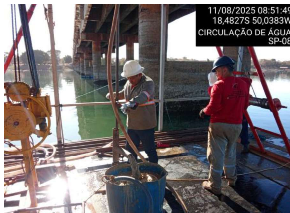
CIRCULAÇÃO DE ÁGUA
