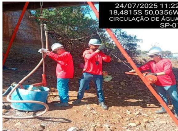
CIRCULAÇÃO DE ÁGUA
