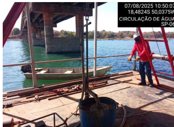
CIRCULAÇÃO DE ÁGUA
