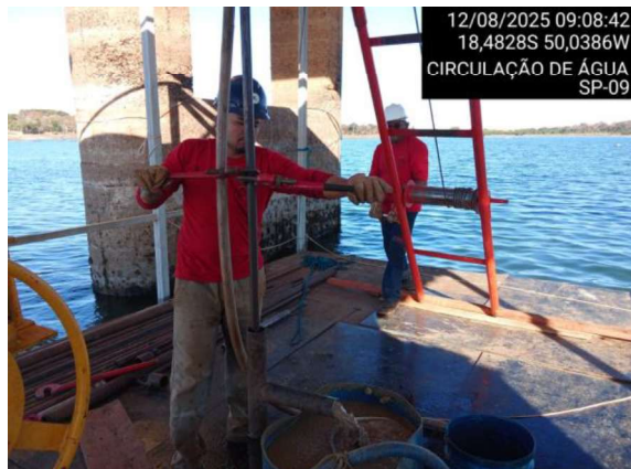
CIRCULAÇÃO DE ÁGUA
