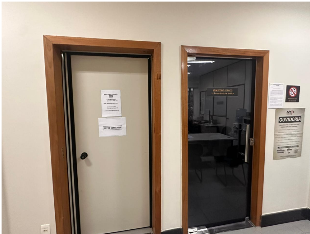
Figura 4: Porta de vidro a ser substituída – Sede das Procuradorias de Justiça – Padre Bernardo/GO
