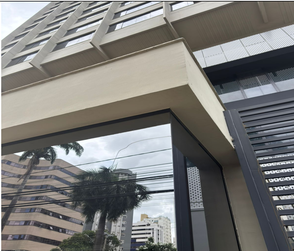
Figura 3: Folha de vidro danificada – Sede das Procuradorias de Justiça – Goiânia/GO
