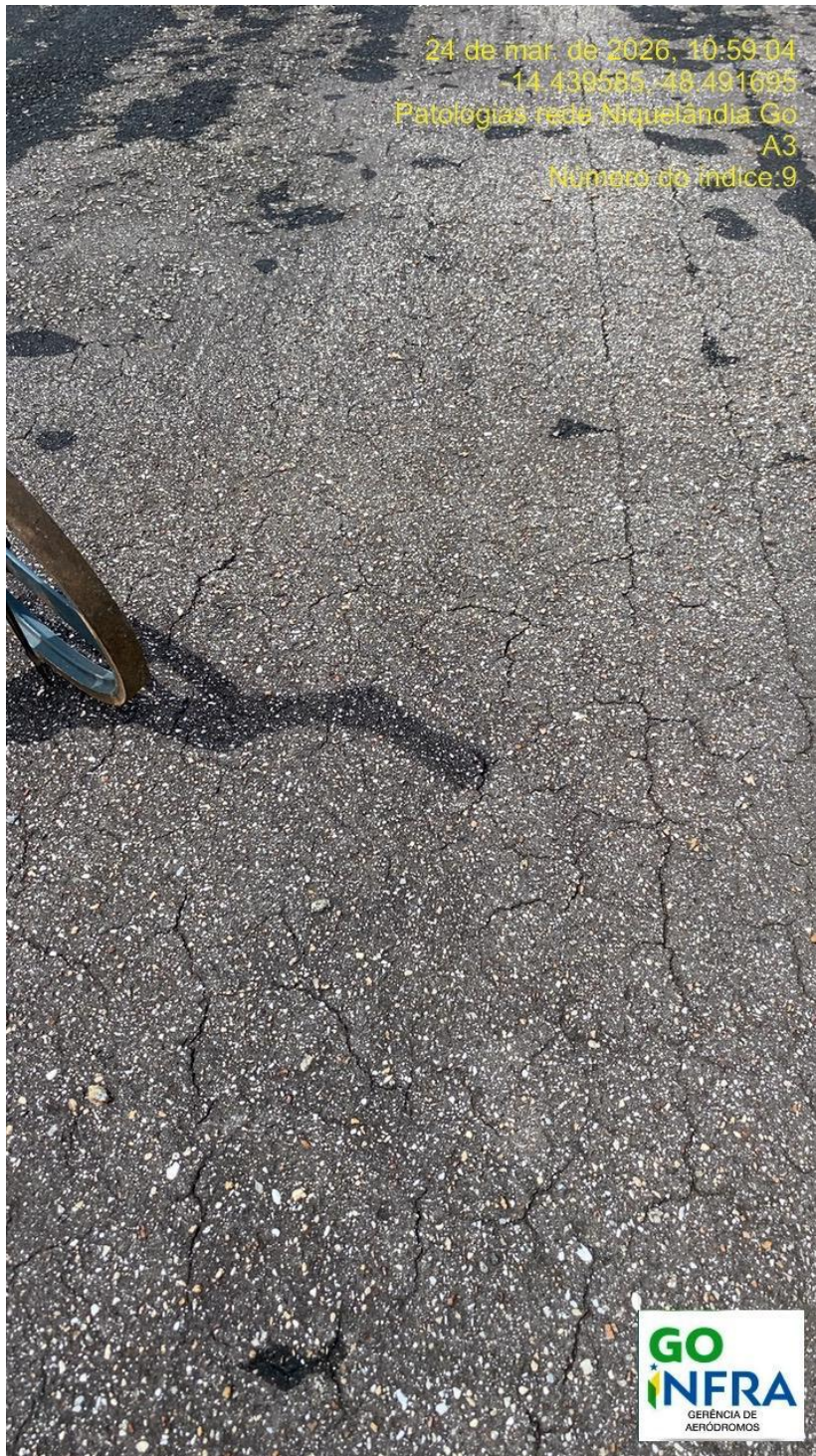
FOTO 1.: TRINCAS EM BLOCO
