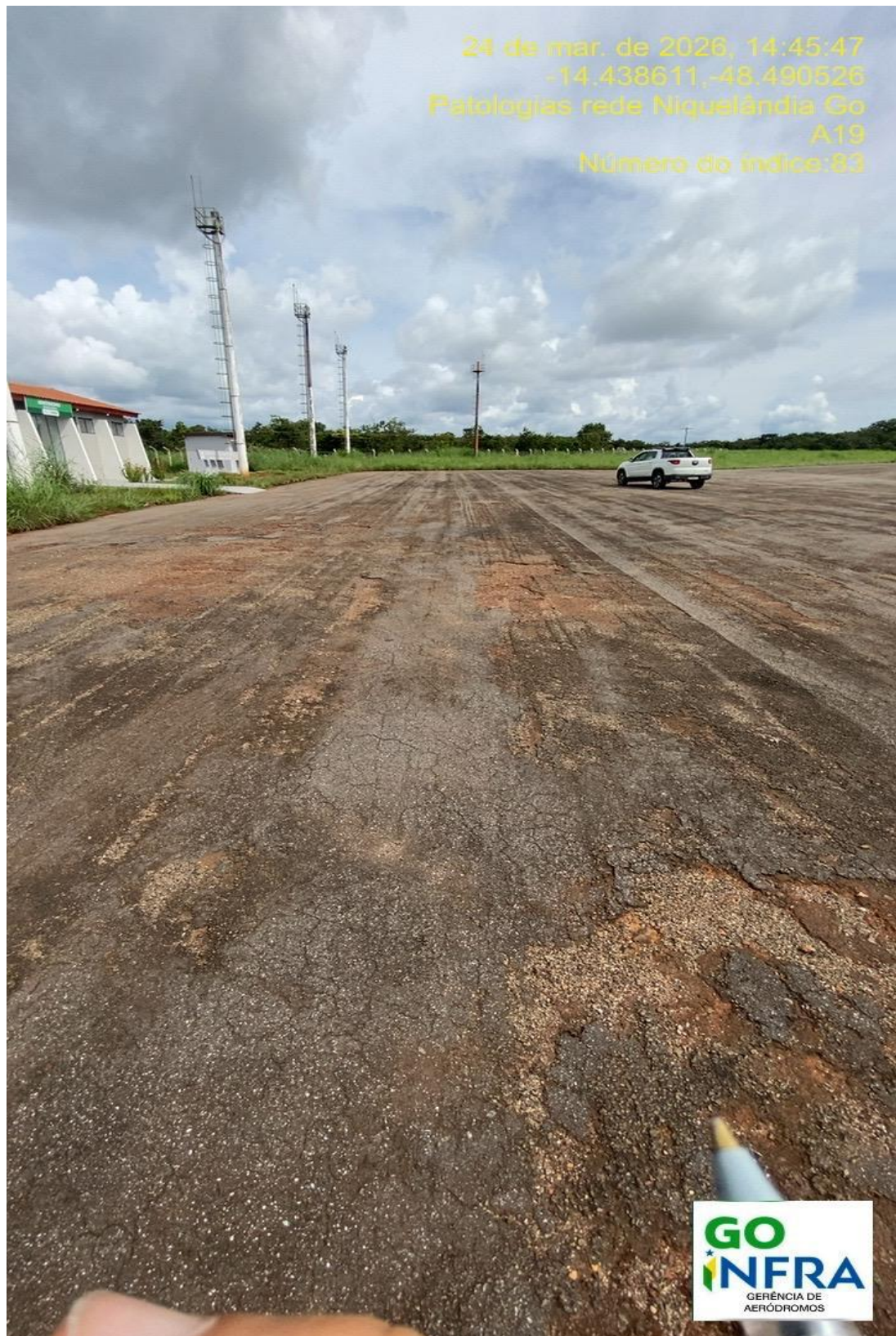
FOTO 4.: Desagregação Alt/ Afundamento (Depress
