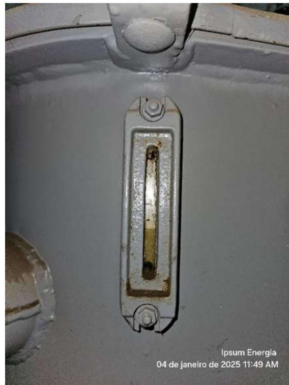
Figura 29-Nível óleo transformador 225KVA
