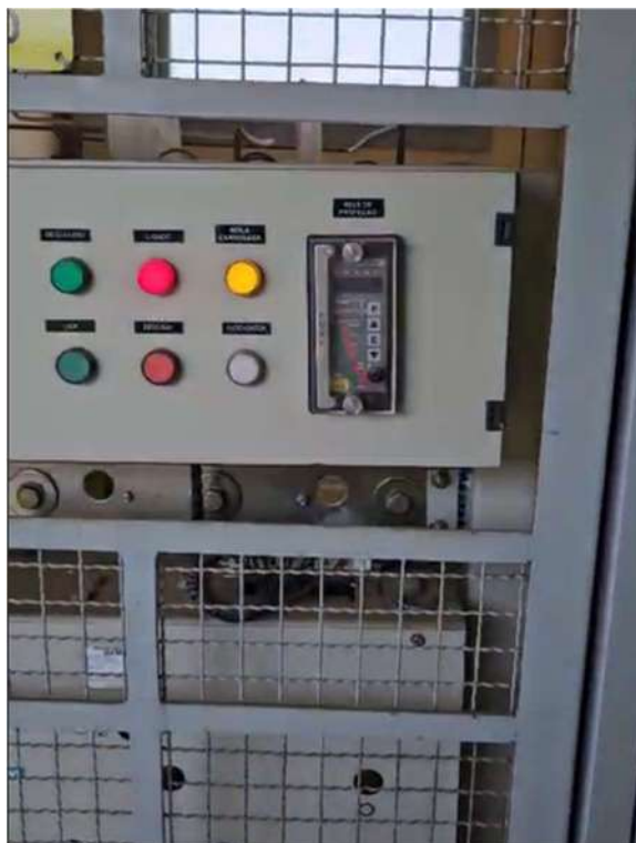
Figura 5-Relé de proteção queimado
