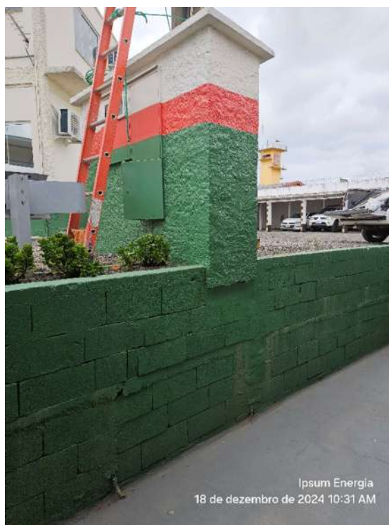
Figura 16-Lateral da mureta - sem caixa de inspeção de aterramento
