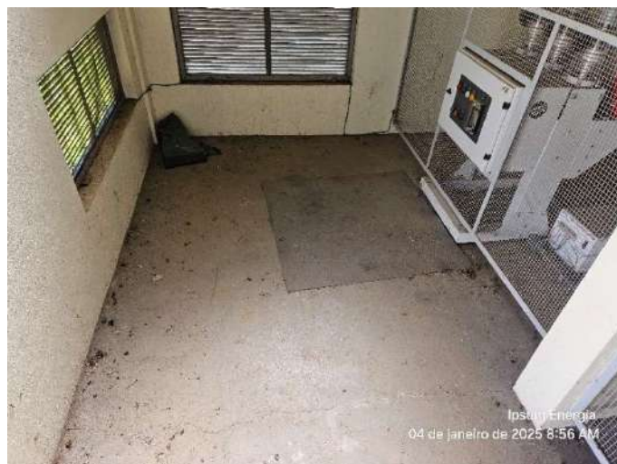
Figura 7-Frente do Cubículo de Proteção
