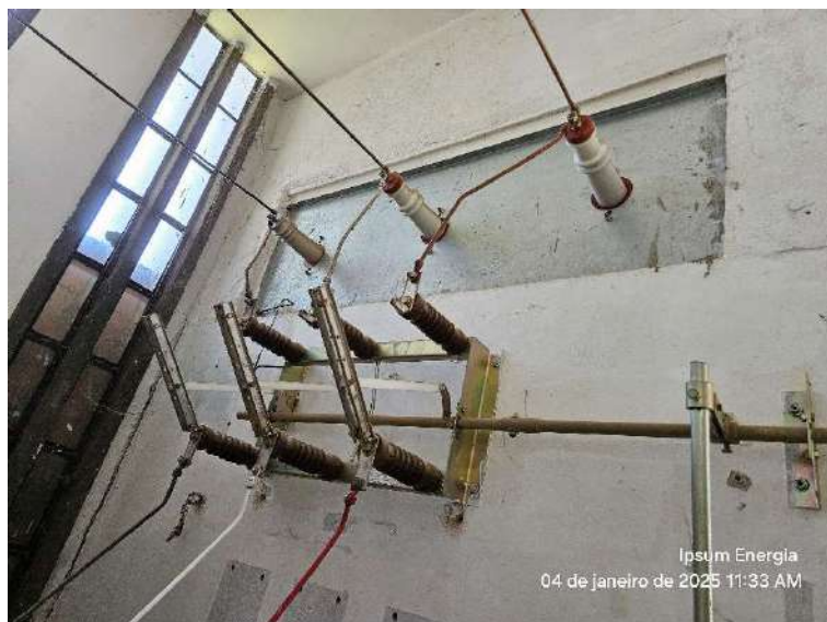
Figura 25-Seccionadora do Transformador de 150KVA
