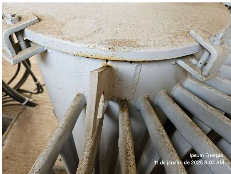
Figura 21-Vazamento de óleo transformador 500KVA
