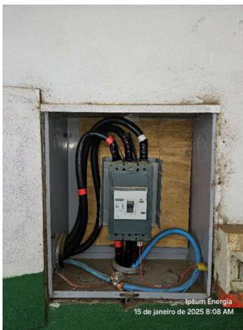
Figura 14-Disjuntor geral da unidade
