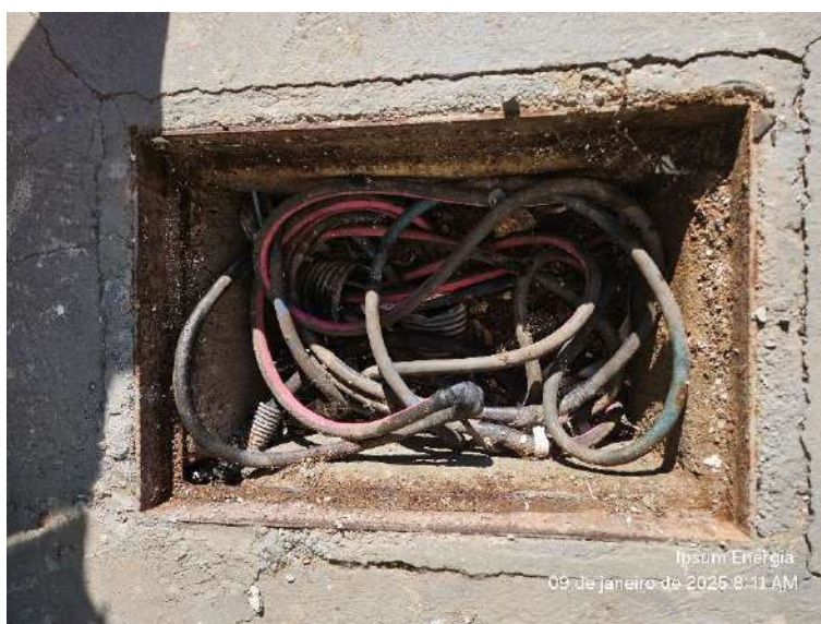
Figura 2-Caixa de passagem de baixa tensão
