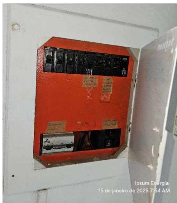
Figura 4-Quadro de distribuição de luz 01 - QDL01
