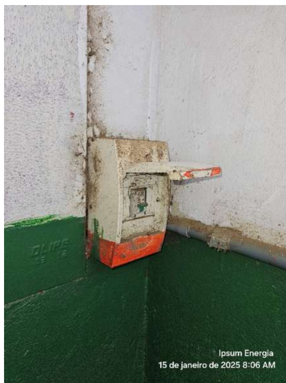
Figura 18-Disjuntor da iluminação antes da manutenção
