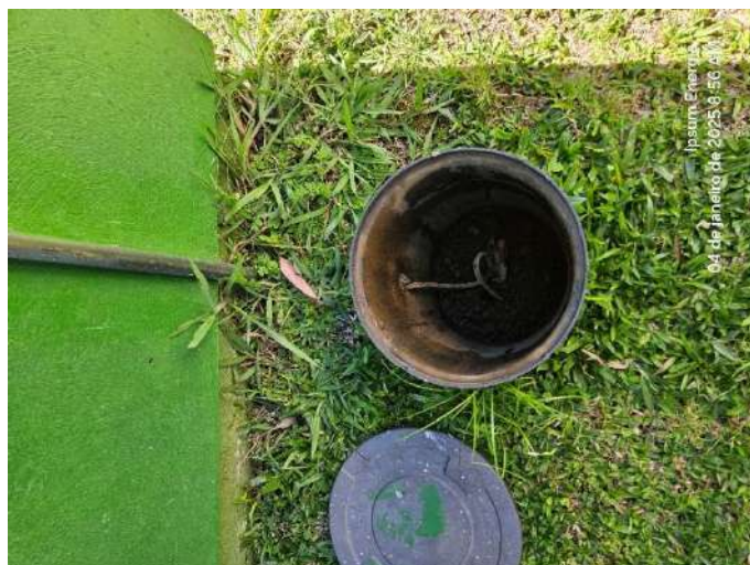
Figura 43-Caixa de inspeção 02 - Conectores oxidados
