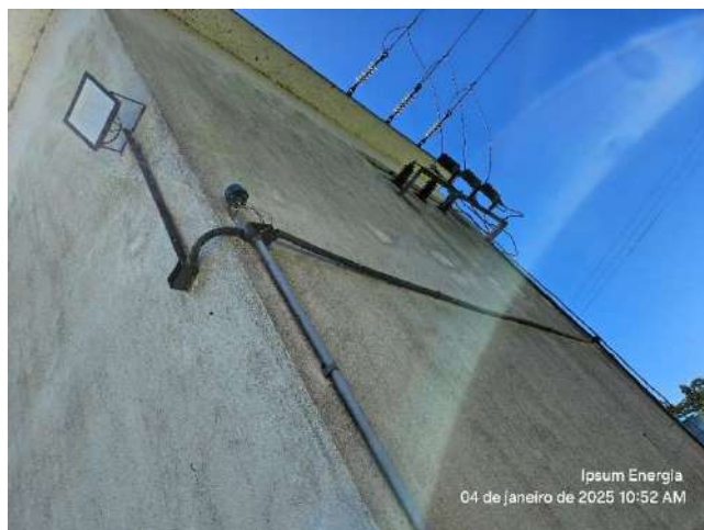
Figura 15-Iluminação externa – próximo a porta de acesso da SE
