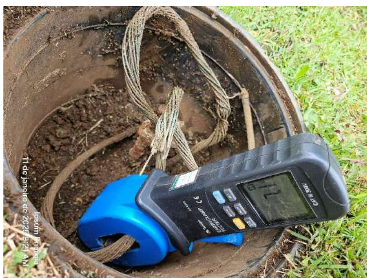
Figura 36-Caixa de inspeção 06 - Resistência de aterramento 7,1 ohms
