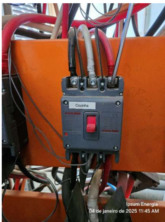
Figura 34-Disjuntor da Cozinha - 175A
