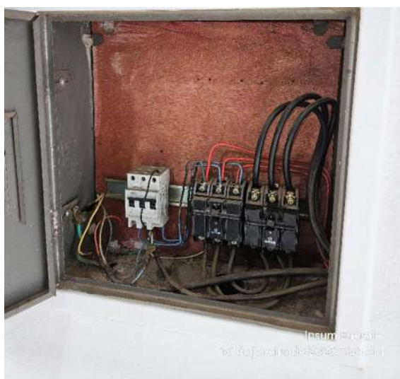
Figura 9-Quadro de distribuição de luz 02 - QDL02
