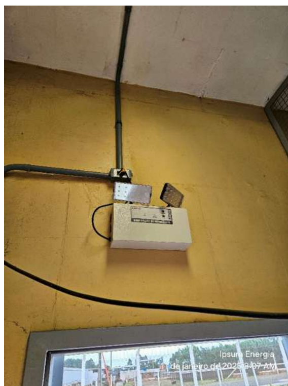
Figura 8-Iluminação de Emergência
