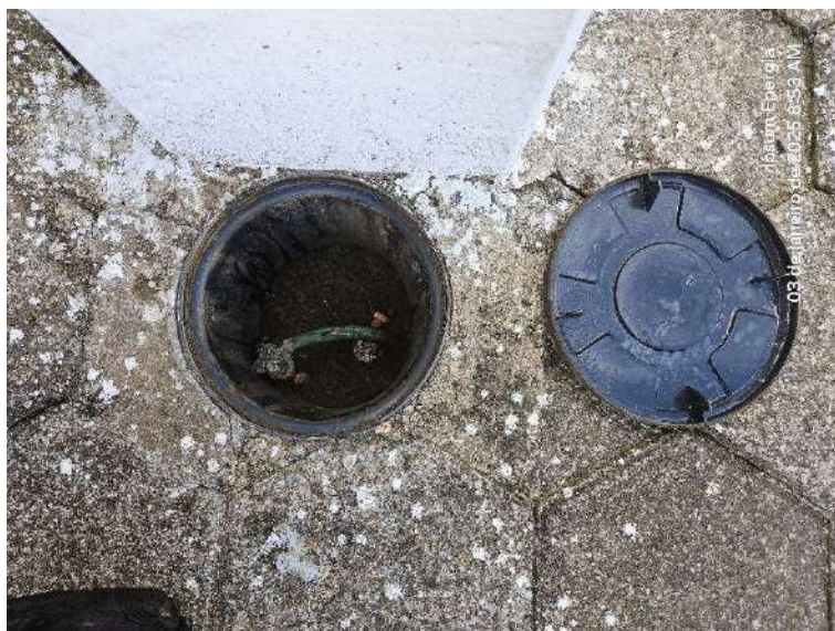
Figura 23-Conectores das hastes oxidados
