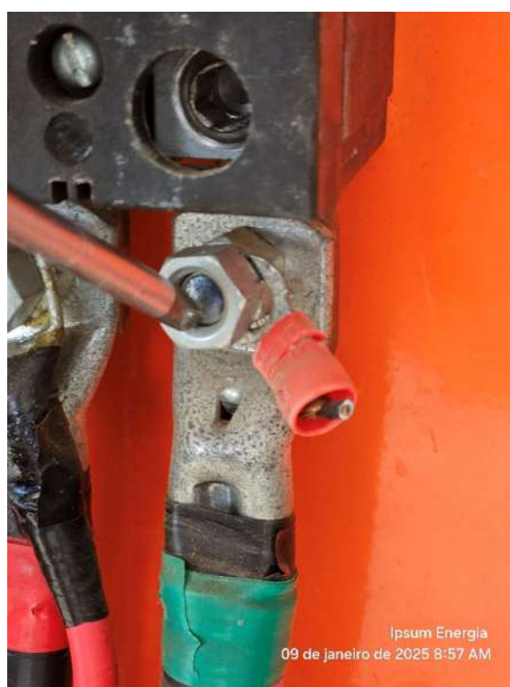
Figura 14-Parafuso inadequado na saída do disjuntor geral
