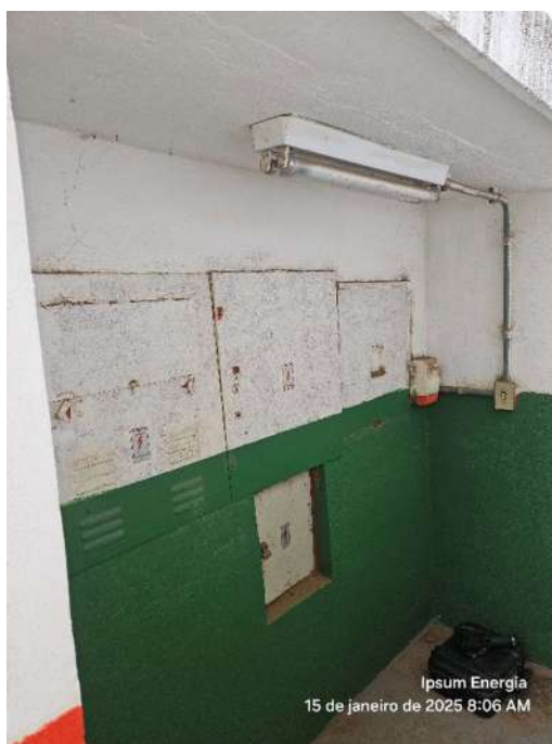
Figura 17-SE antes da manutenção
