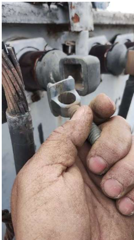
Figura 12-Cabo de potência com sinal de mau contato e oxidação
