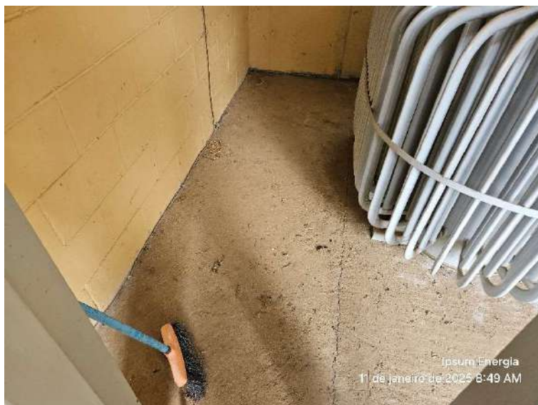
Figura 13-Corredor do cubículo de transformação
