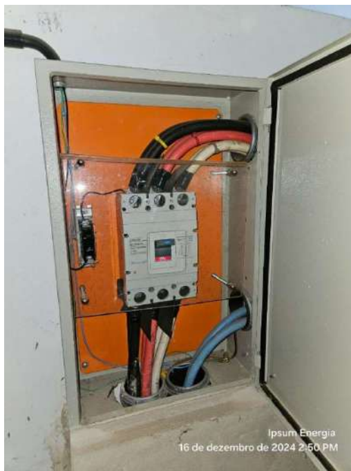
Figura 6-Quadro do Disjuntor Geral
