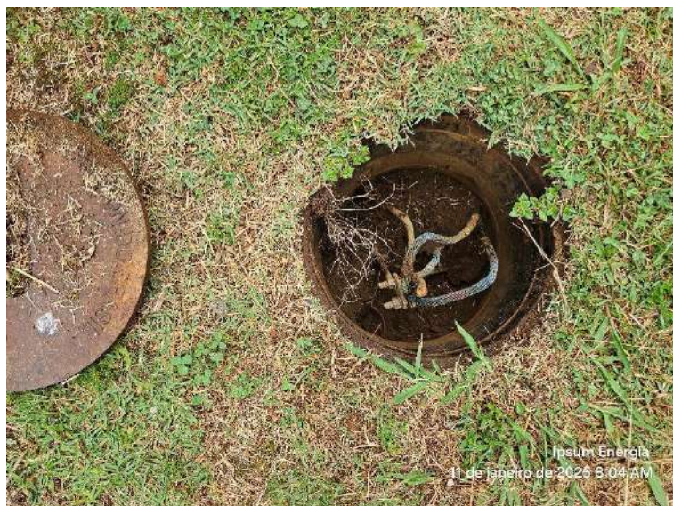
Figura 31-Caixa de inspeção 04 – falta conector
