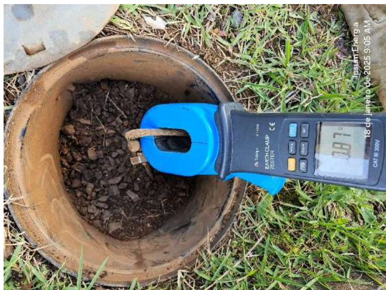
Figura 27-Resistência de aterramento - 0,87 ohms
