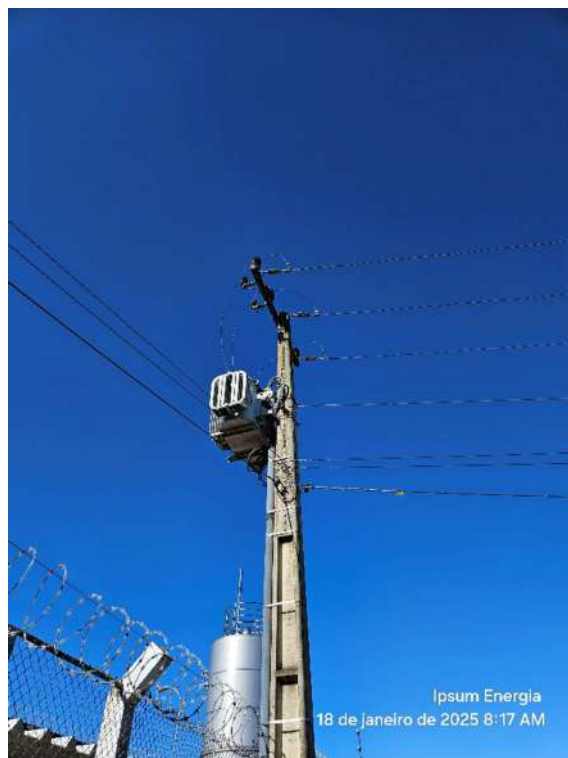
Figura 42-Transformador da unidade - 225KVA
