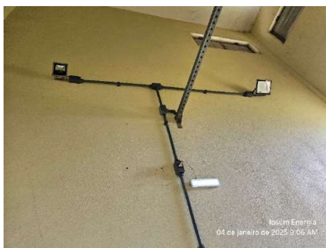
Figura 13-Iluminação artificial e de emergência
