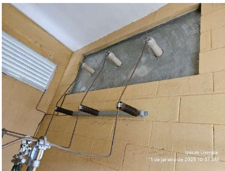
Figura 53-Isoladores cubiculo de entrada
