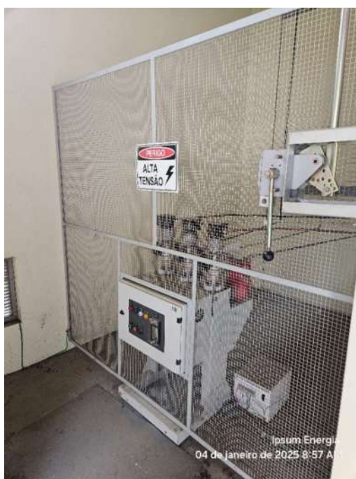
Figura 19-Grade do Cubículo de proteção
