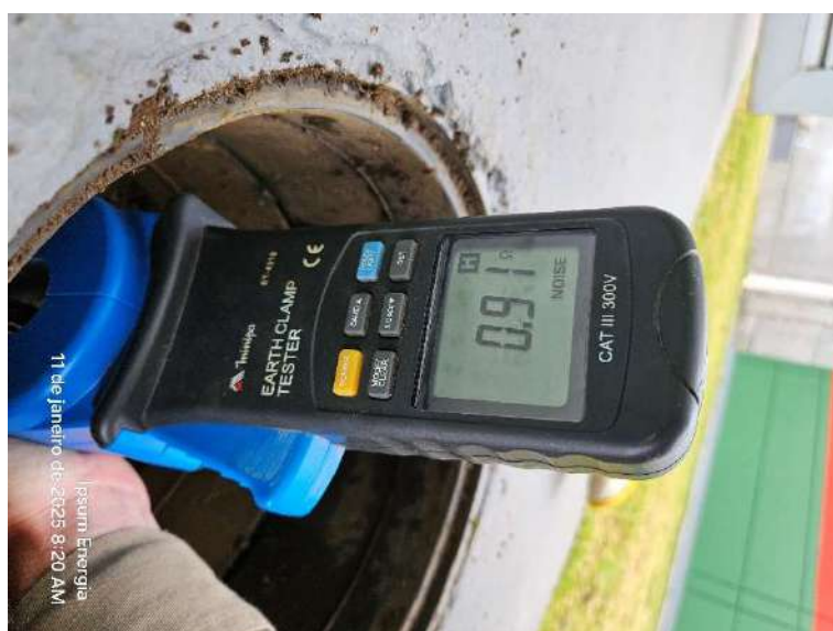
Figura 30-Caixa de inspeção 03 - Resistência de aterramento 0,91 ohms
