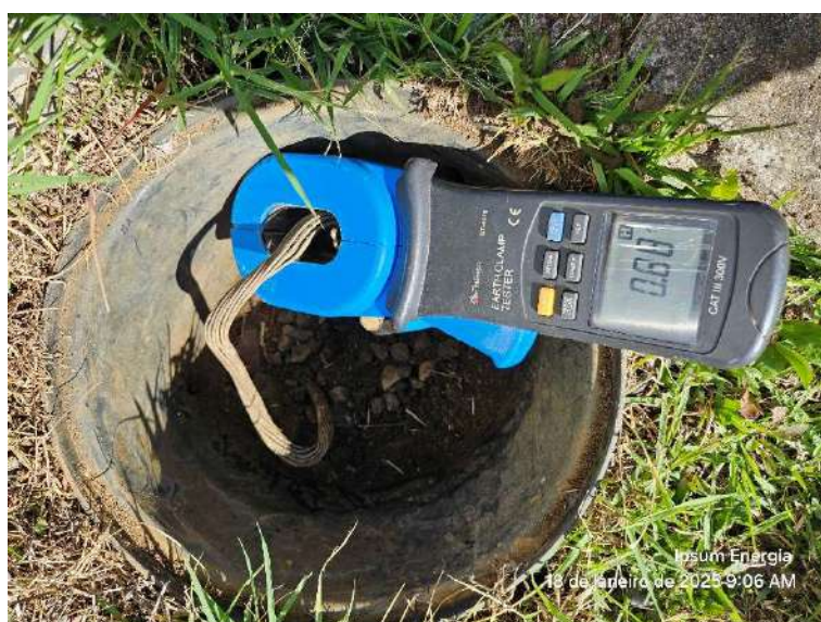
Figura 28-Resistência de aterramento - 0,88 ohms
