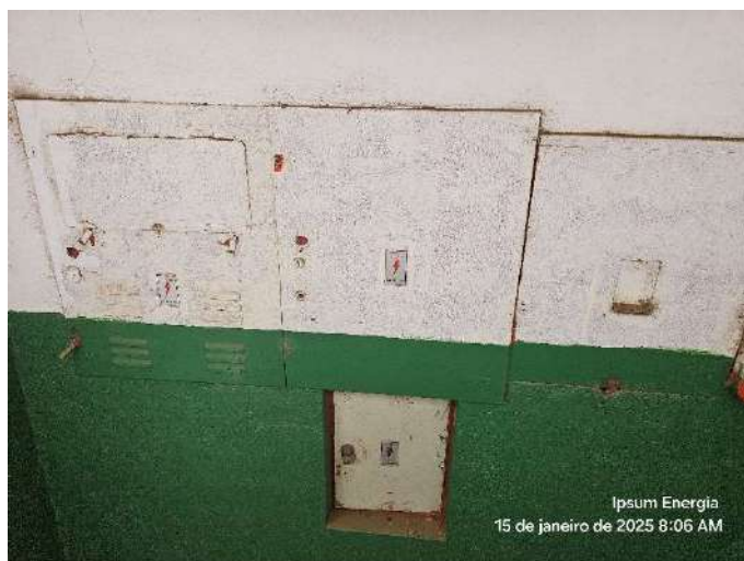
Figura 16-SE antes da manutenção
