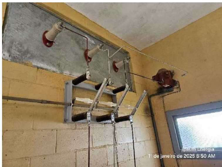
Figura 17-Isoladores, seccionadora e TP
