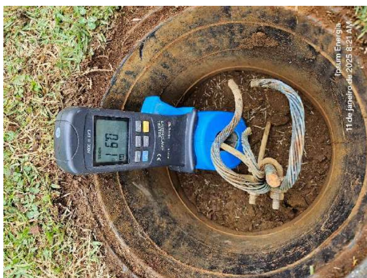
Figura 32-Caixa de inspeção 04 - Resistência de aterramento 0,91 ohms
