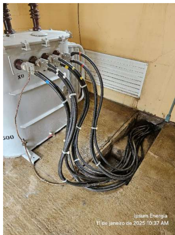
Figura 60-Cabos de baixa tensão
