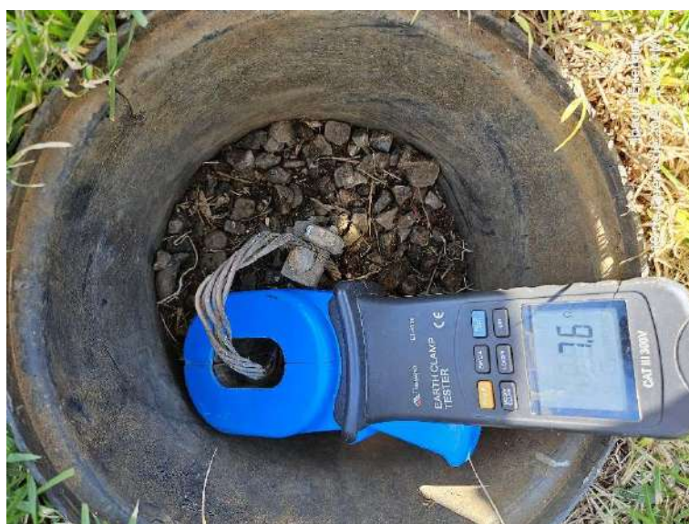
Figura 26-Resistência de aterramento - 7,6 ohms
