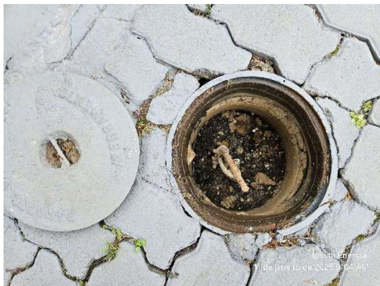
Figura 27-Caixa de inspeção 02 – haste de baixa camada
