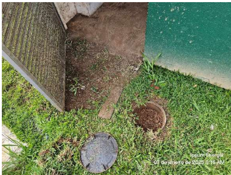
Figura 15-Caixa de inspeção do aterramento
