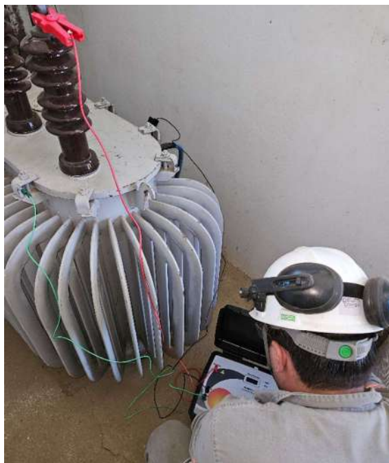
Figura 61-Medição Resistência de isolamento - 150KVA
