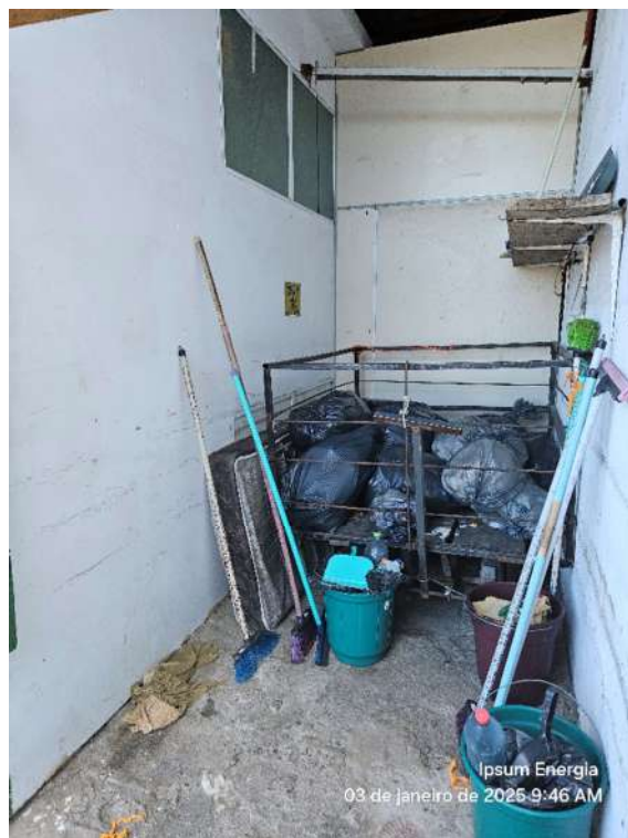
Figura 17-Ventilação parte de trás do cubículo de transformação
