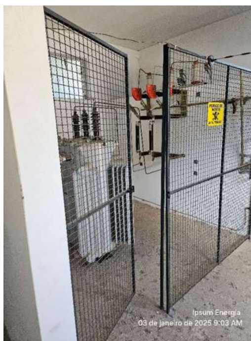
Figura 7-Porta do Cubículo de Transformação - Abrindo para dentro
