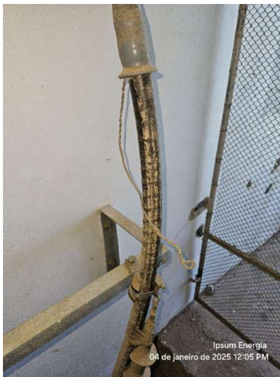
Figura 22-Mufla da fase R - aterramento rompido
