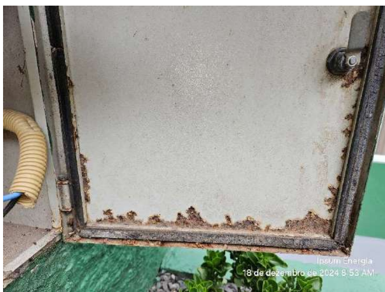
Figura 5-Tampa do QD com corrosão
