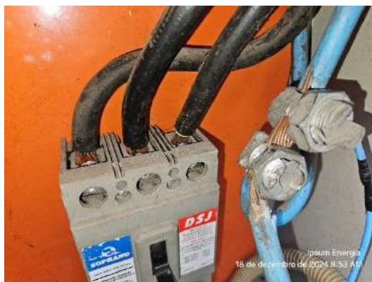
Figura 6-Falta de terminais e identificação - entrada
