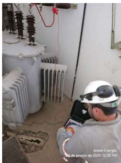
Figura 60-Medição de Resistência de isolamento – 225KVA
