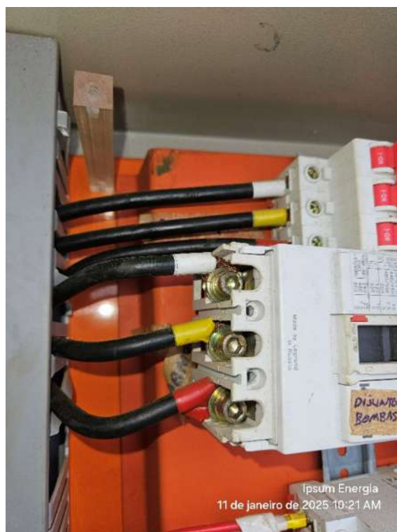
Figura 24-Disjuntor das bombas no QGBT - Saída
