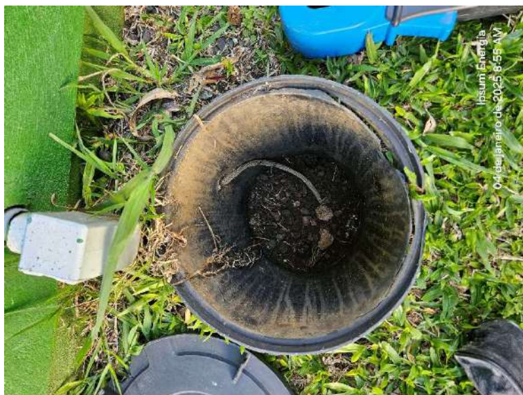
Figura 41-Caixa de inspeção 01 – balde quebrado
