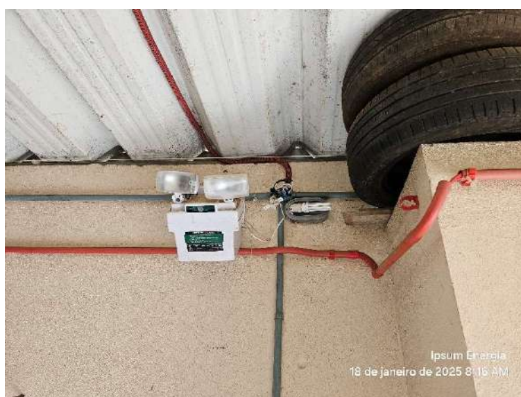
Figura 11-Iluminação de emergência e tomadas
