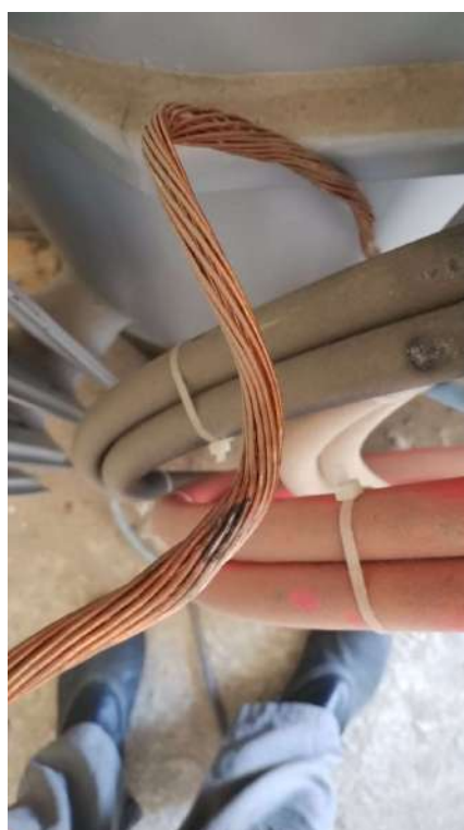
Figura 20-Conexão do cabo do aterramento ao transformador estava com mau contato - lixado e reapertado
