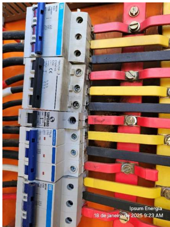
Figura 5-DJ monofásico com conexão frouxa
