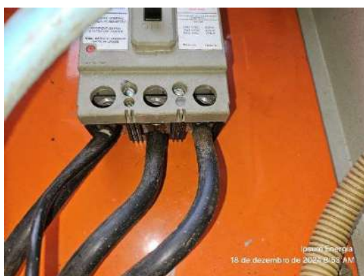
Figura 7-Falta de terminais e identificação – saída
