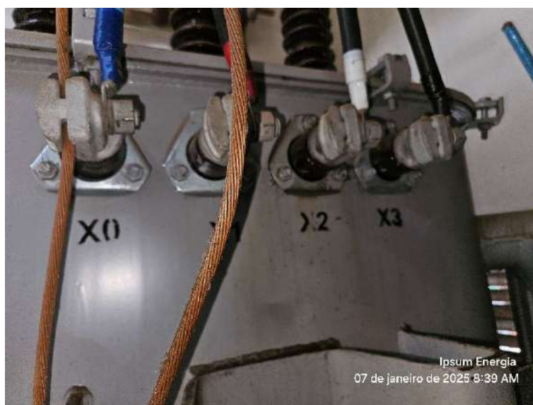
Figura 13-Vazamento de óleo na baixa tensão do Transformador
