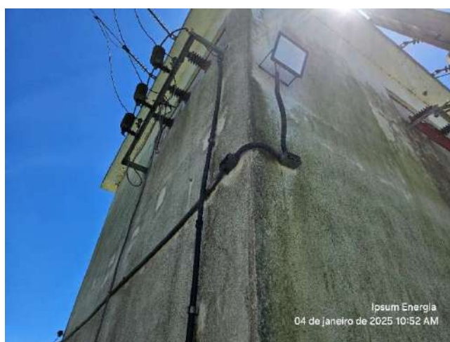
Figura 16-Iluminação externa - parte de trás da SE
