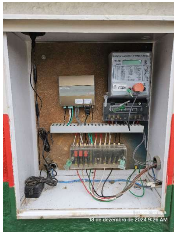
Figura 38-Quadro Medição após manutenção
