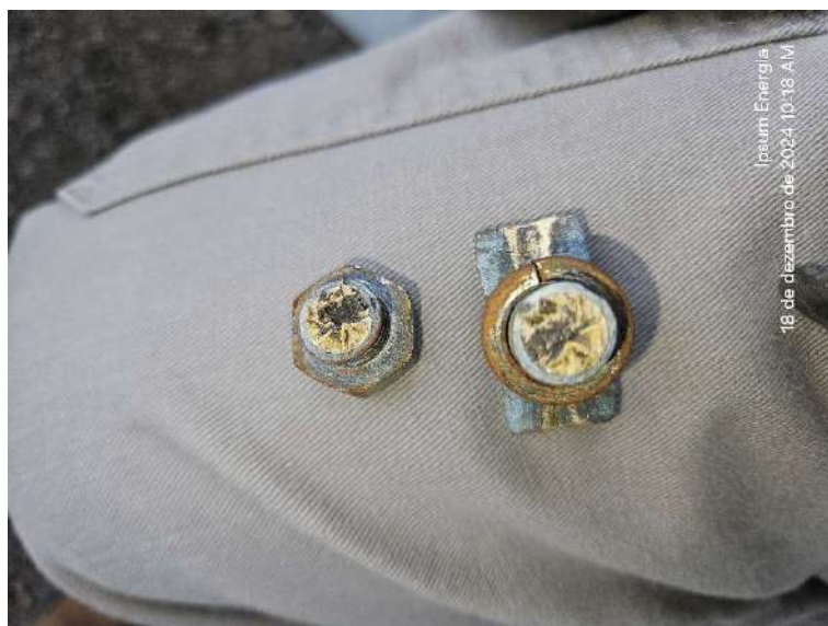
Figura 13-Conector do transformador - falha de fabricação
