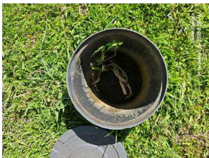
Figura 45-Caixa de inspeção 03 = balde quebrado e conector inadequado
