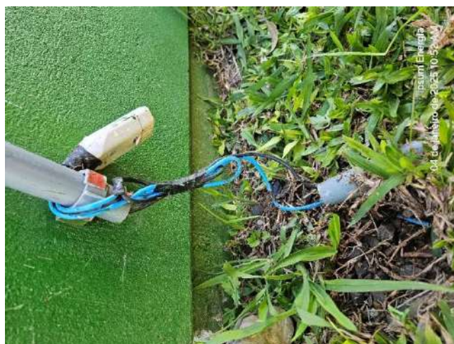
Figura 14-Cabos da iluminação externa
