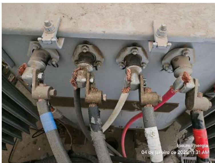
Figura 32-Secundário Transformador 225KVA
