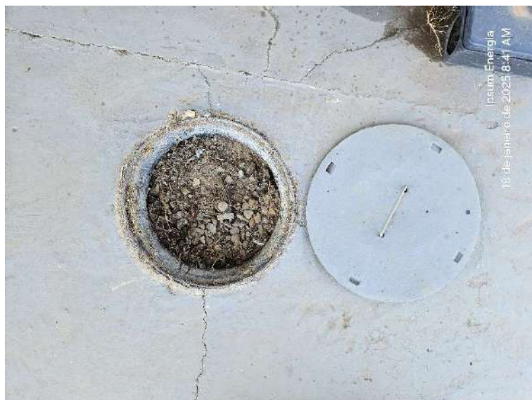
Figura 25-Caixa de inspeção do aterramento 09
