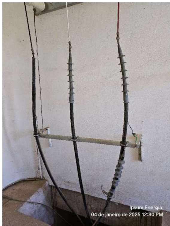
Figura 69-Muflas entrada SE Transformação
