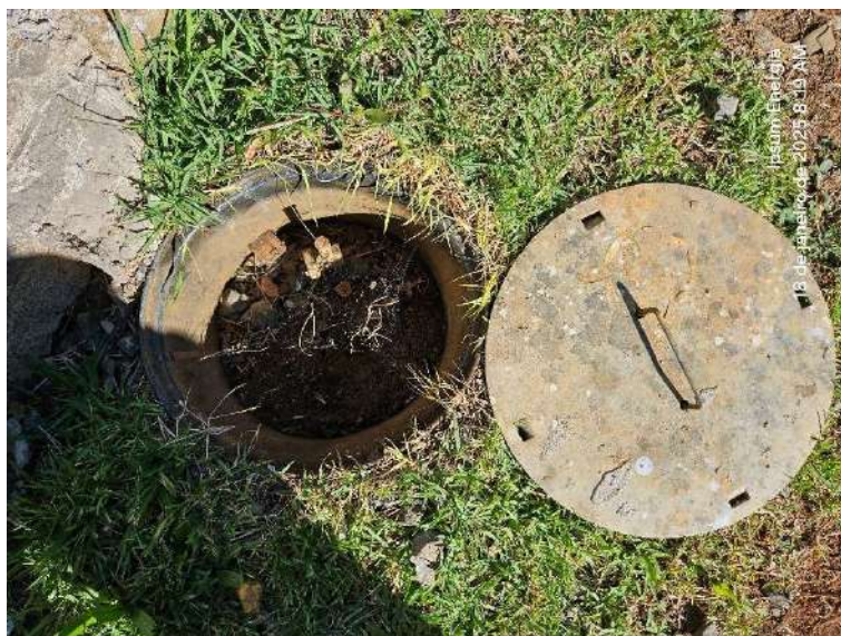
Figura 19-Caixa de inspeção do aterramento 03
