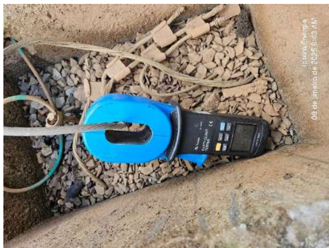
Figura 17-Caixa de inspeção – Resistência de aterramento 2,5 ohms
