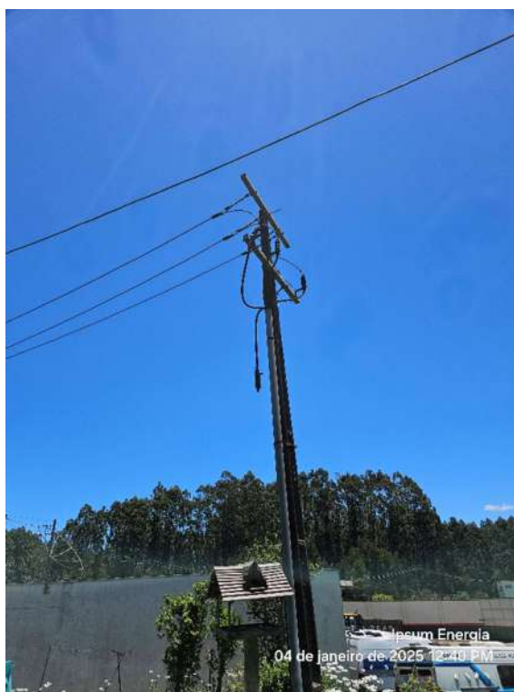
Figura 20-Poste da entrada da SE de Transformação
