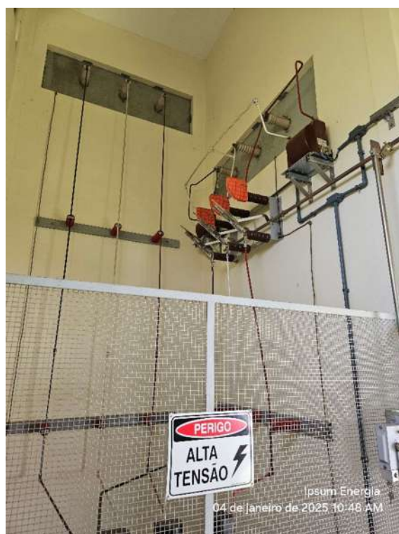
Figura 64-Seccionadora após limpeza e reapertos
