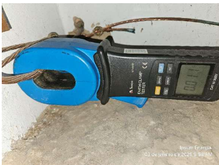
Figura 24-Resistência da malha de aterramento
