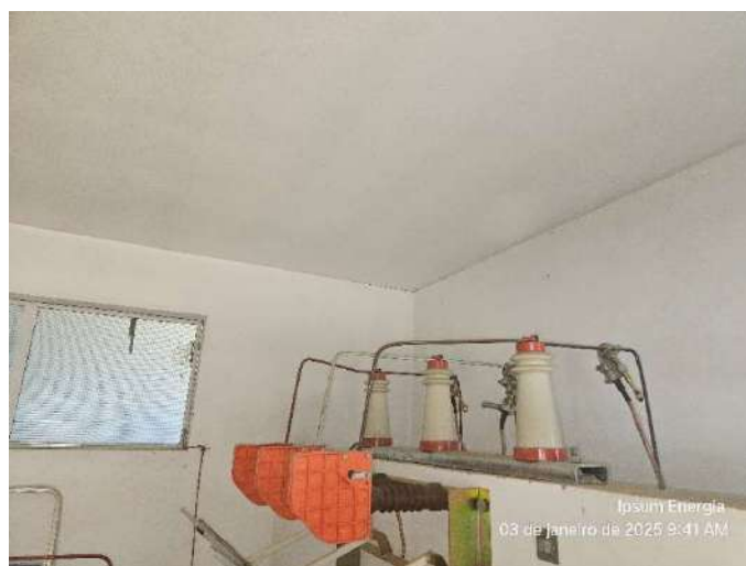
Figura 13-Rachadura na laje - Entrada de média tensão
