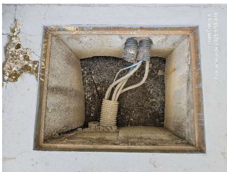
Figura 22-Caixa de passagem de entrada da SE
