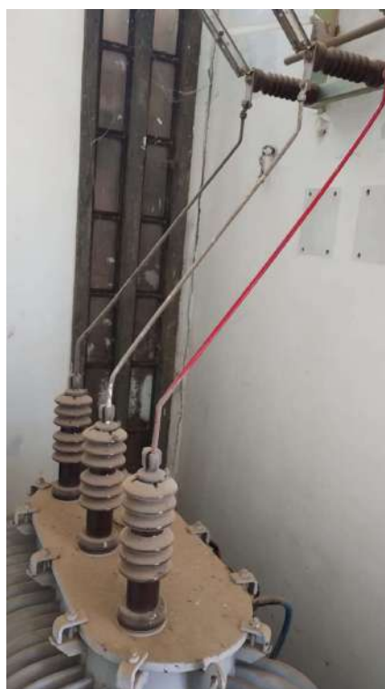
Figura 26-Transformador 150KVA - Antes manutenção
