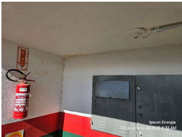
Figura 5-Extintor, infiltração na laje e iluminação
