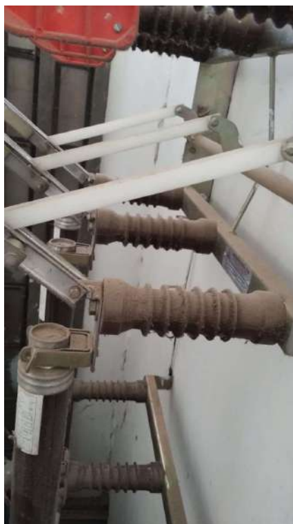
Figura 31-Seccionadora do Transformador de 225KVA
