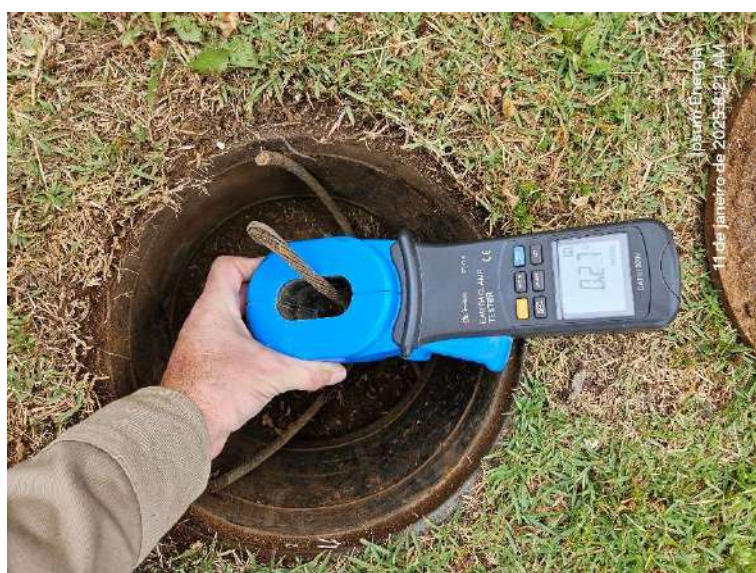
Figura 34-Caixa de inspeção 05 - Resistência de aterramento 0,27 ohms
