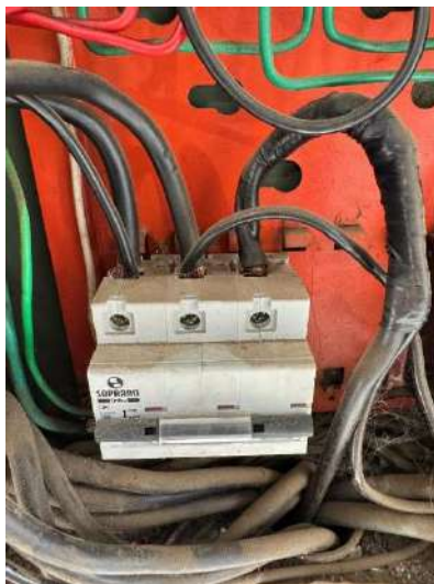
Figura 7-QDL01 sem terminais adequados
