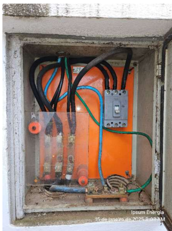
Figura 13-Quadro de distribuição sem carga - desativado
