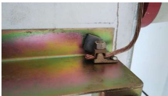
Figura 3-Aterramento Chave Seccionadora solto
