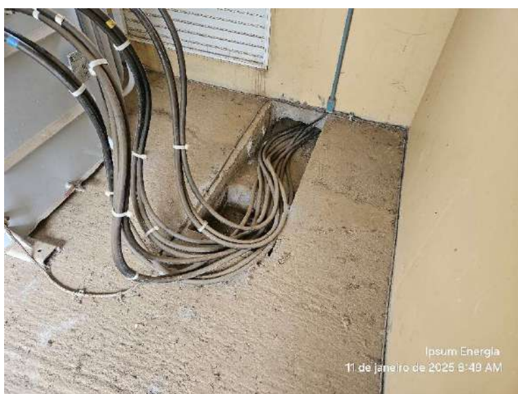
Figura 14-Cabos de baixa tensão do transformador
