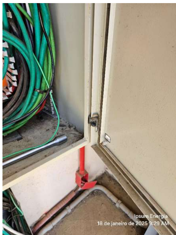
Figura 8-Porta do QGBT sem aterramento
