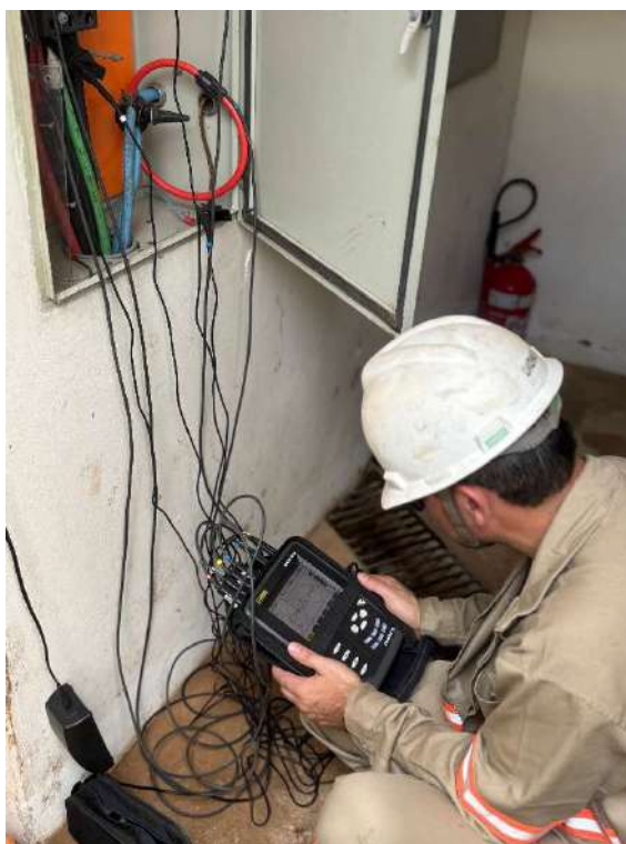
Figura 26-AQEE no Disjuntor Geral da unidade
