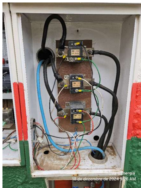
Figura 39-Quadro dos TC's após manutenção
