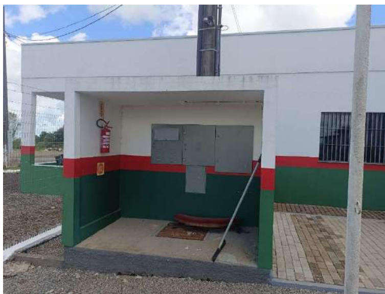
Figura 1-Visão frontal da SE da unidade
