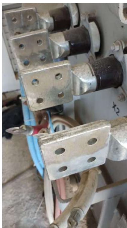
Figura 41-Conexões do transformador lixadas
