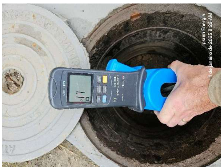
Figura 38-Caixa de inspeção 07 - Resistência de aterramento 1,1 ohms
