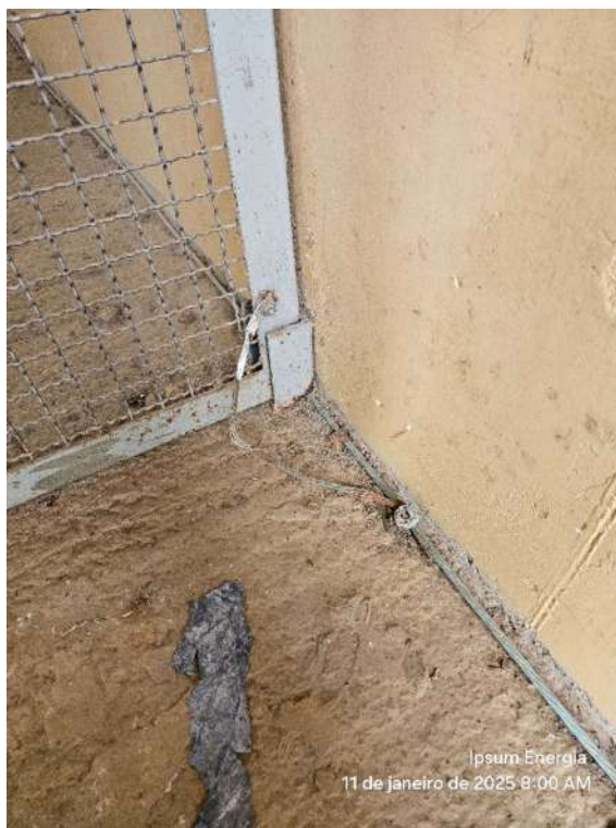
Figura 11-Cabo aterramento grade cubiculo transformação
