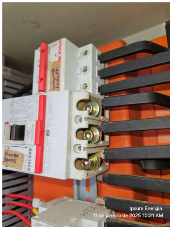
Figura 23-Disjuntor das bombas no QGBT - Entrada
