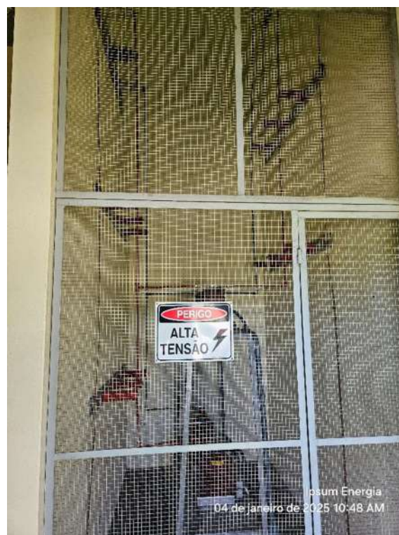
Figura 66-Frente do cubículo de Medição após limpeza
