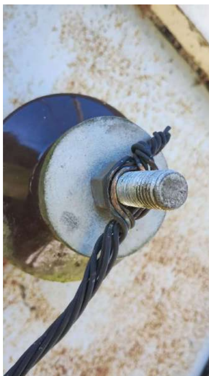
Figura 3-Bucha de passagem sem terminais e arruelas – crítico
