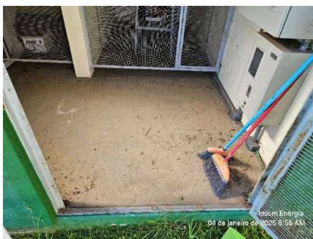
Figura 6-Entrada da SE de Proteção e Medição da unidade
