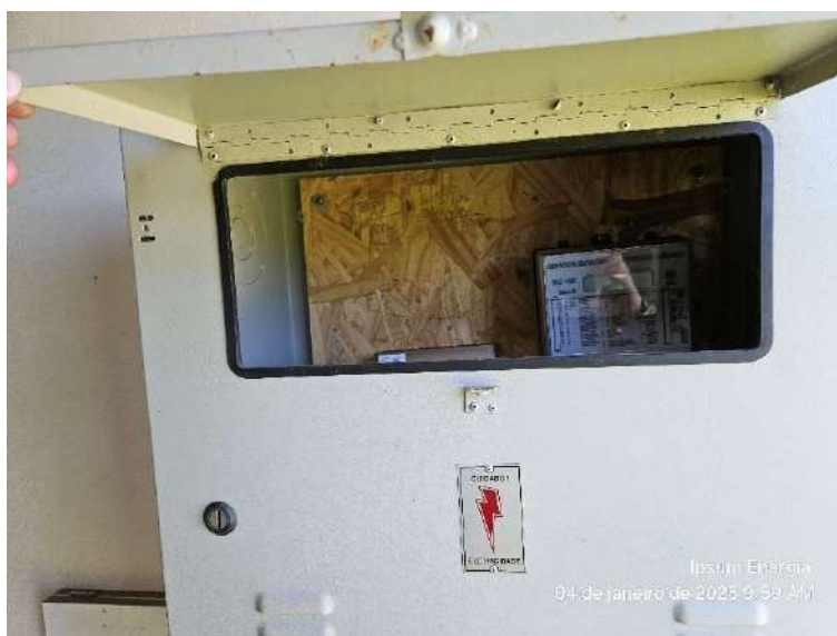
Figura 11-Quadro da Medição Celesc - sem vidro
