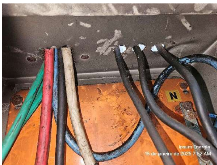
Figura 2-Parte superior do quadro de barramentos sem vedação adequada
