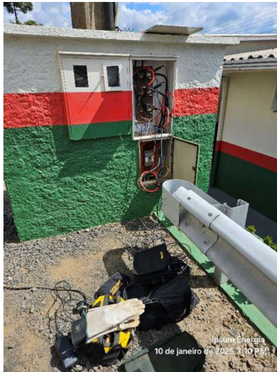
Figura 17-Frente da mureta - sem caixa de inspeção de aterramento
