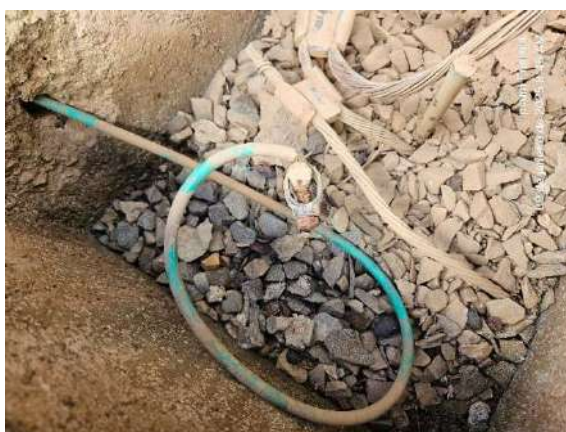
Figura 16-Caixa de inspeção de aterramento
