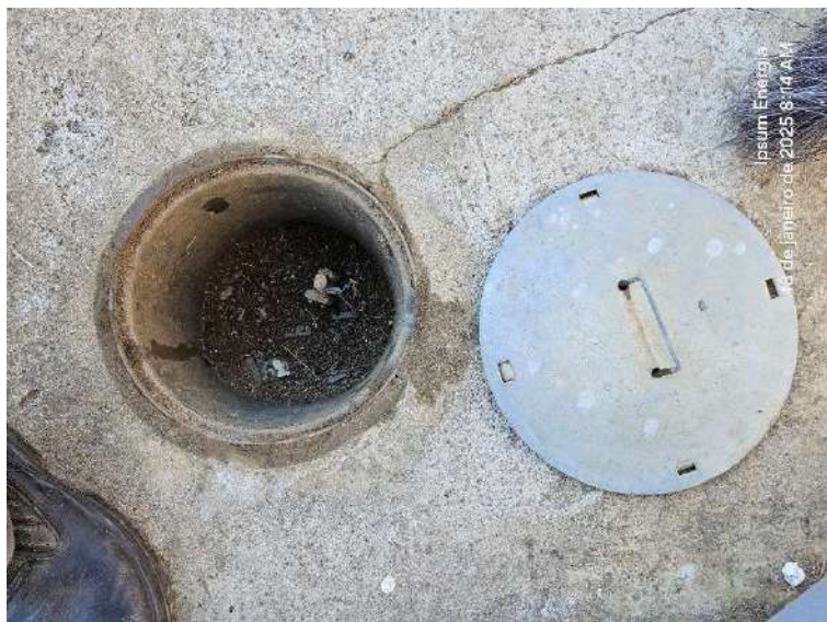
Figura 17-Caixa de inspeção do aterramento 01
