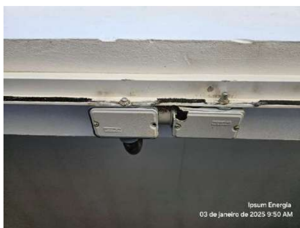
Figura 10-Fins de curso da iluminação - danificados
