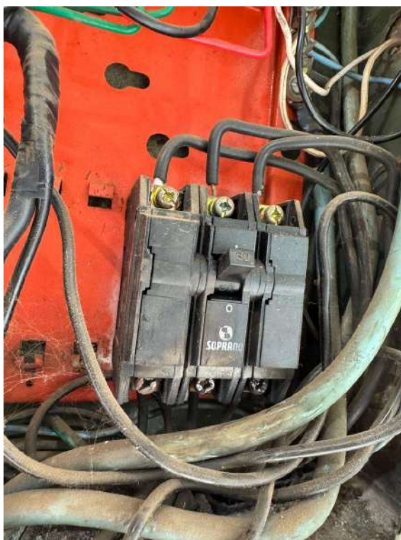
Figura 6-QDL01 - sem terminais adequados
