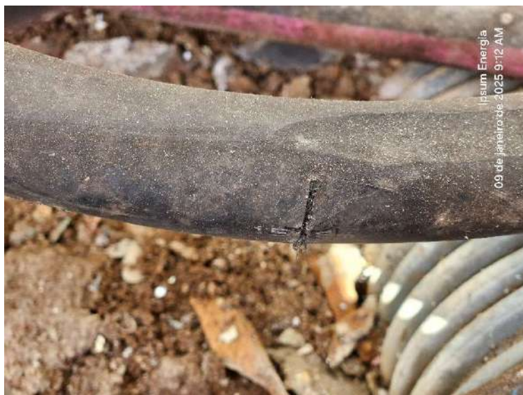
Figura 8-Cabo de baixa tensão com isolamento danificado
