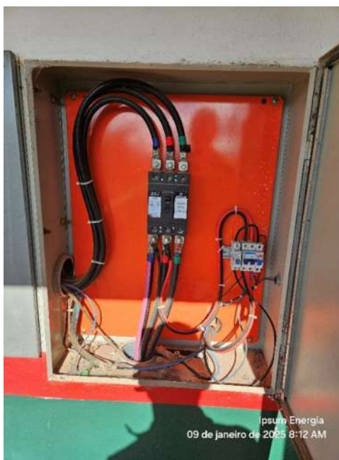
Figura 3-Disjuntor geral da unidade – 225A
