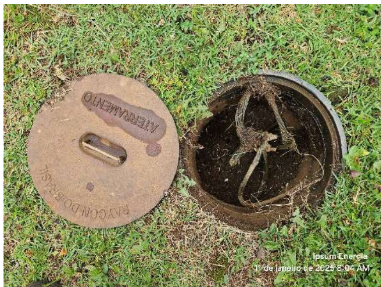
Figura 35-Caixa de inspeção 06 – haste de baixa camada e falta conector
