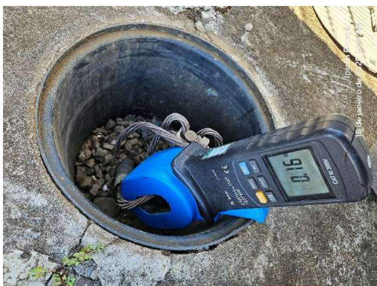
Figura 30-Resistência de aterramento - 0,16 ohms
