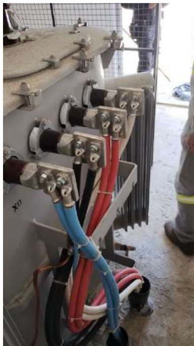
Figura 42-Conexões do transformador limadas e reconectadas
