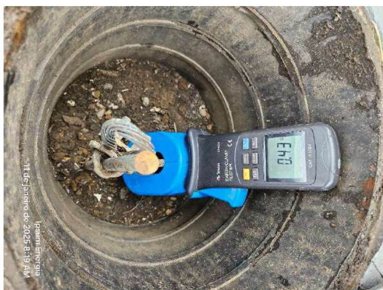
Figura 28-Caixa de inspeção 02 - Resistência de aterramento 0,43 ohms
