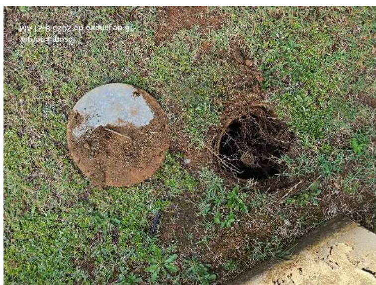
Figura 22-Caixa de inspeção do aterramento 06
