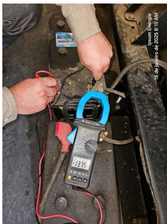
Figura 16-Tensão das baterias do Gerador
