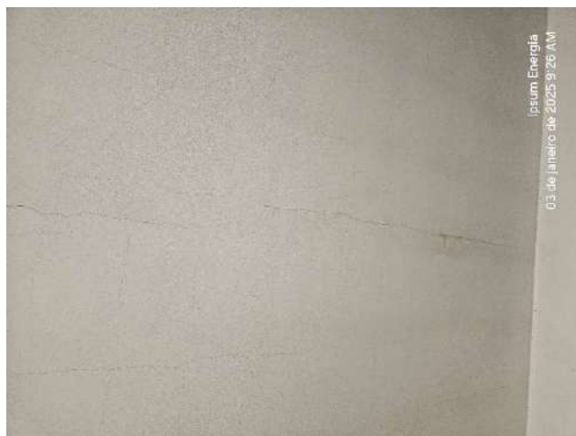
Figura 11-Trincas na laje – Centro da Subestação – parte 1
