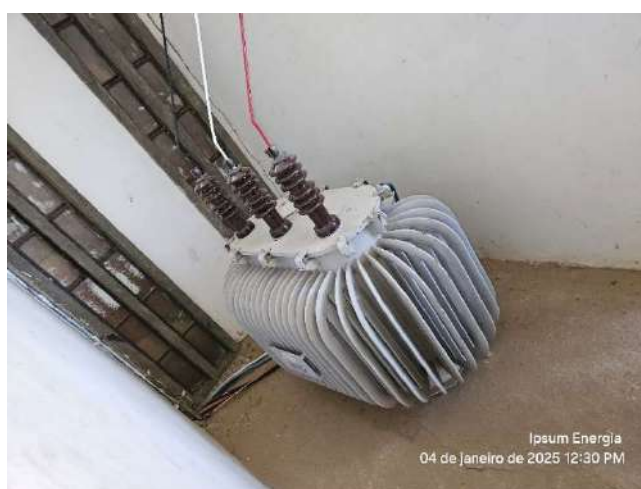
Figura 72-Transformador 150KVA - após manutenção
