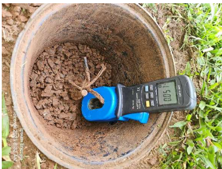
Figura 16-Caixa de inspeção – Resistência de aterramento 0,051 ohms
