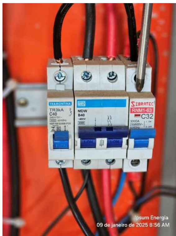
Figura 11-Disjuntores de baixa tensão
