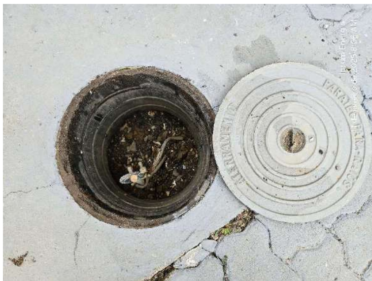
Figura 39-Caixa de inspeção 08 - Gerador
