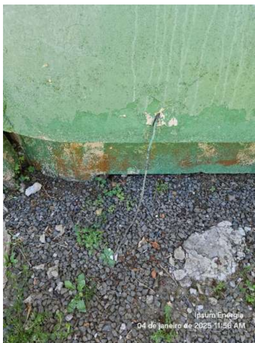
Figura 47-Aterramento SE de Transformação
