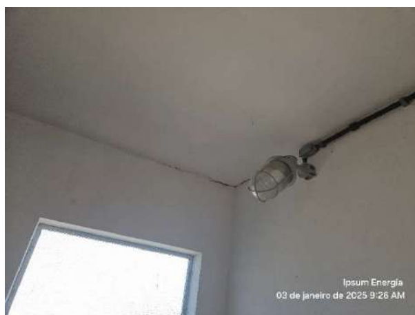
Figura 9-Iluminação artificial e rachadura na laje
