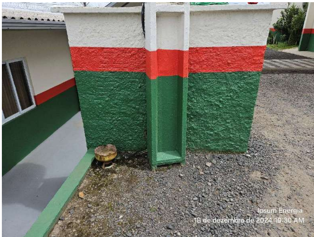
Figura 15-Parte de trás da mureta - sem caixa de inspeção de aterramento
