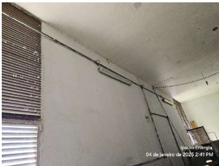
Figura 33-Iluminação artificial e de emergência da SE de Transformação
