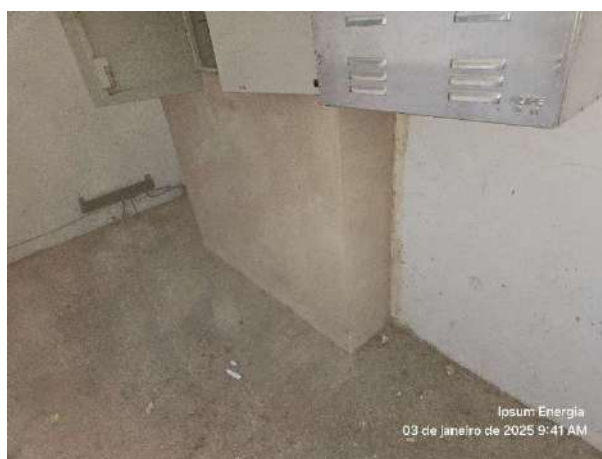
Figura 16-Cor da mureta interna fora do padrão Celesc
