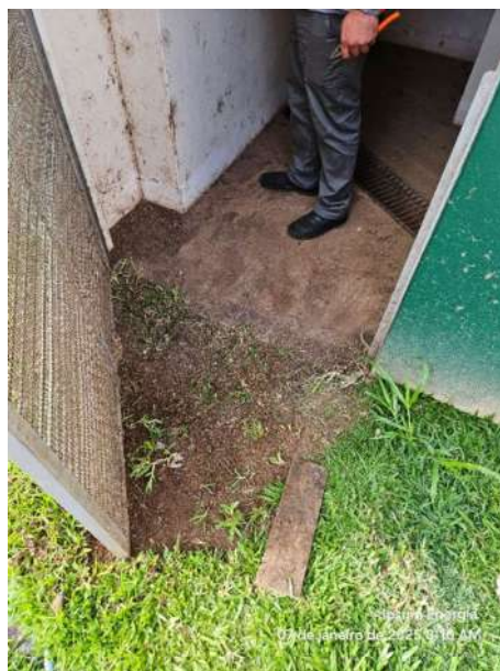
Figura 1-Porta de acesso da SE
