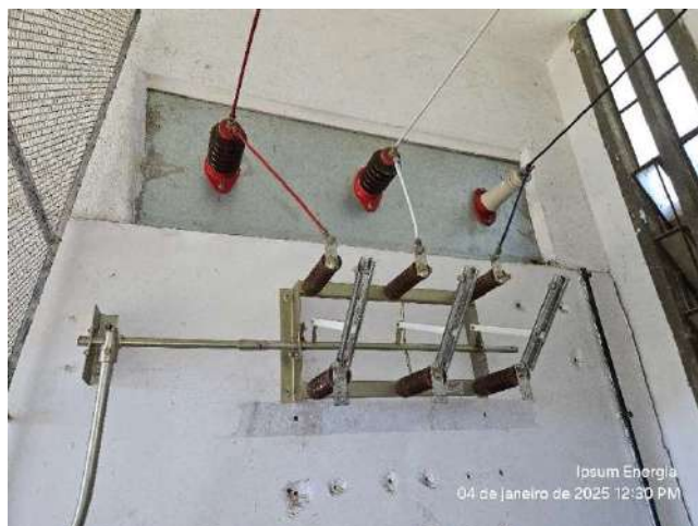
Figura 71-Seccionadora de cubiculo reserva - após limpeza
