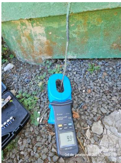
Figura 48-Resistência aterramento - SE Transformação
