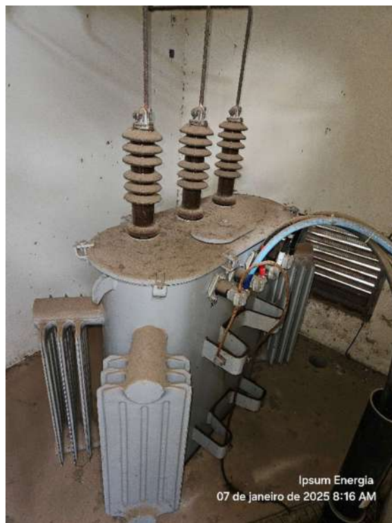
Figura 11-Transformador 1125KVA da SE
