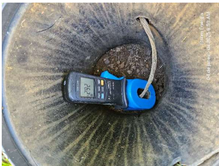
Figura 42-Caixa de inspeção 01 - Resistência de aterramento 26,2 ohms
