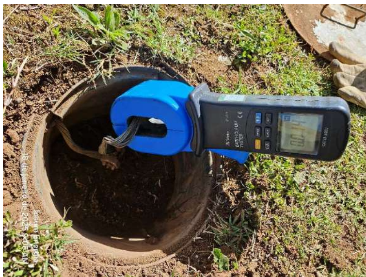
Figura 29-Resistência de aterramento - 0,014 ohms
