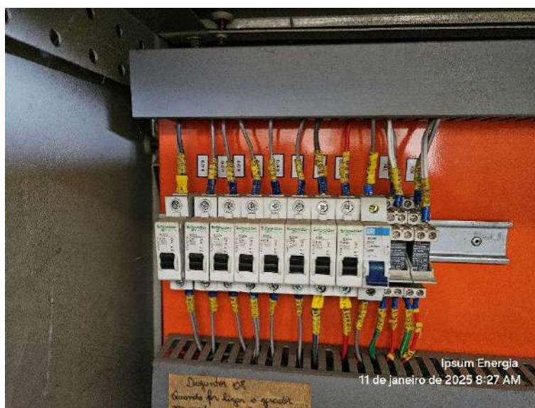
Figura 1-Disjuntores de comando do Gerador de Emergência
