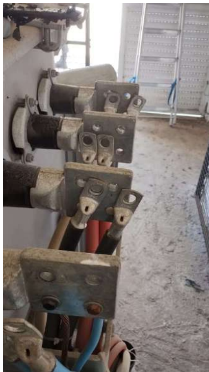
Figura 19-Parafusos de material inadequado no neutro do Trafo
