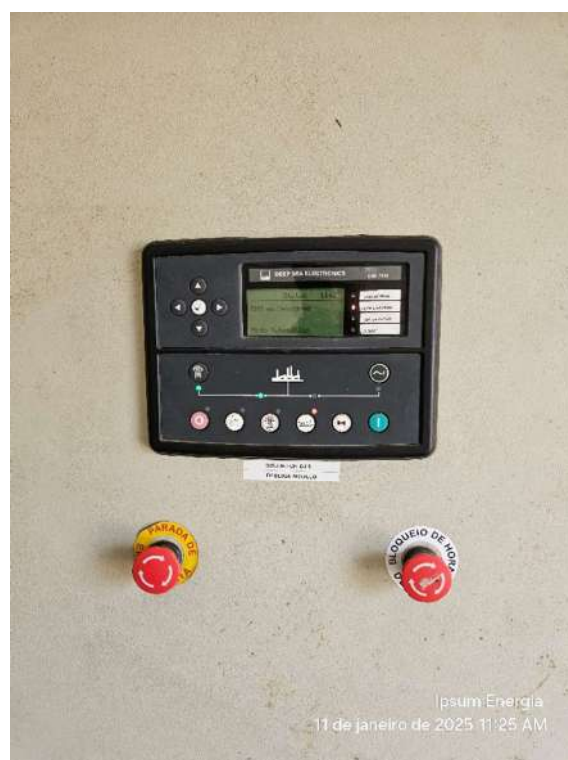
Figura 61-IHM do Gerador após desbloqueio
