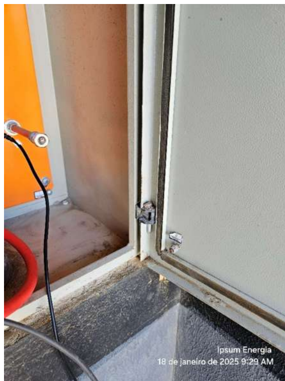
Figura 9-Quadro do disjuntor geral sem aterramento
