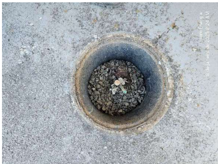
Figura 23-Caixa de inspeção do aterramento 07
