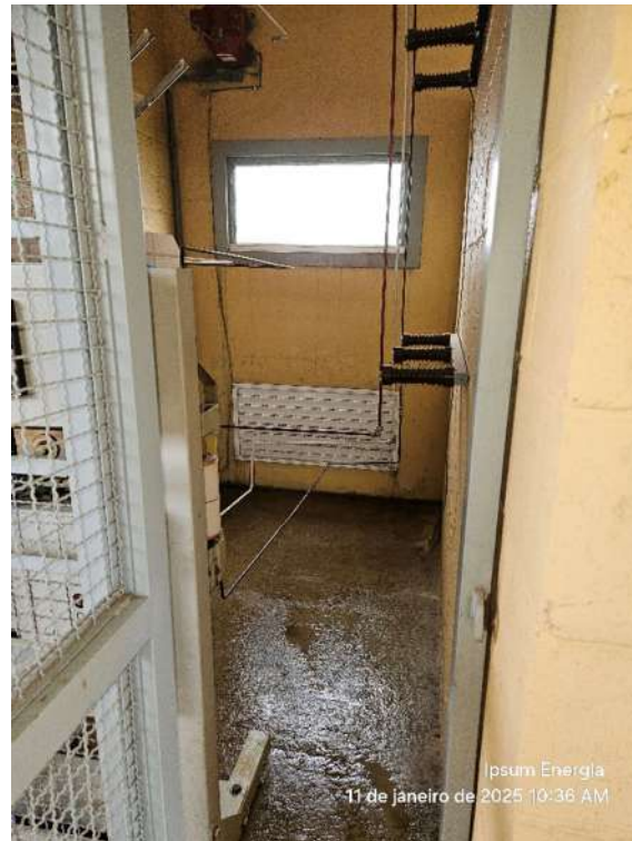
Figura 56-Cubículo de proteção
