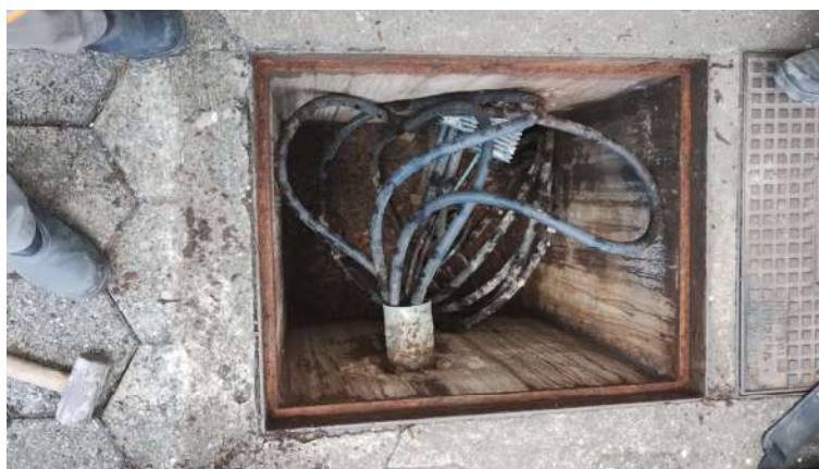
Figura 46-Caixa de passagem de Média Tensão após inspeção e limpeza
