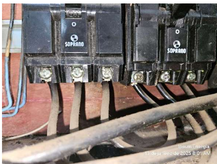
Figura 11-Conexões do QDL02 sem terminais adequados - saída
