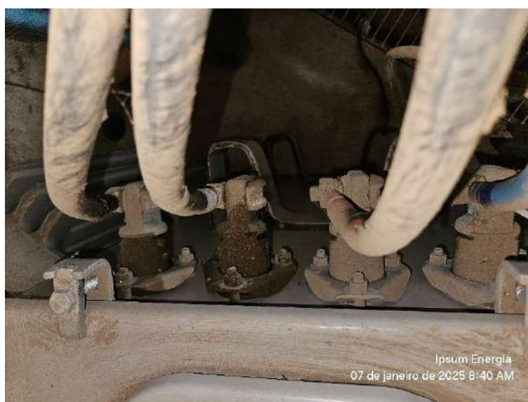
Figura 14-Visão superior do vazamento do Transformador 112,5KVA
