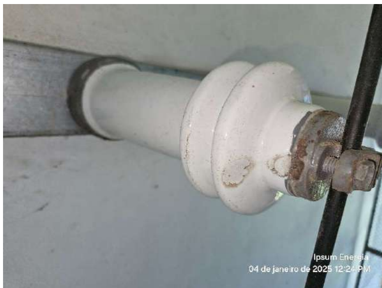
Figura 21-Isolador da entrada da SE de Transformação
