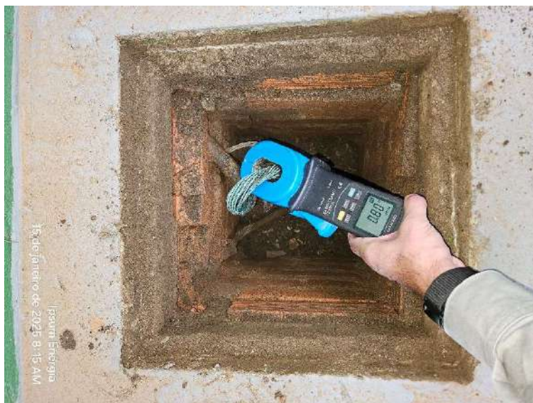
Figura 21-Resistência de aterramento - 0,8 ohms
