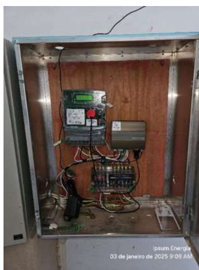
Figura 5-Quadro da Medição com poeira e furo na parte superior
