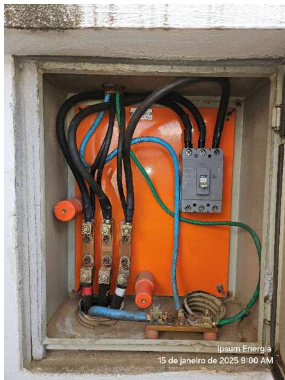
Figura 45-Quadro de distribuição - desativado
