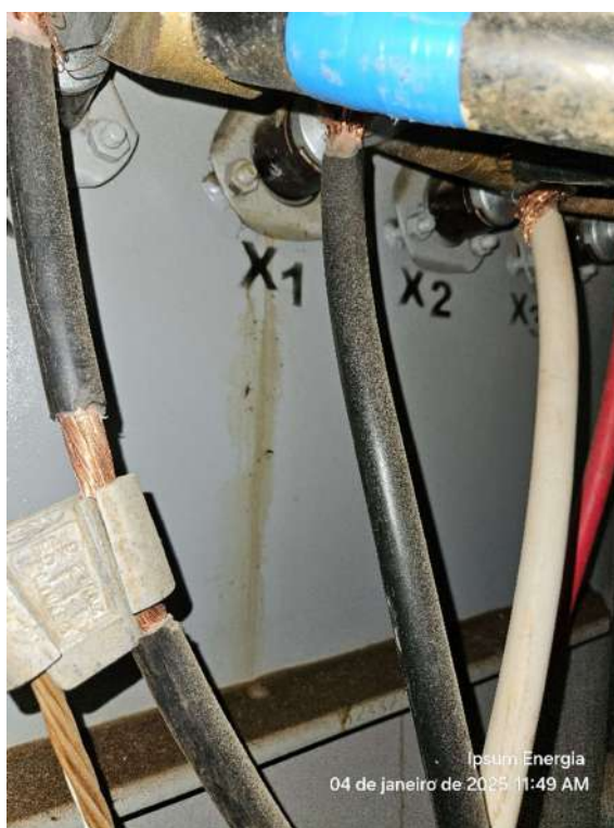
Figura 28-Vazamento bucha X1 transformador 225KVA
