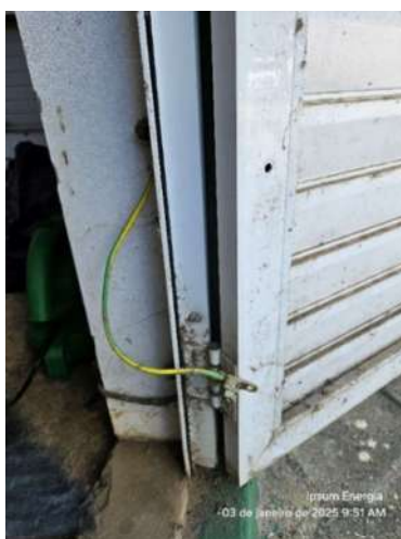
Figura 1-Aterramento da porta desconectado
