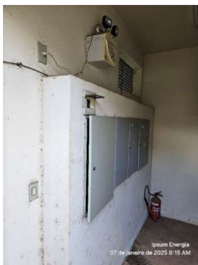
Figura 8-Painéis da SE
