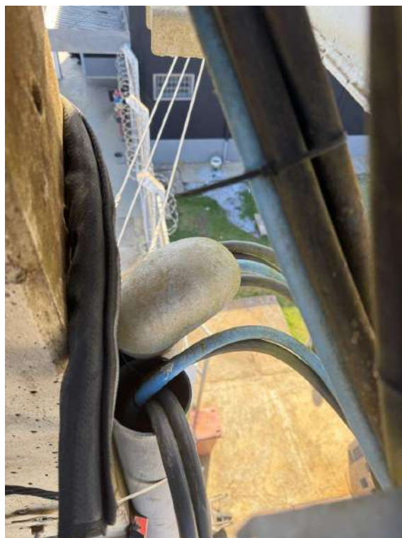
Figura 14-Eletroduto saída poste sem cabeçote
