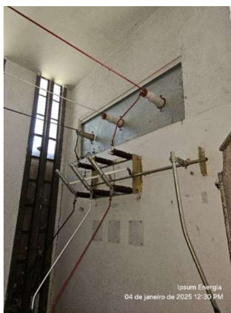
Figura 73-Seccionadora do Transformador de 150KVA
