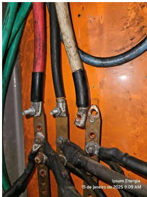
Figura 3-Barramento quadro de barramentos
