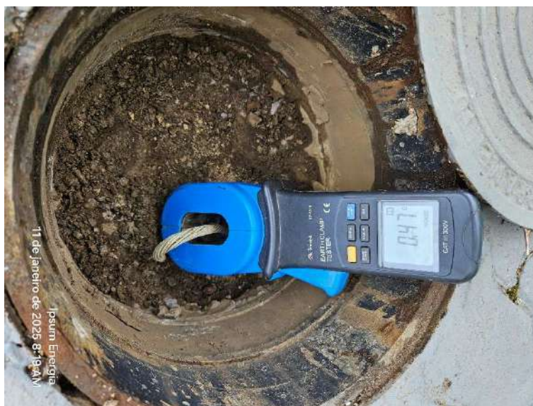
Figura 26-Caixa de inspeção 01 - Resistência de aterramento 0,47 ohms
