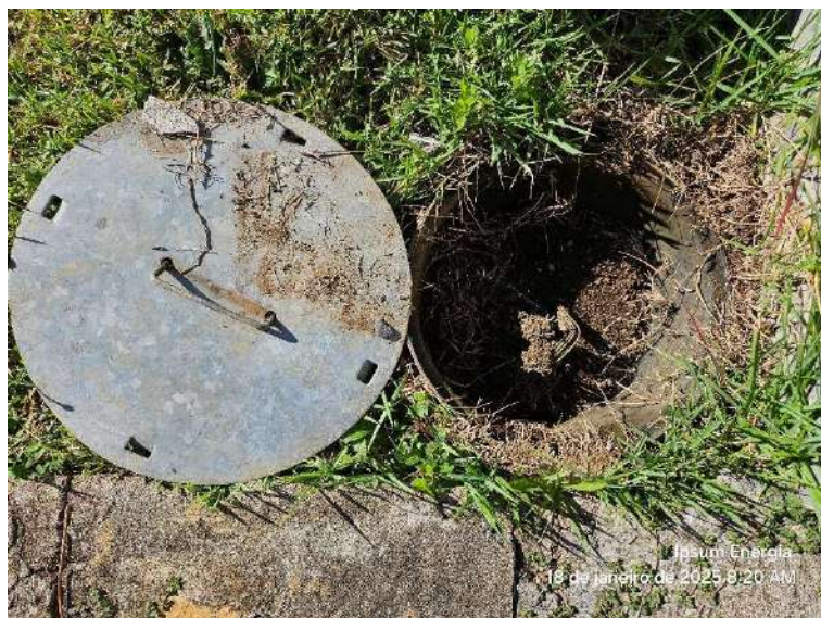
Figura 21-Caixa de inspeção do aterramento 05
