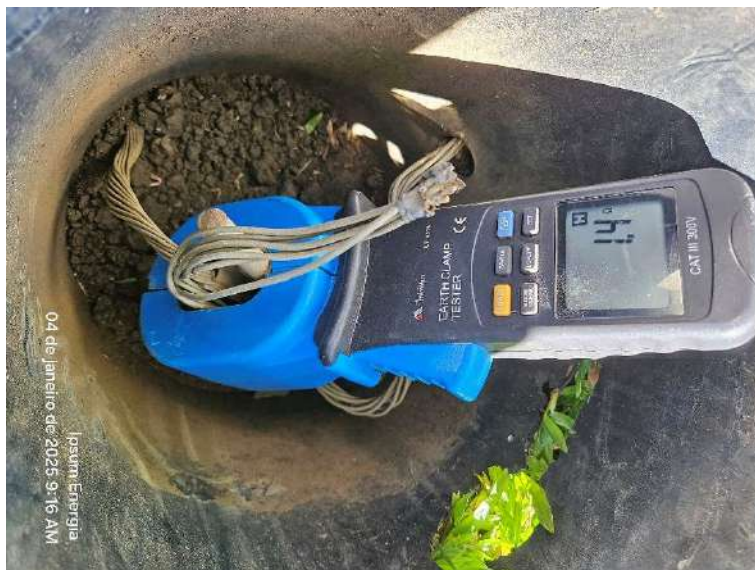
Figura 46-Caixa de inspeção 03 - Resistência de aterramento 1,4 ohms
