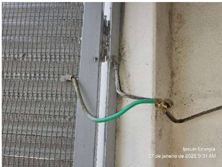
Figura 5-Aterramento porta de acesso
