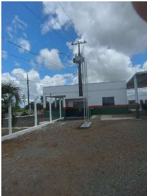
Figura 31-Subestação de transformação e medição da unidade
