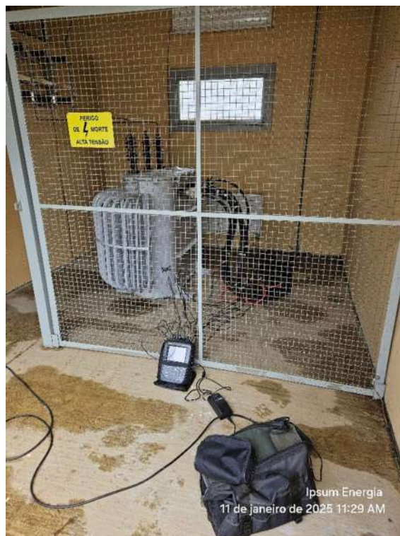
Figura 49-AQEE na baixa tensão do transformador 500KVA
