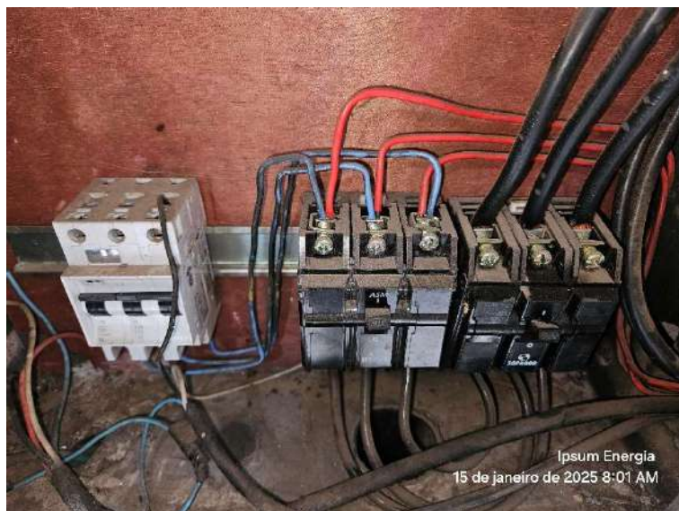
Figura 10-Conexões do QDL02 sem terminais adequados - entrada
