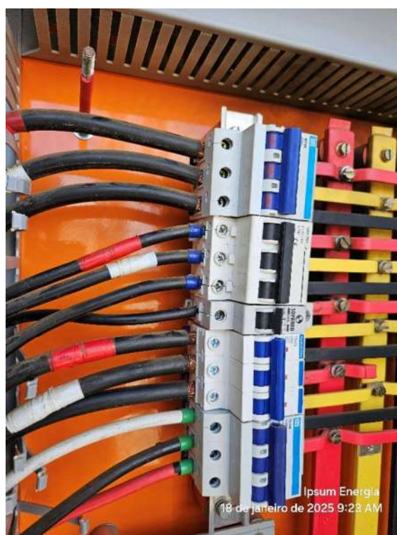
Figura 4-Disjuntores trifásicos sem terminais adequados nas conexões de saída
