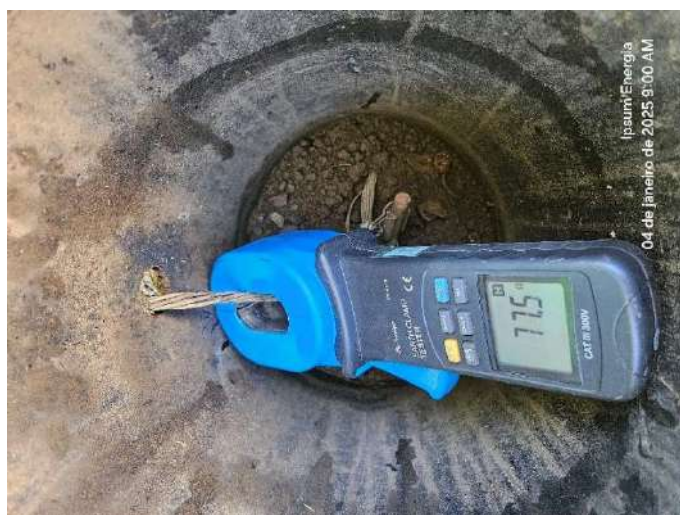
Figura 44-Caixa de inspeção 02 - Resistência de aterramento 77,5 ohms
