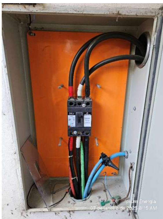
Figura 6-Disjuntor Geral da SE
