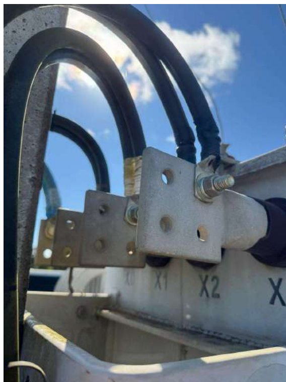
Figura 13-Conexões do transformador
