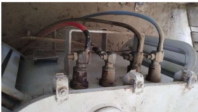
Figura 27-Secundário do transformador 150KVA
