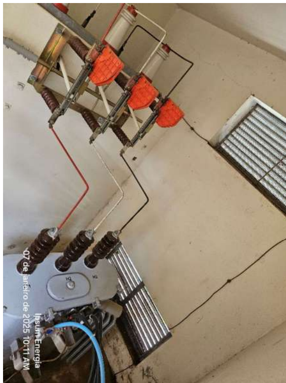
Figura 30-Isoladores, seccionadora e transformador
