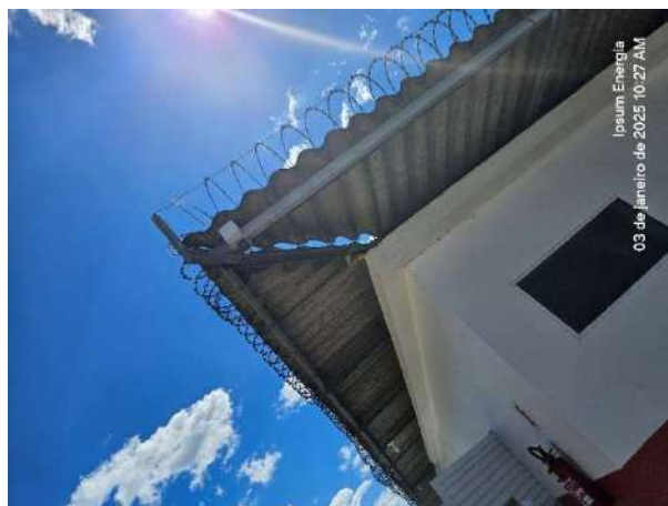
Figura 14-Local onde o telhado está sem Cumeira
