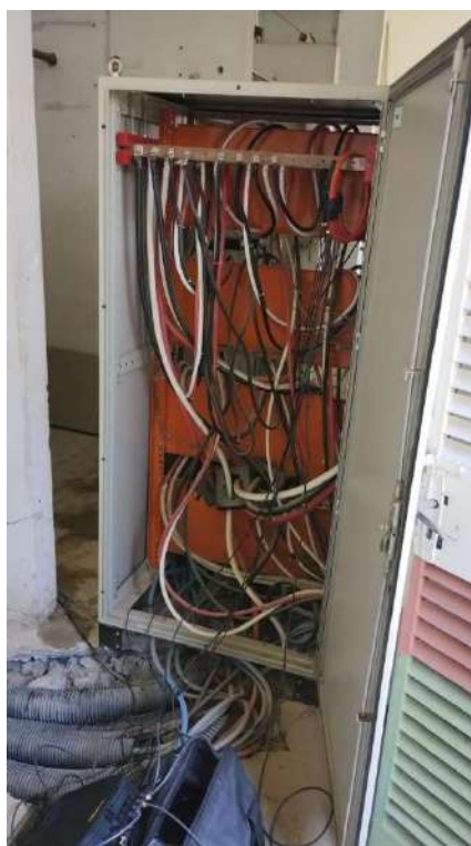
Figura 49-AQEE após a energização da unidade
