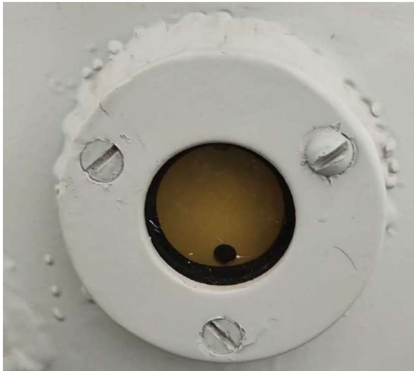
Figura 21-Nível do óleo do transformador
