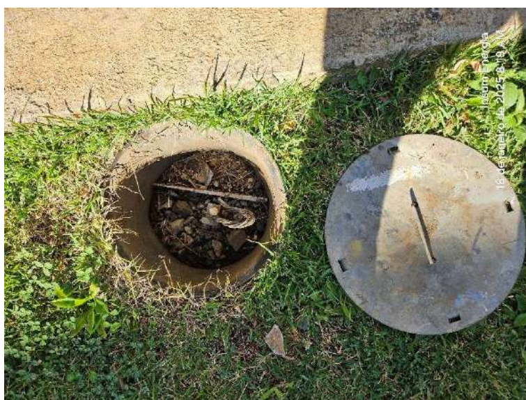
Figura 18-Caixa de inspeção do aterramento 02
