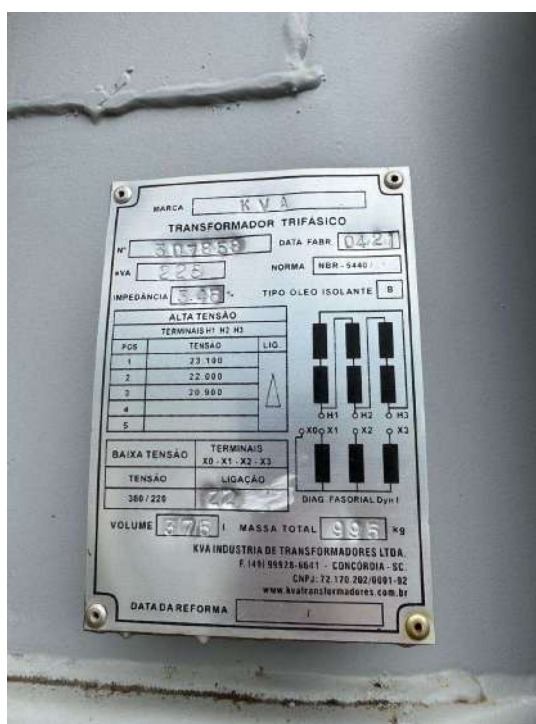
Figura 19-Placa de dados do transformador
