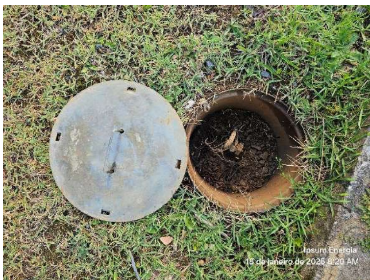
Figura 20-Caixa de inspeção do aterramento 04
