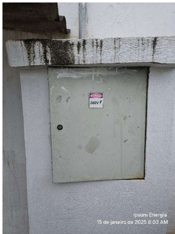
Figura 12-Quadro de distribuição sem carga
