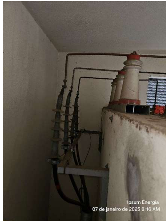
Figura 9-Entrada das mufas e isoladores
