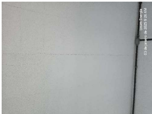
Figura 12-Trincas na laje – Centro da Subestação – parte 2
