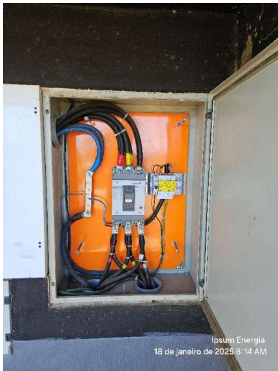
Figura 1-Quadro do disjuntor geral da unidade
