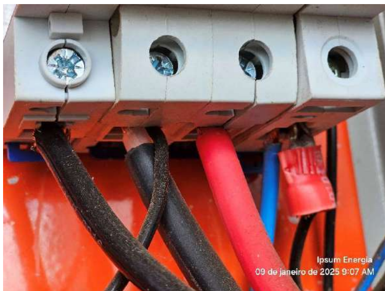
Figura 13-Conexões de baixa tensão sem terminais adequados - saída
