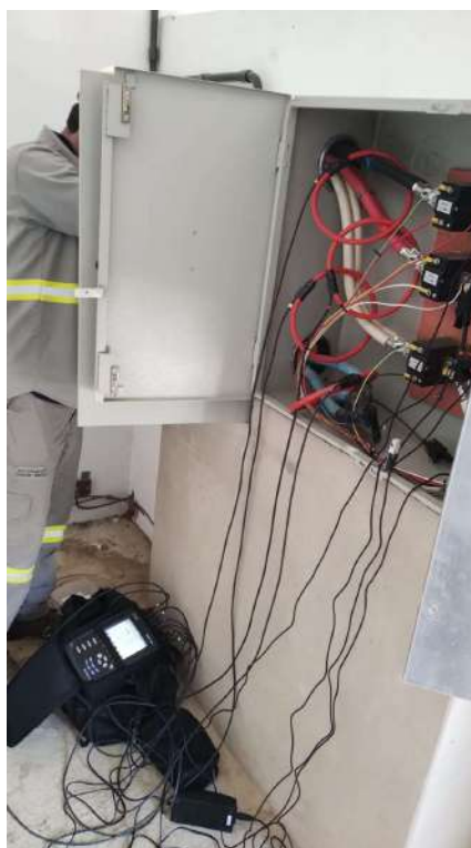
Figura 25-AQEE após a energização da unidade
