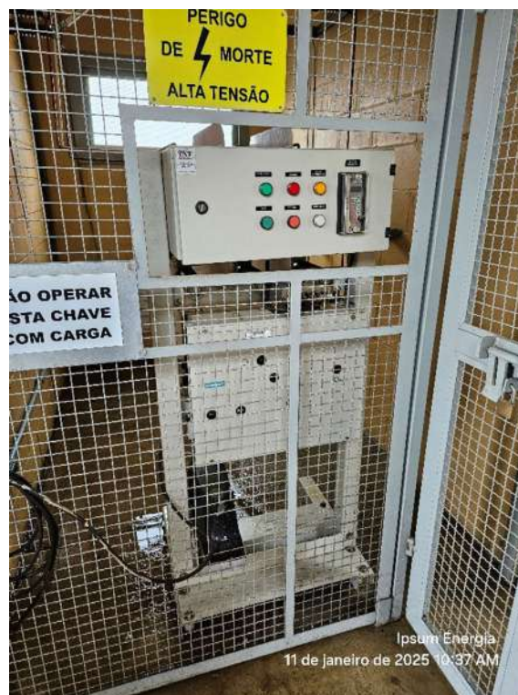
Figura 55-Cubículo de proteção - Disjuntor
