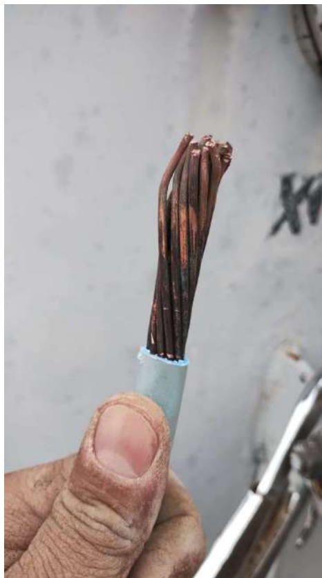
Figura 11-Cabo neutro com sinal de oxidação
