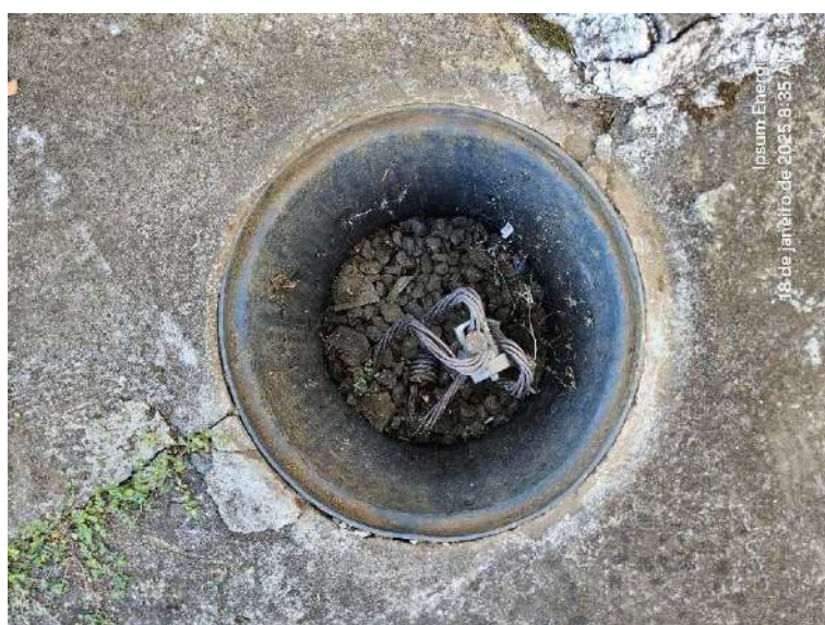
Figura 24-Caixa de inspeção do aterramento 08
