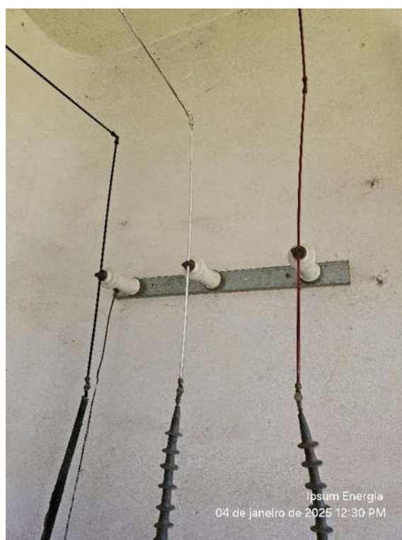
Figura 70-Isoladores da entrada da SE de Transformação
