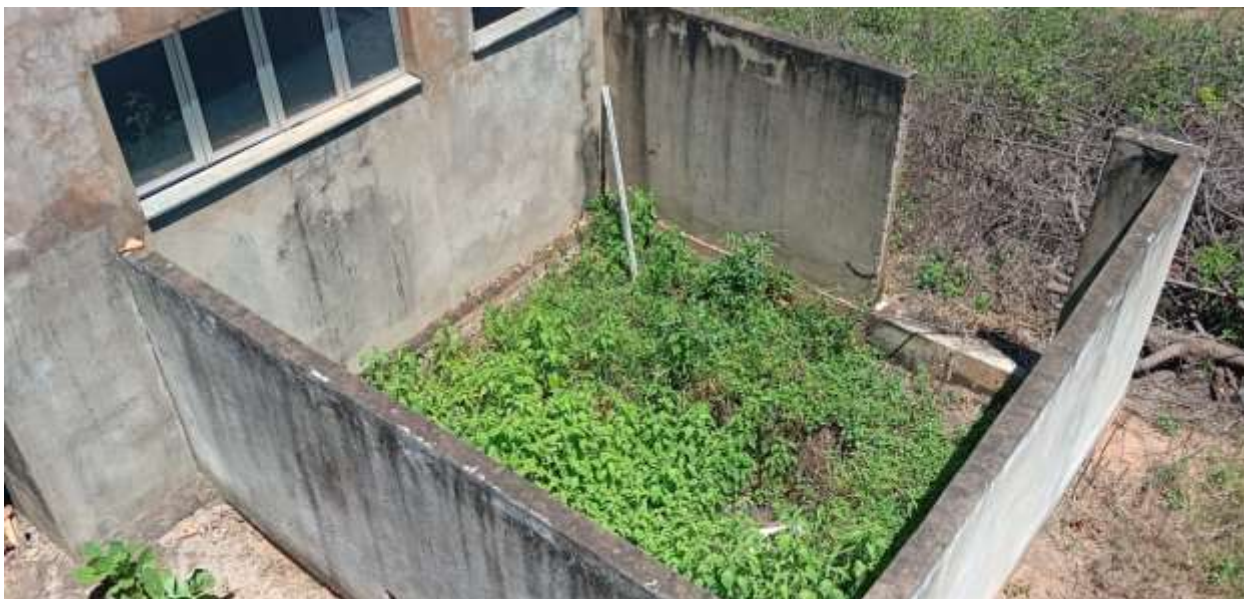
Figura 35 – Reservatório de fibra, com capacidade de 3.000 litros, situação atual, coberto por vegetação.
