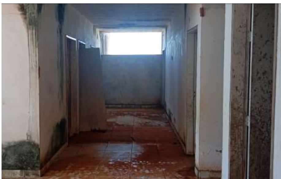
Figura 17 – Portas de madeira danificadas pela infiltração - Fonte: elaboração própria.
