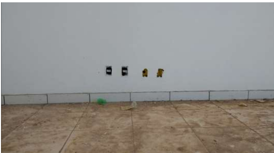
Figura 27 – Tomadas instaladas anteriormente (Foram removidas por vandalismo ou furto).
