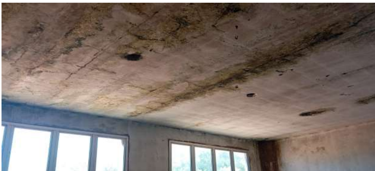
Figura 09 – Reboco do teto danificado devido infiltração do telhado. Fonte: elaboração própria.
