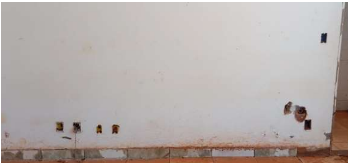
Figura 29 – Tomadas e interruptores removidos por vandalismo ou furto – Fonte: elaboração própria.
