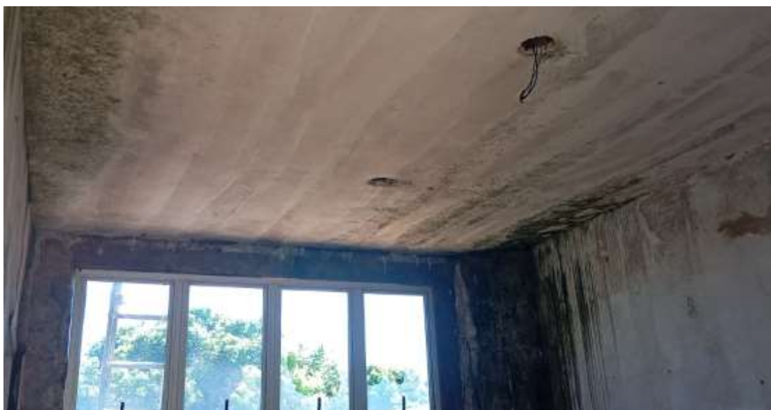
Figura 31 – Ponto de iluminação no teto com fiação removida por vandalismo ou furto, faltando refazer a fiação e instalar as luminárias - Fonte: elaboração própria.
