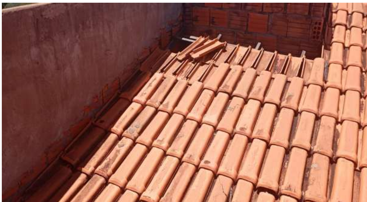
Figura 6 – Telhamento incompleto, telhas quebradas e ausência de rufos metálicos. Fonte: elaboração própria.
