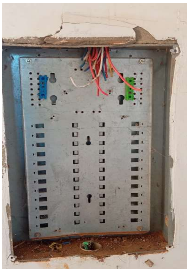
Figura 30 – Quadro de distribuição danificado, tendo os cabos e disjuntores removidos por vandalismo ou furto. Fonte: elaboração própria.
