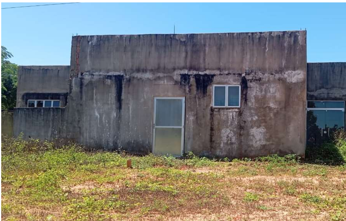
Figura 11 – Reboco de parede externa danificado devido a intempéries. Fonte: elaboração própria.
