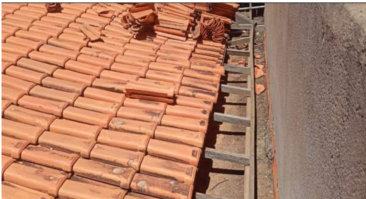
Figura 5 – Ausência de calha em chapa metálica na cobertura. Fonte: elaboração própria.
