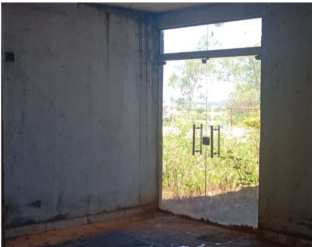
Figura 22 – Porta de vidro temperado instalada e em bom estado de conservação - Fonte: elaboração própria.
