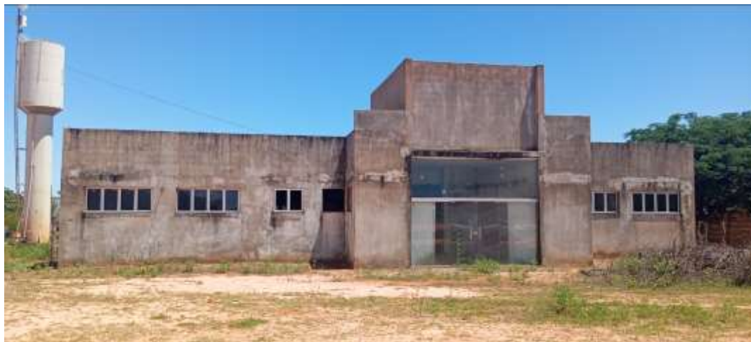
Figura 33 – Vista geral da edificação sem para-raios ou qualquer equipamento do Sistema de Proteção contra Descargas Atmosféricas - SPDA – Fonte: elaboração própria.
