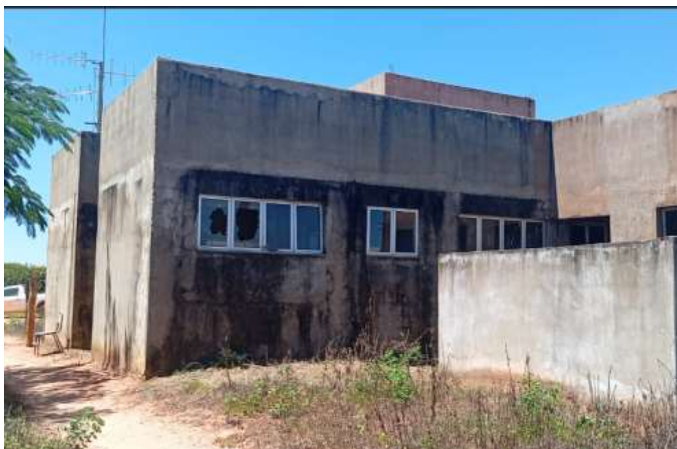
Figura 24 – Janela metálica instalada com vidros quebrados – substituir os vidros - Fonte: elaboração própria.
