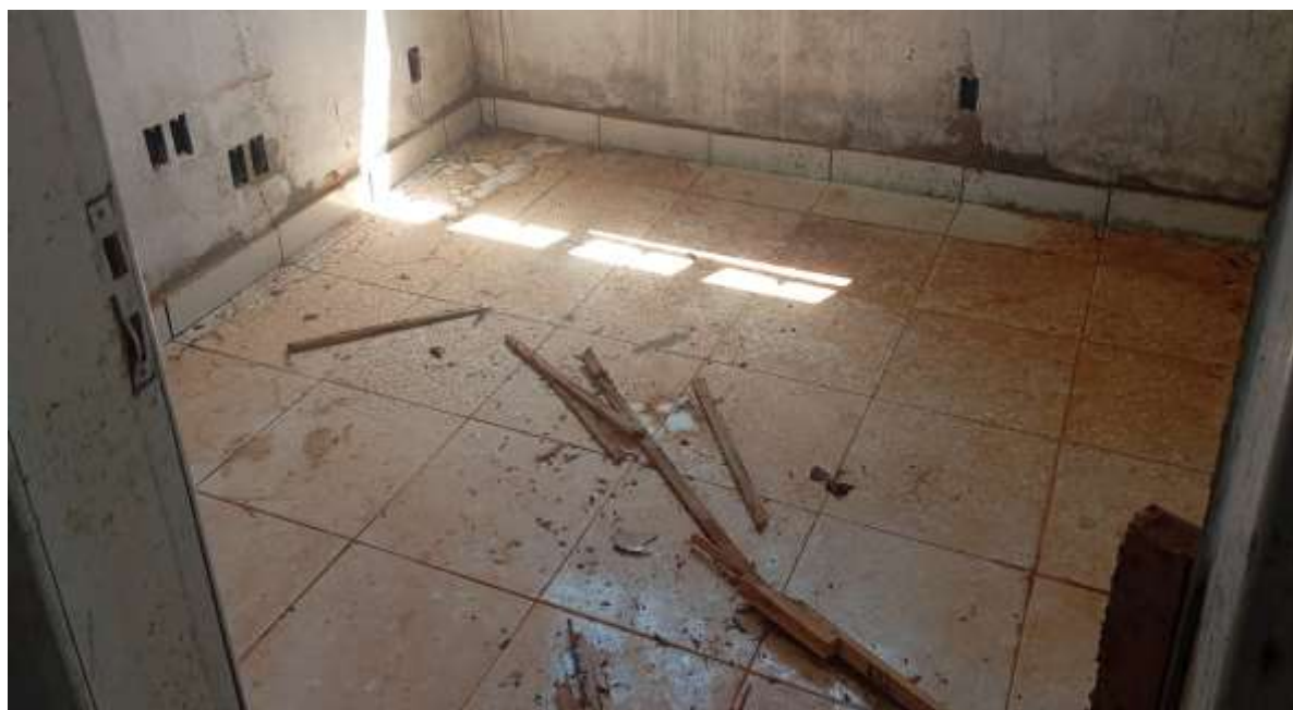
Figura 32 – Tubulação e caixas de passagem de telefonia e rede lógica embutidas – Fonte: elaboração própria.
