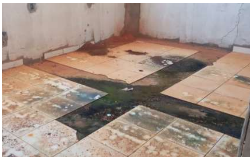
Figura 14 – Piso cerâmico inacabado e danificado em um dos compartimentos - Fonte: elaboração própria.
