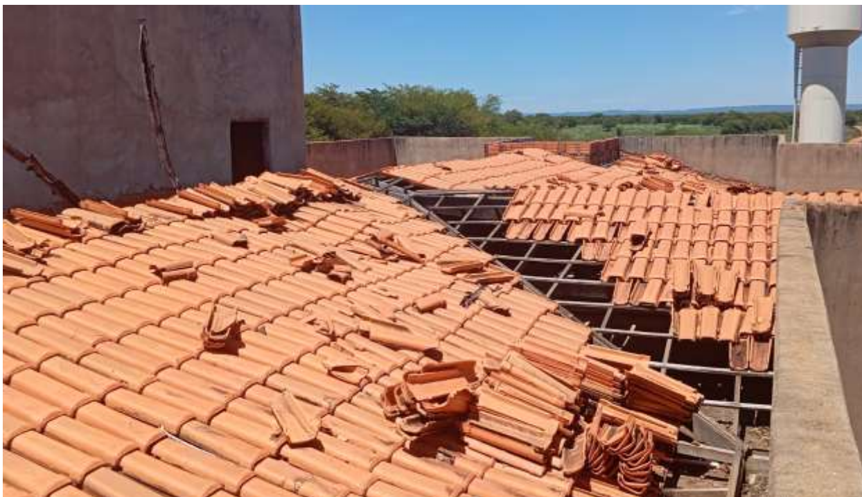
Figura 7 – Vista geral da cobertura: ausência de cumeeira e água furtada. Fonte: elaboração própria.
