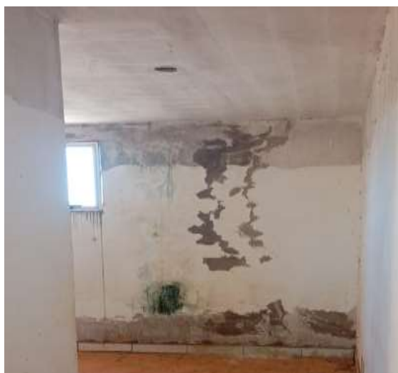
Figura 10 – Reboco de parede interna danificado devido a infiltrações. Fonte: elaboração própria.
