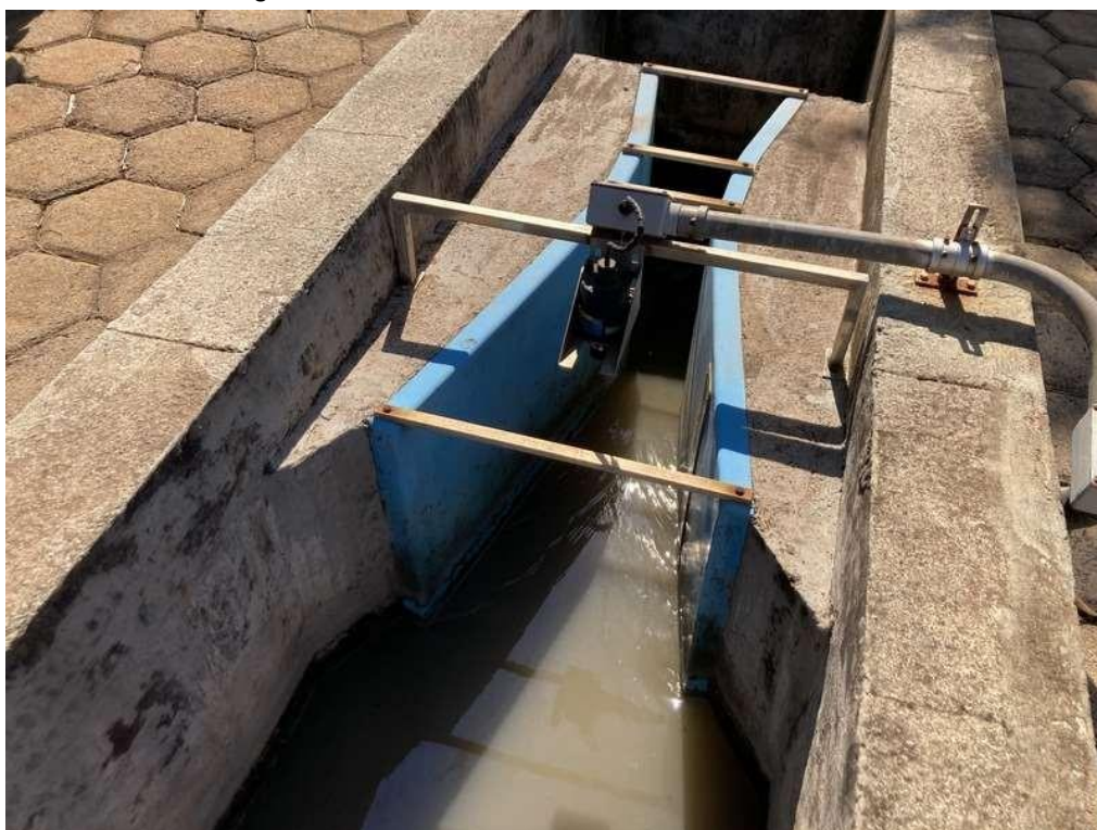
Figura – Medidor de vazão: Calha Parshall
