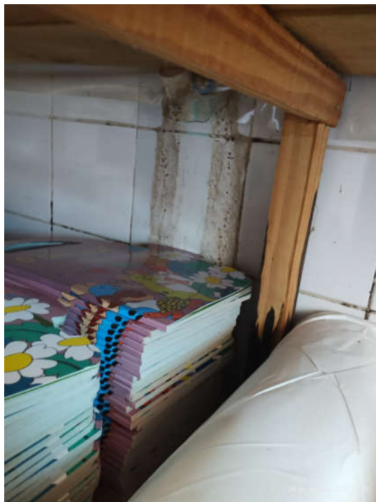
Figura 11 - Pontos de infiltração em paredes internas
