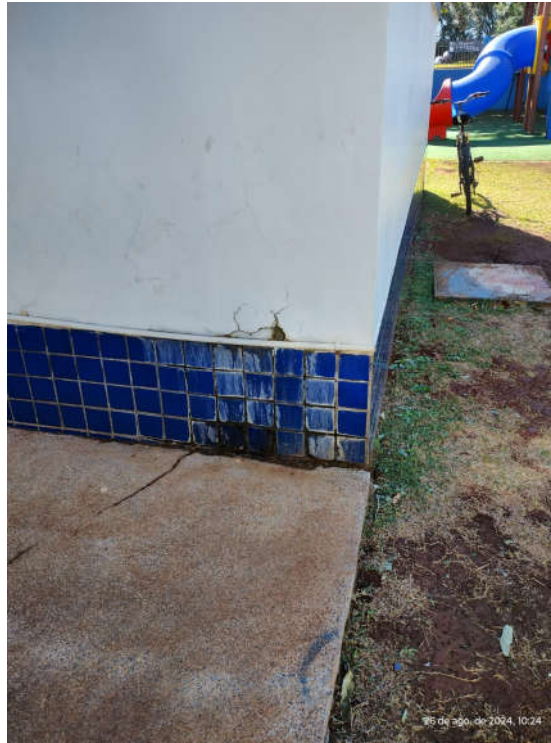
Figura 12 - Ponto de infiltração em parede externa
