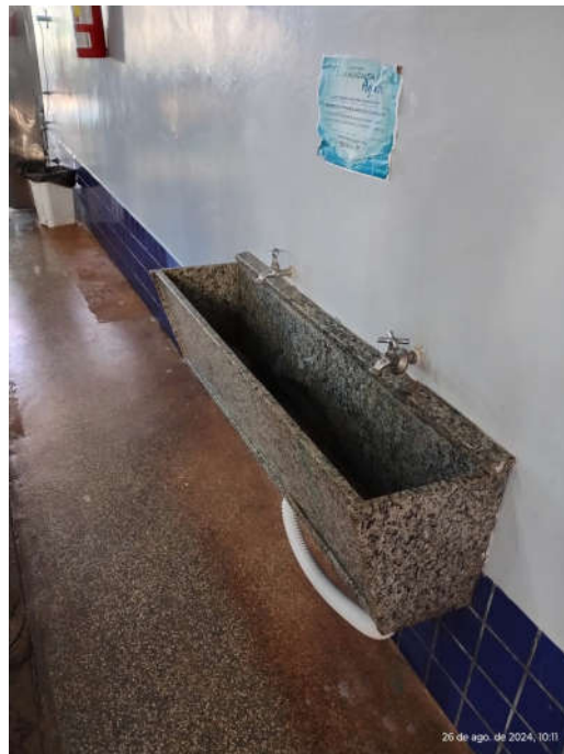
Figura 7 - Pia a remover no Pátio coberto
