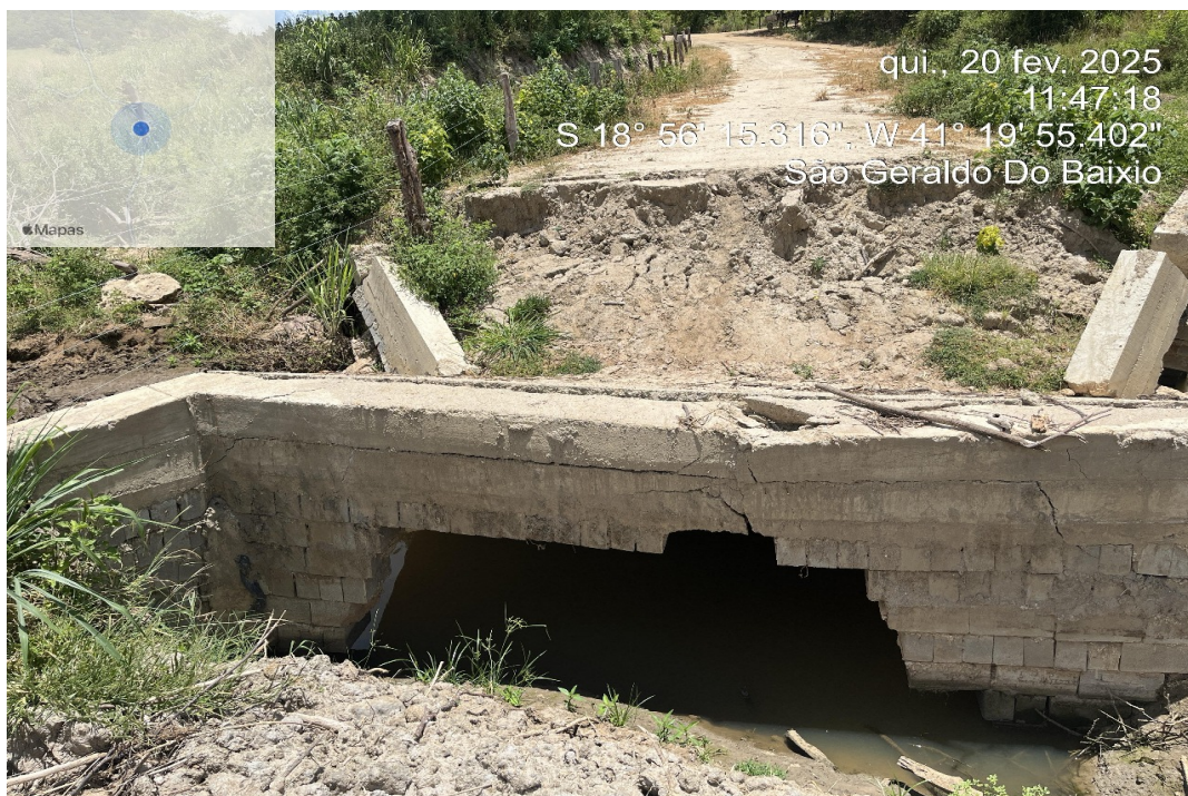
Ponte completamente destruída
