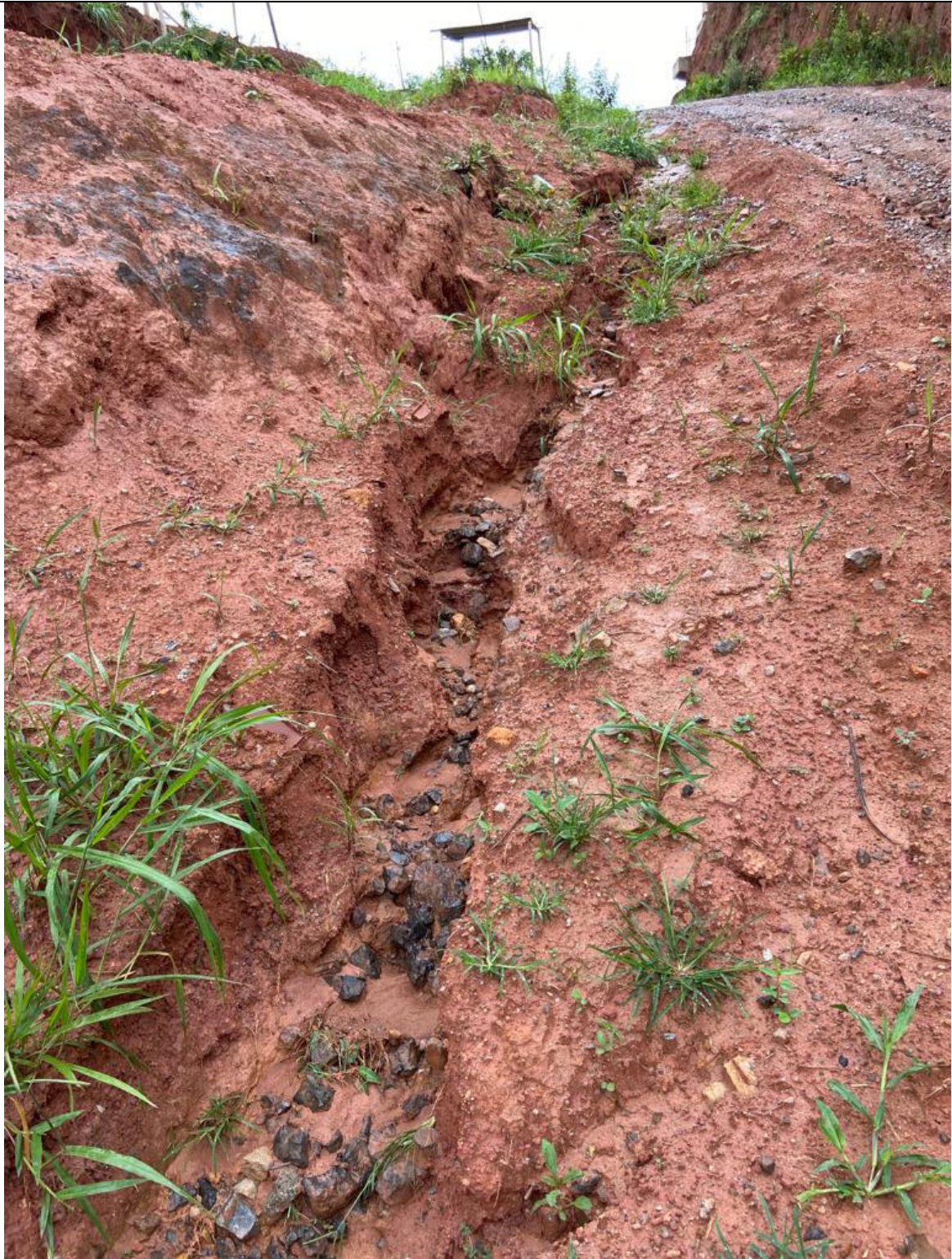
Rua Sergipe – Início de Erosão
