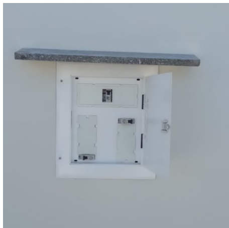
Imagem 13: Proteção do Quadro de distribuição
