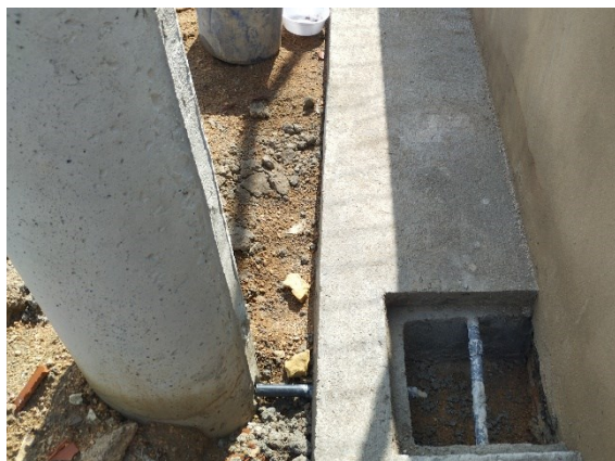
Imagem 12: Caixa de passagem ao lado de poste de iluminação
