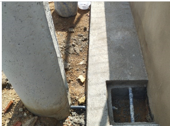
Imagem :Caixa de passagem ao lado de poste de iluminação
