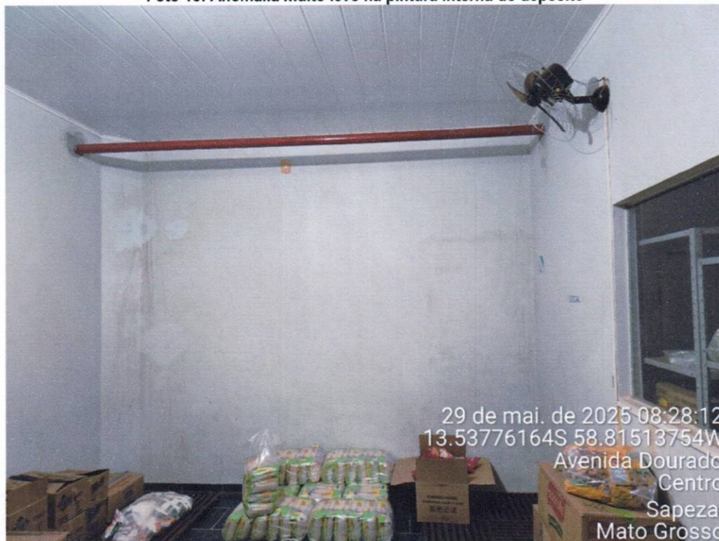
Foto 13: Anomalia muito leve na pintura interna do depósito
