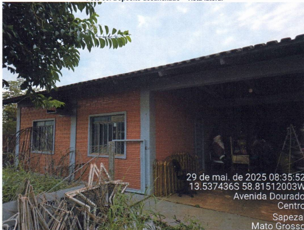
Foto 36: Depósito desanexado – vista lateral
