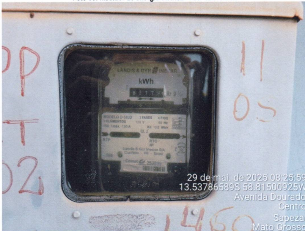
Foto 03: Medidor de energia elétrica – fachada lateral
