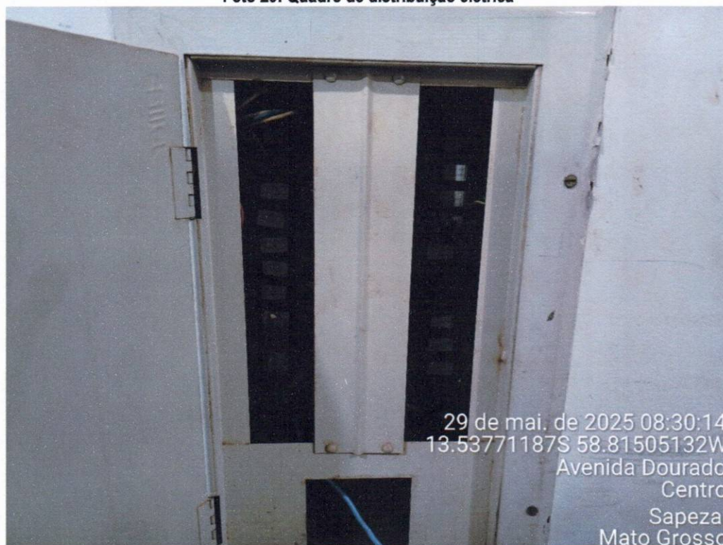
Foto 20: Quadro de distribuição elétrica
