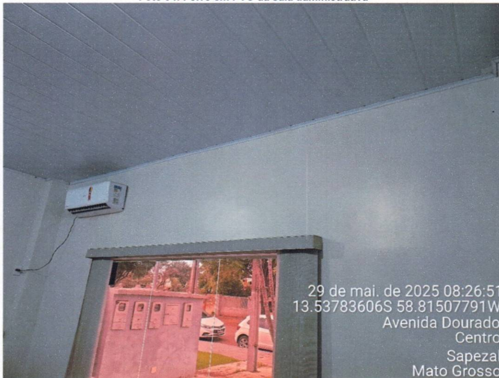
Foto 04: Forro em PVC da sala administrativa
