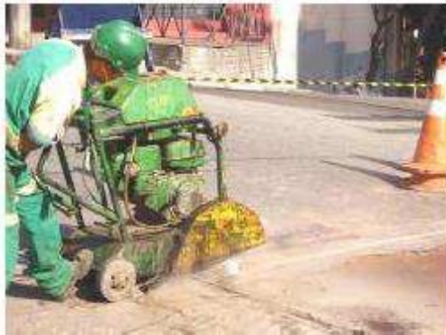
Figura 2: recorte da área danificada
