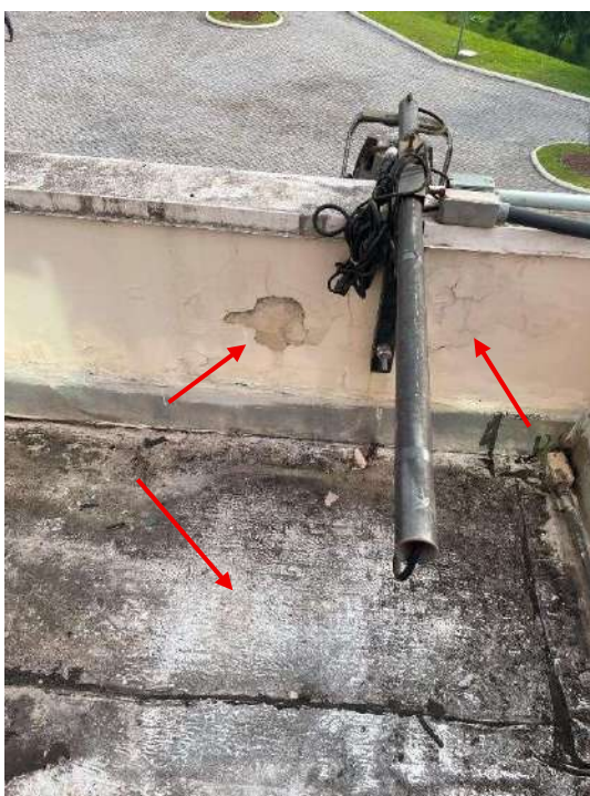
Fotografia 87 - Sistema de impermeabilização ineficiente / infiltrações na platibanda
