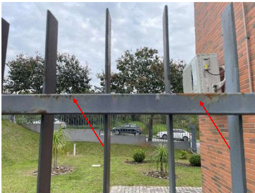
Fotografia 6 - Corrosão da pintura
