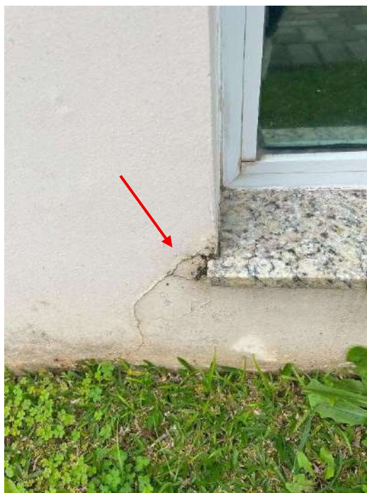
Fotografia 75 - Fissura por provável retração de argamassa
