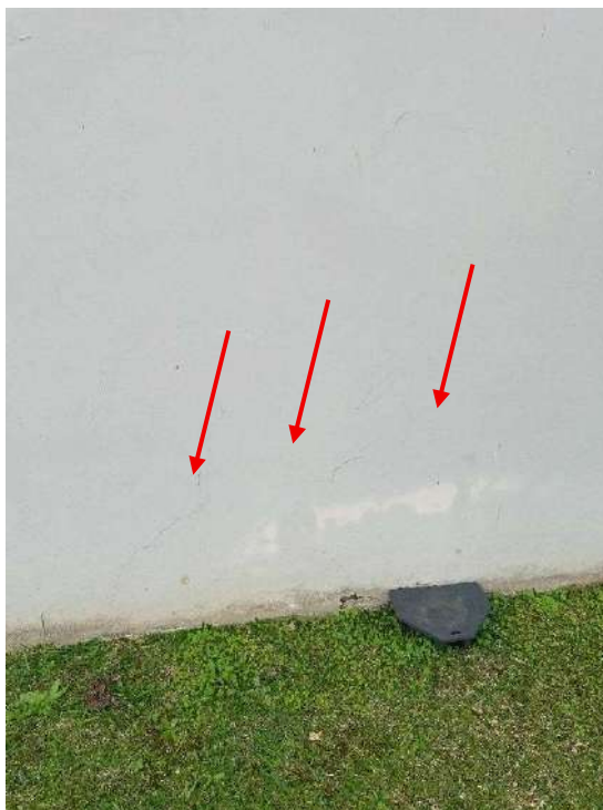
Fotografia 69 - Fissura por provável retração de argamassa
