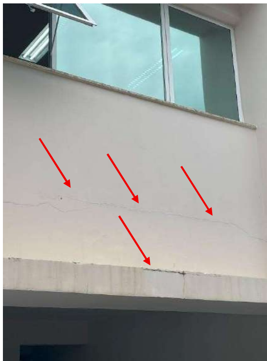
Fotografia 37 - Fissura por provável retração de argamassa
