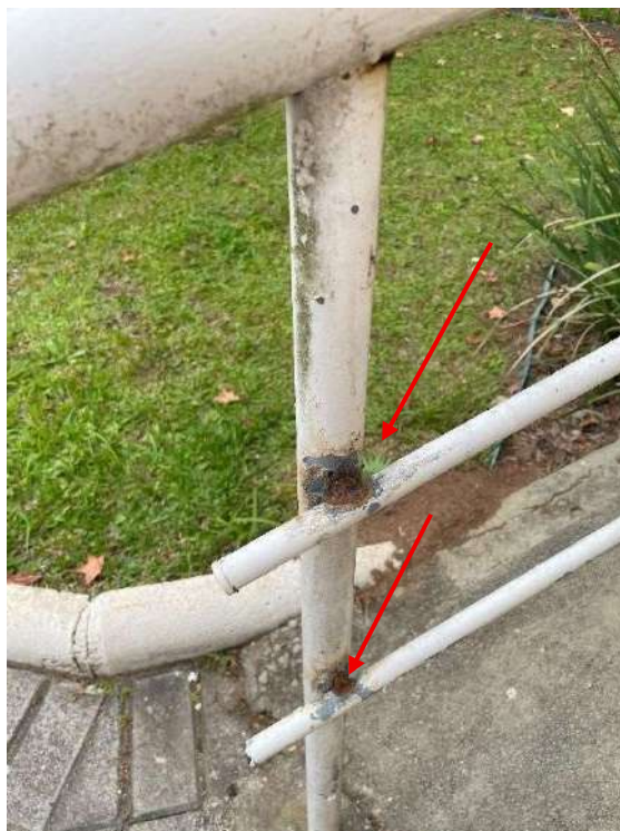
Fotografia 45 - Corrosão em corrimão metálico da rampa
