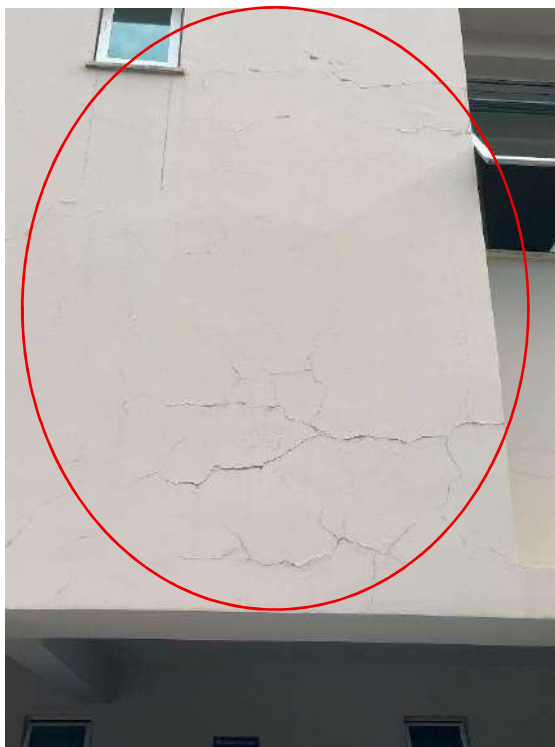
Fotografia 36 - Fissura por provável retração de argamassa
