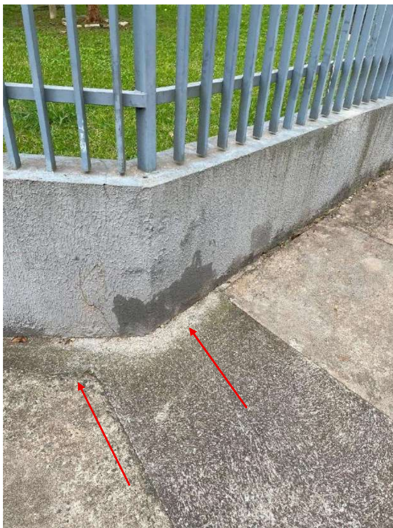
Fotografia 4 - fissura por provável retração de argamassa / Infiltração
