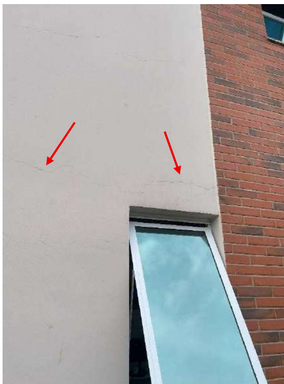
Fotografia 71 - Fissura por provável retração de argamassa
