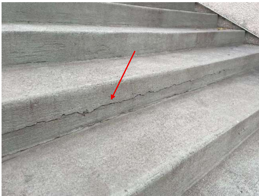
Fotografia 121 - Fissuração contrapiso escada
