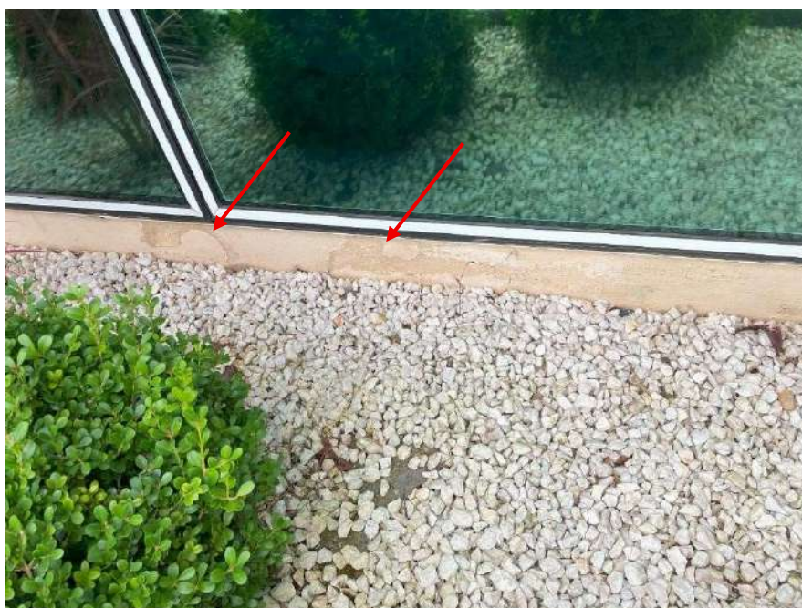
Fotografia 73 - Pulverulência de revestimento tipo emboço de fachada
