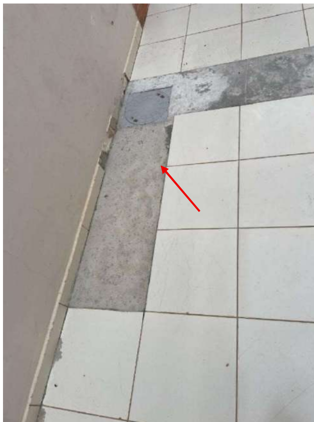
Fotografia 63 - Desplacamento de peças cerâmicas
