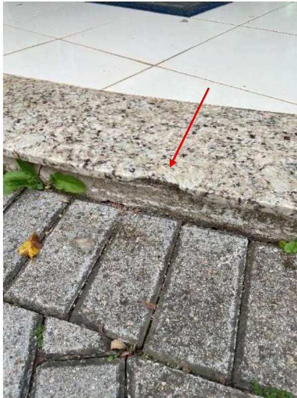
Fotografia 125 - Soleira de granito danificada
