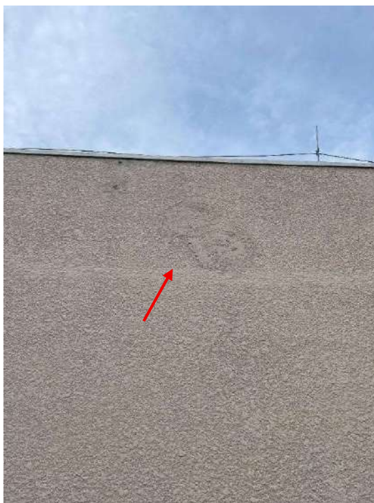
Fotografia 50 - Infiltração em revestimento tipo emboço de fachada
