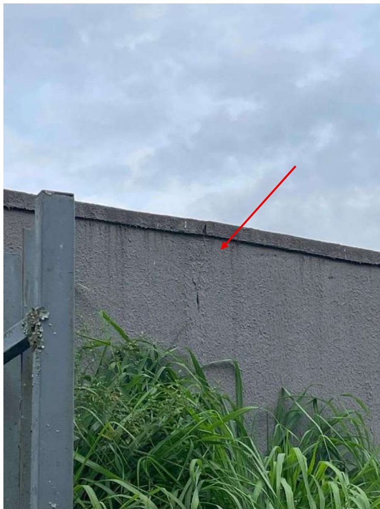
Fotografia 9 - Fissura por movimentação estrutural do muro
