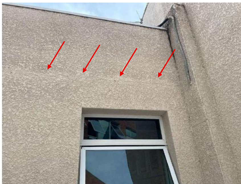
Fotografia 65 - Fissura por provável retração de argamassa / Infiltração
