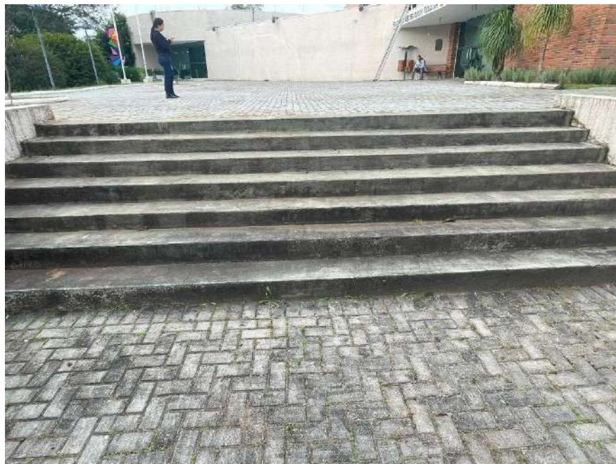
Fotografia 126 - Fissuração contrapiso escada de acesso
