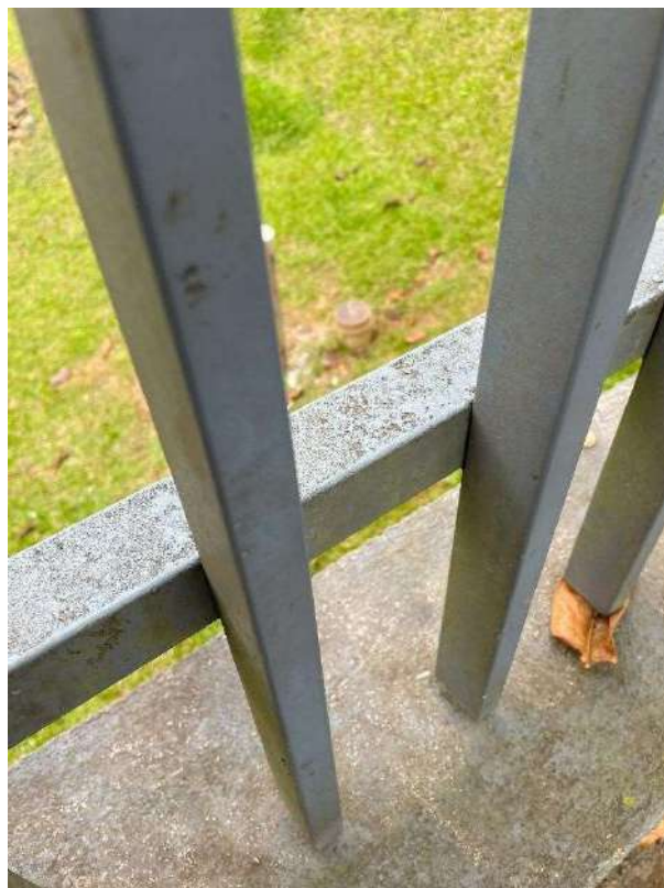
Fotografia 5 - Corrosão da pintura
