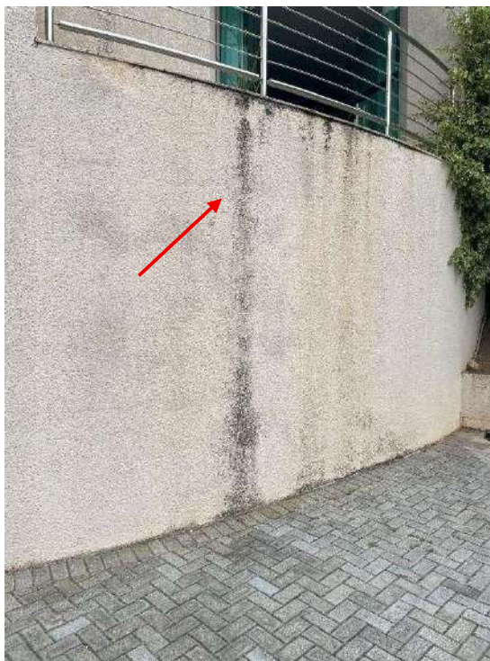
Fotografia 43 - manchas negras em fachada
