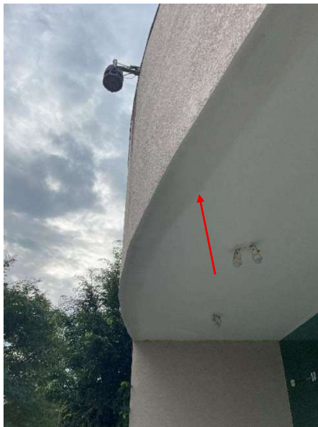
Fotografia 48 - Sinais de infiltração forro de gesso
