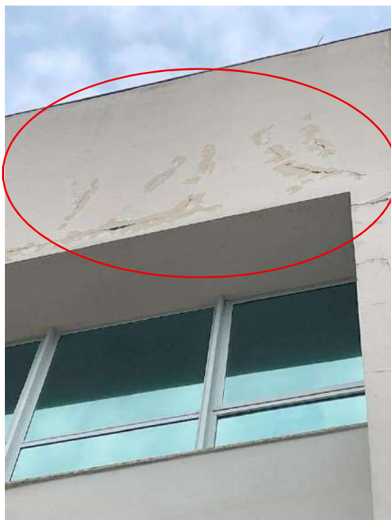
Fotografia 33 - Fissura por provável retração de argamassa
