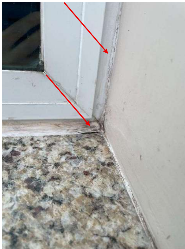
Fotografia 28 – Degradação das juntas de silicone
