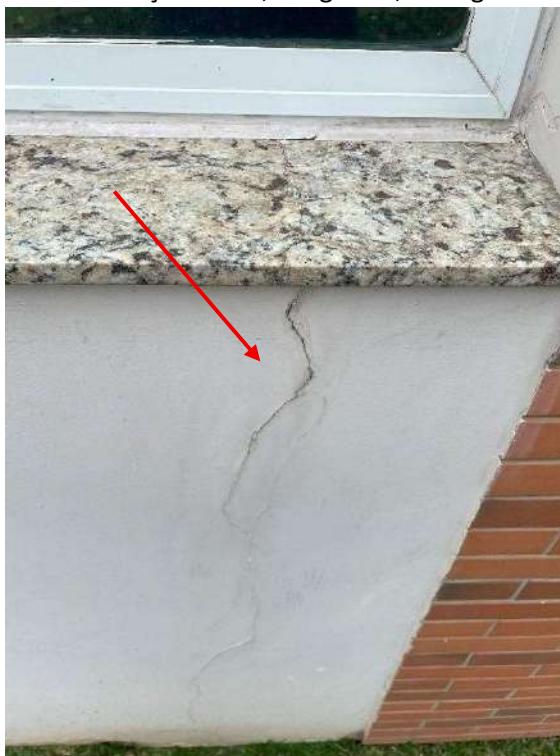
Fotografia 27 - Fissura por provável retração de argamassa.
