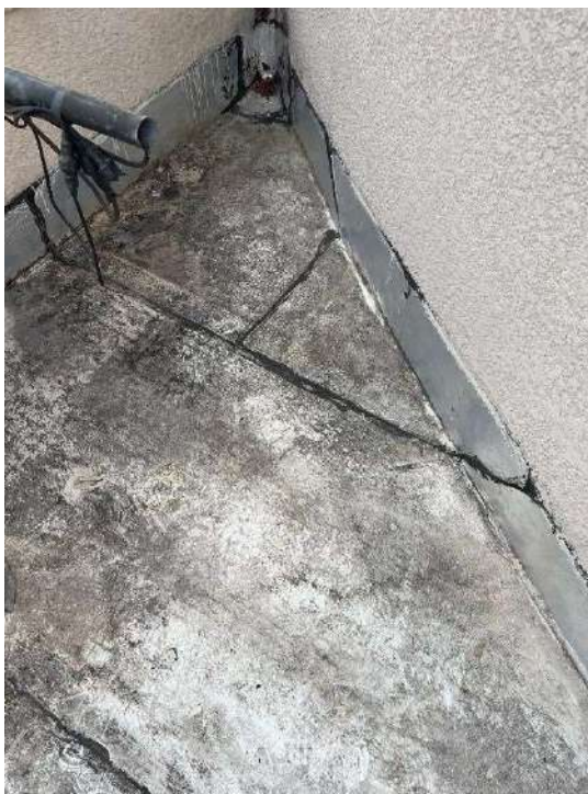
Fotografia 78 - Impermeabilização ineficiente; laje do auditório do plenário
