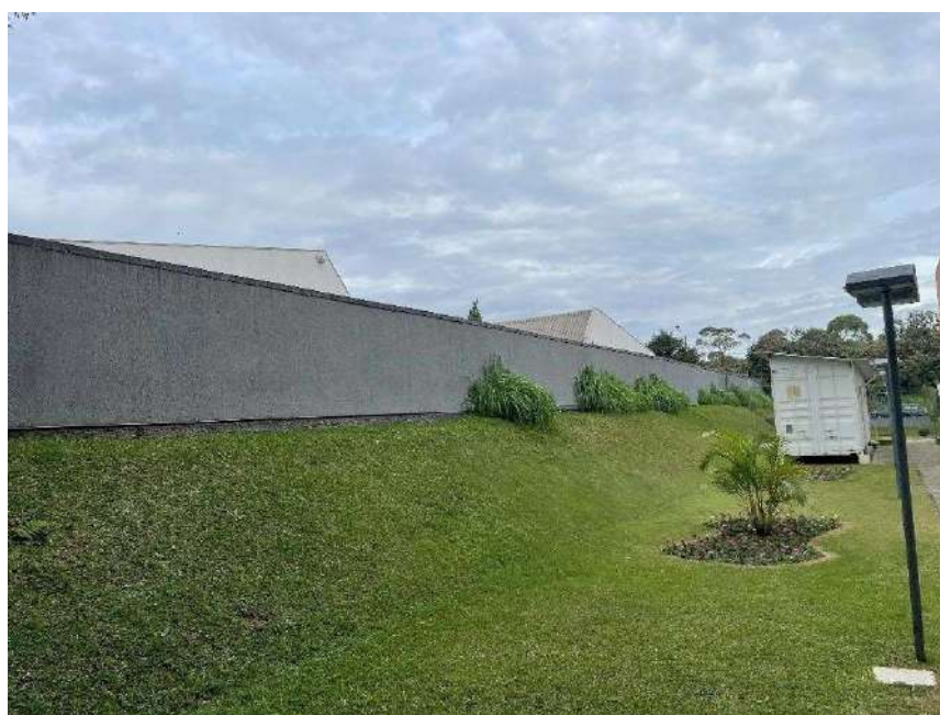
Fotografia 8 – Manchas e fungos na pintura do muro.
