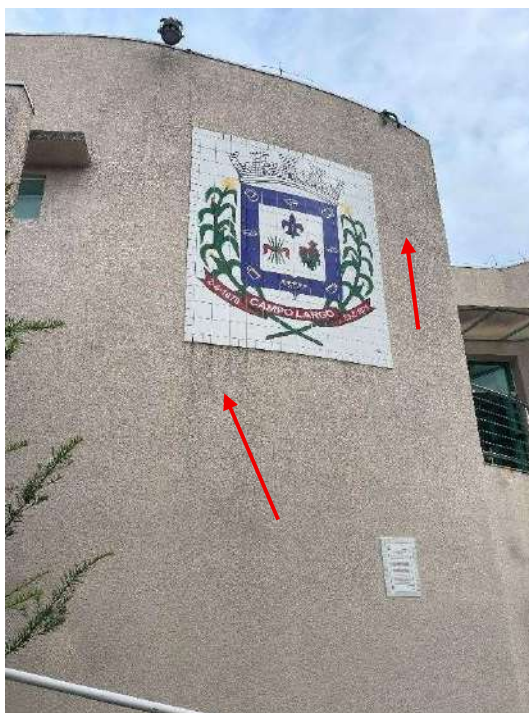
Fotografia 46 - manchas negras em fachada
