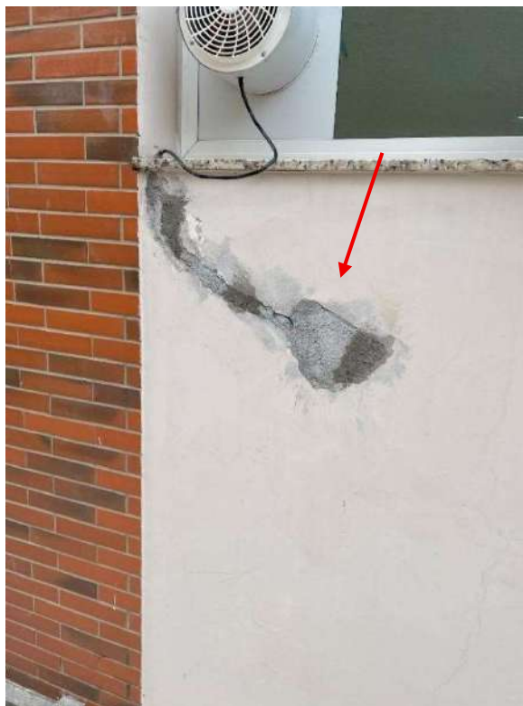
Fotografia 59 - Reboco mal acabado e com fissuras aparentes
