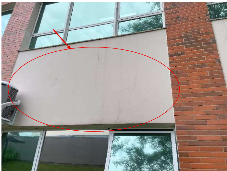
Fotografia 25 - Fissura por provável retração de argamassa / Infiltração
