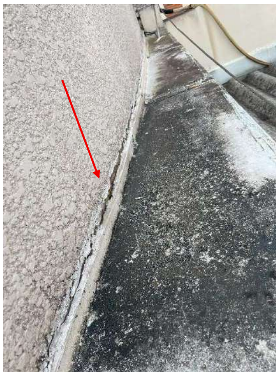
Fotografia 94 - Falta de vedação na interface rufo/parede
