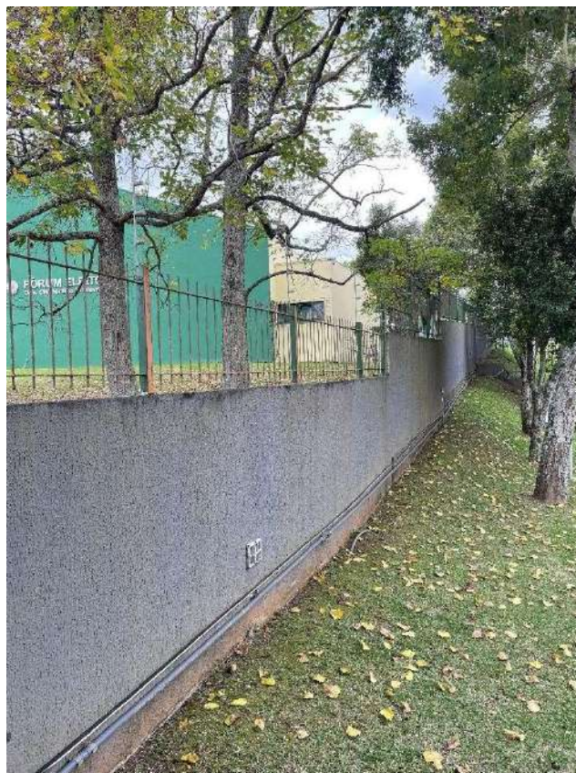
Fotografia 7 - Manchas e fungos na pintura do muro.
