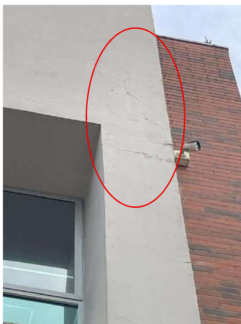
Fotografia 40 - Fissura por provável retração de argamassa
