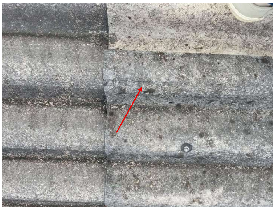
Fotografia 93 - Fissura em telha fibrocimento
