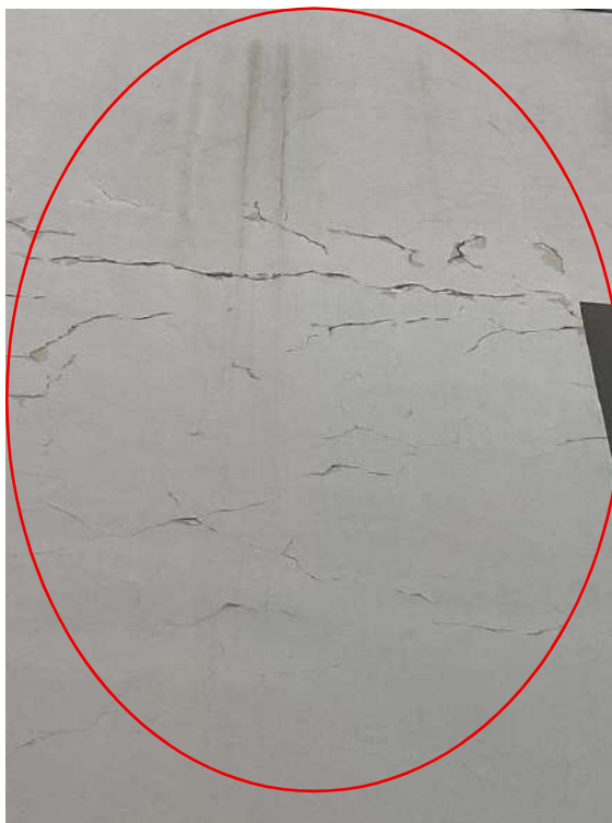
Fotografia 38 - Fissura por provável retração de argamassa
