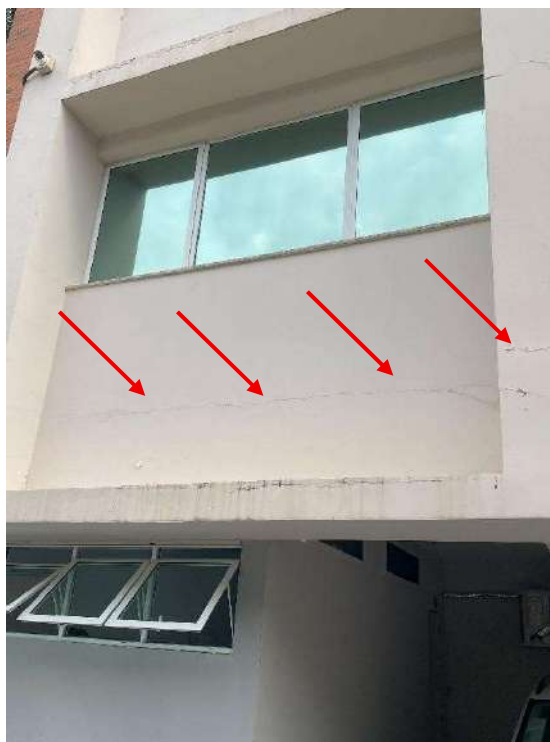
Fotografia 34 - Fissura por provável retração de argamassa
