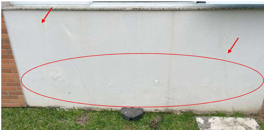
Fotografia 22 - Fissura por provável retração de argamassa / Infiltração
