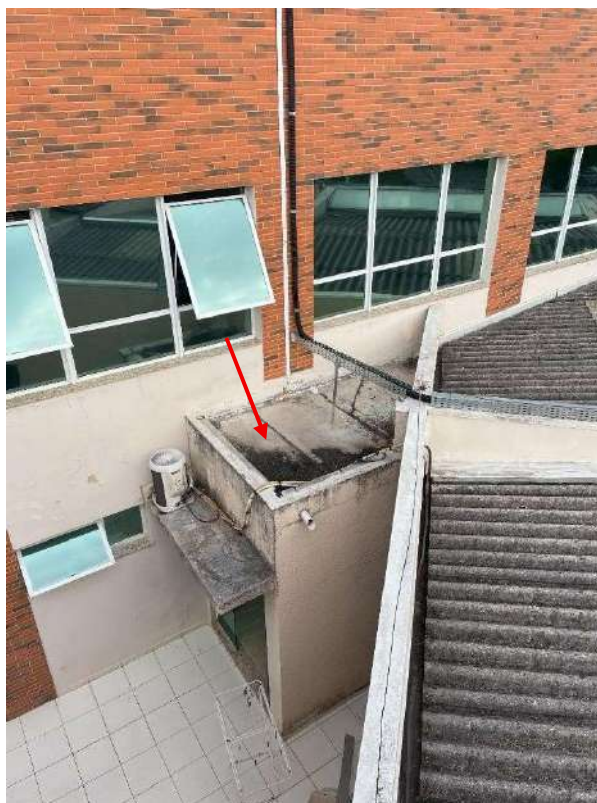
Fotografia 104 - Sistema de impermeabilização ineficiente
