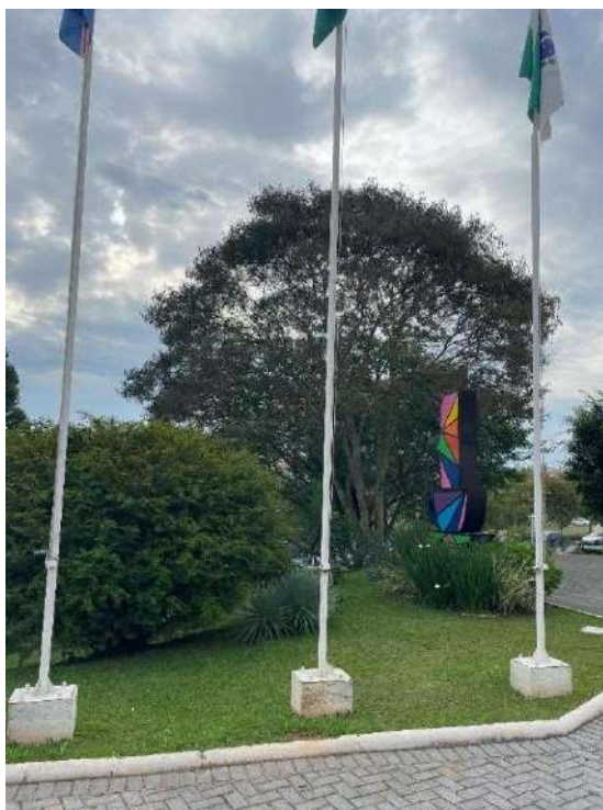
Fotografia 123 - Corrosão mastro metálico
