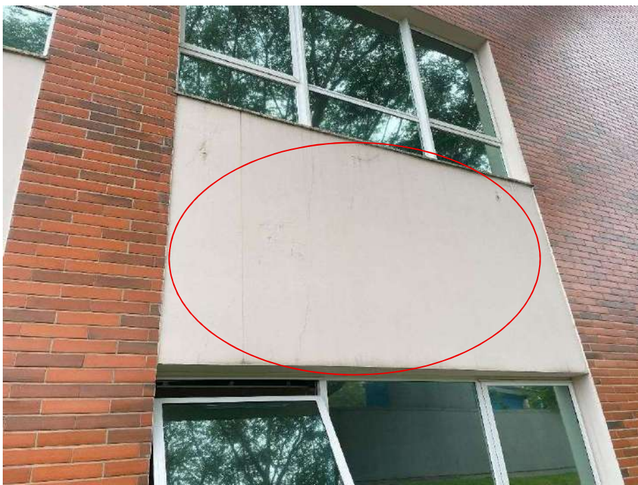
Fotografia 26 - Fissura por provável retração de argamassa.
