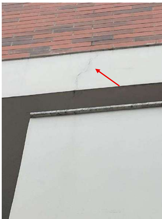
Fotografia 70 - Fissura por provável retração de argamassa
