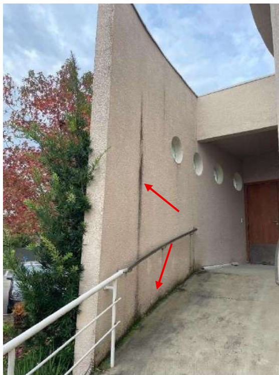
Fotografia 44 - manchas negras em fachada
