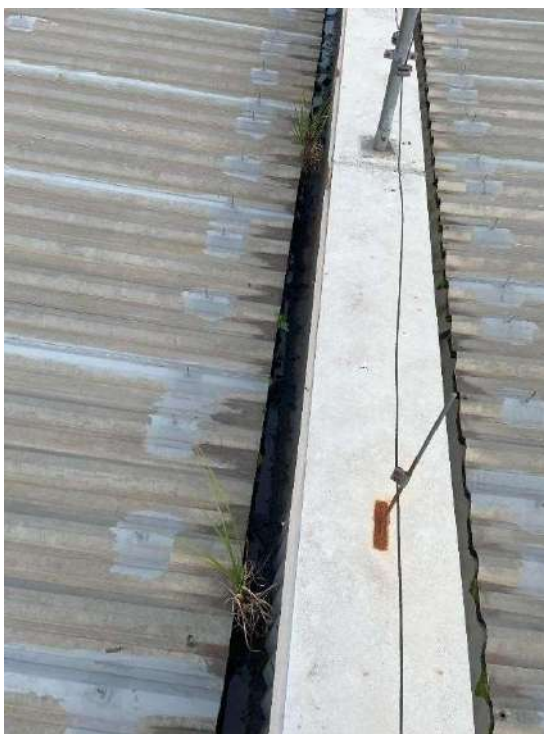
Fotografia 103 - Presença de vegetação nas calhas
