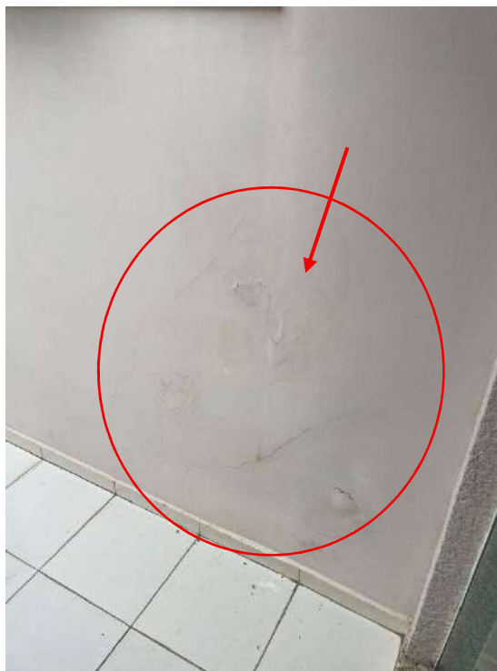
Fotografia 55 - Infiltração parede externa
