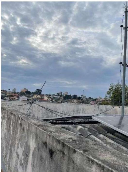
Fotografia 108 - manchas negras na platibanda
