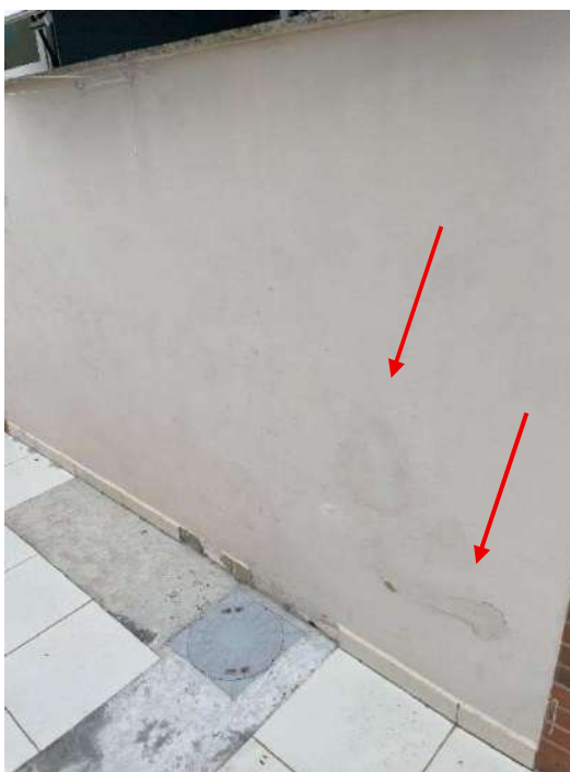
Fotografia 58 - Infiltração parede externa
