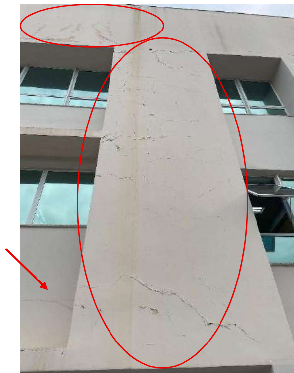
Fotografia 32 - Fissura por provável retração de argamassa
