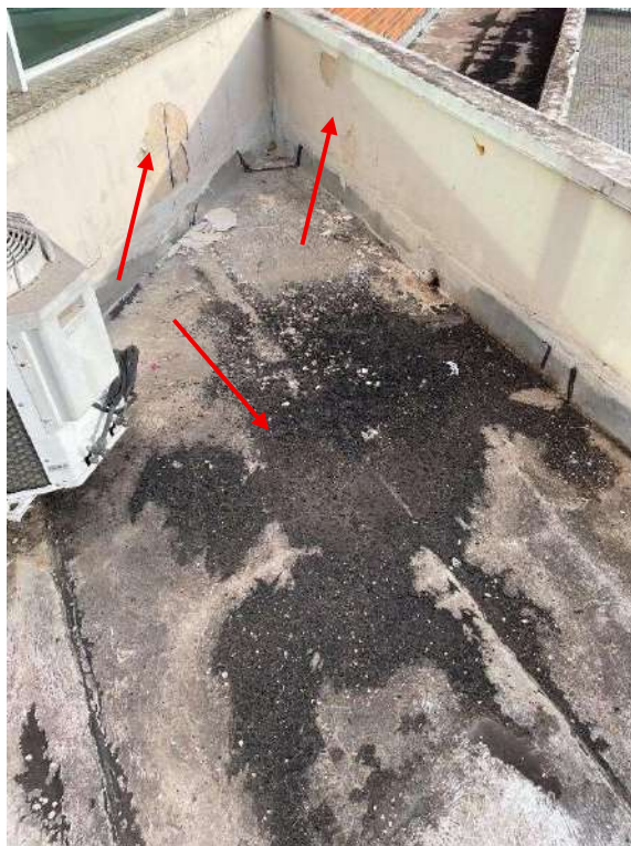
Fotografia 86 - Sistema de impermeabilização ineficiente / infiltrações na platibanda
