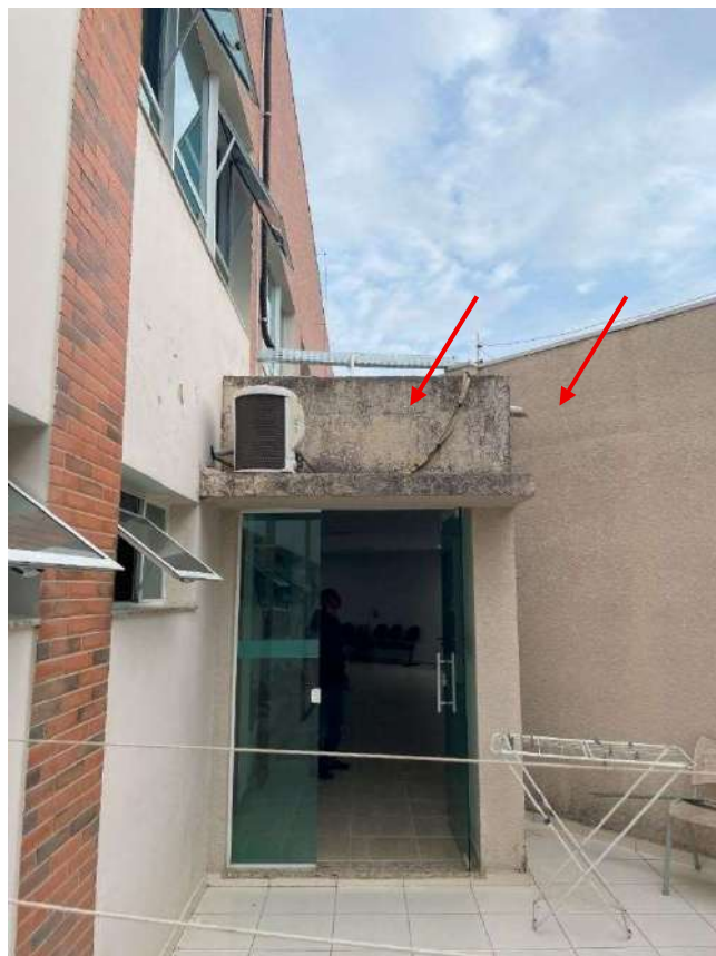
Fotografia 64 - manchas negras / infiltração
