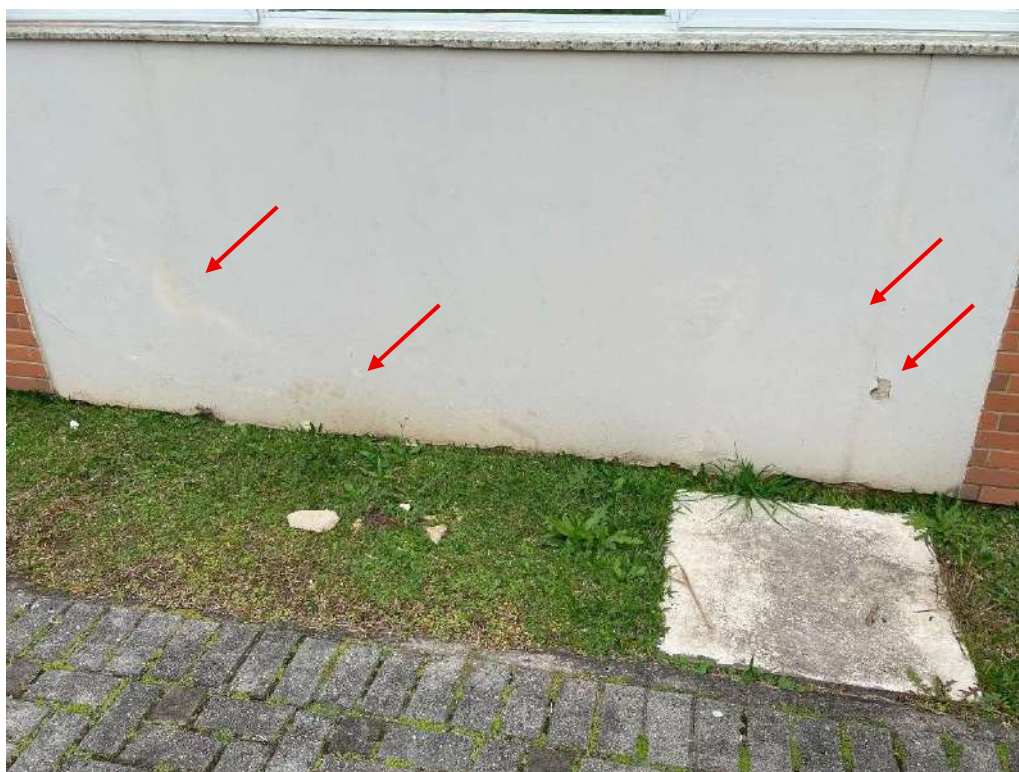
Fotografia 17 - Fissura por provável retração de argamassa / Infiltração
