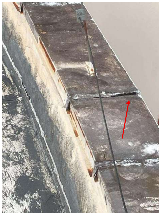
Fotografia 98 - Rufo deteriorado sem vedação entre chapas
