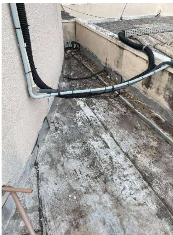
Fotografia 79 - Impermeabilização ineficiente; laje do auditório do plenário
