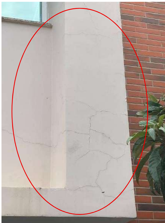
Fotografia 39 - Fissura por provável retração de argamassa
