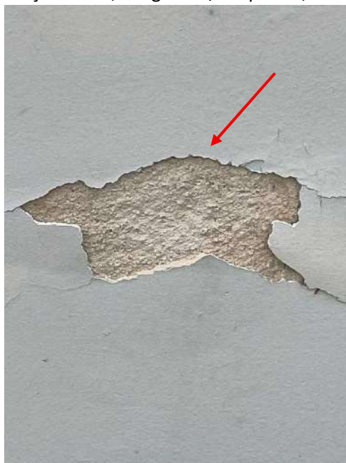
Fotografia 18 - Pulverulência de revestimento tipo emboço de fachada
