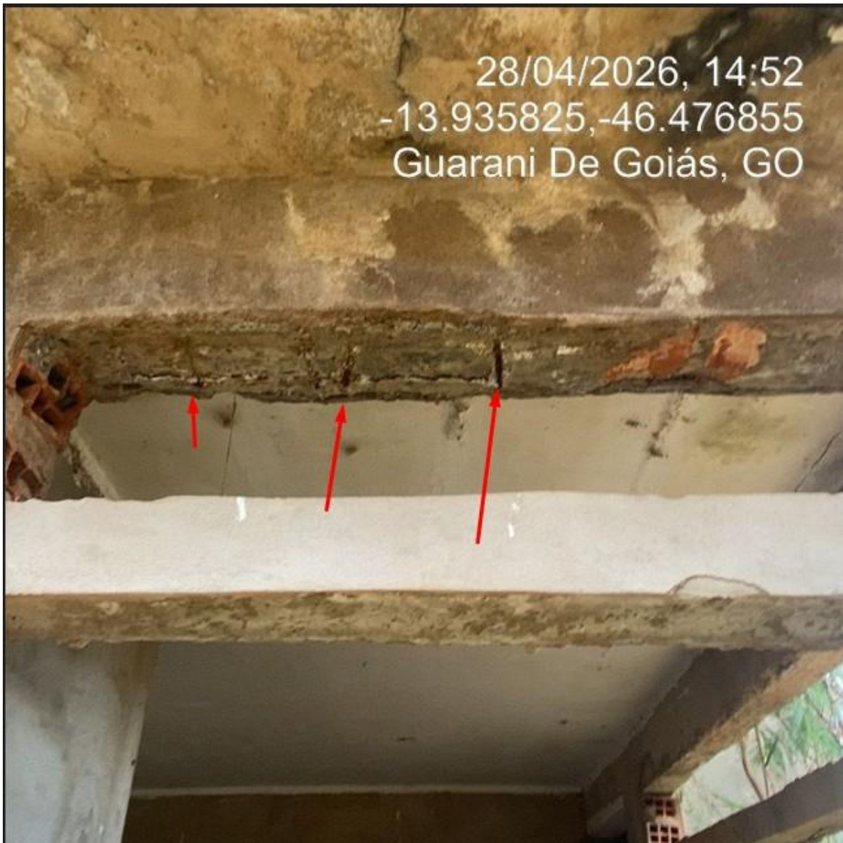
Foto 03: Imagem evidencia armadura exposta na viga, com indícios de oxidação, sinalizando comprometimento do cobrimento do concreto e potencial processo de deterioração do elemento estrutural.
