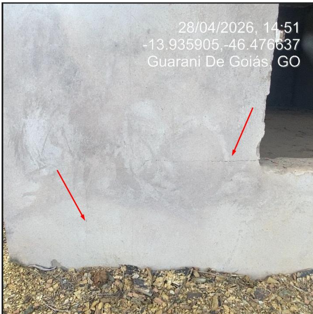
Foto 08: A imagem evidencia fissura horizontal próxima ao vão da janela, associada a fissuração vertical adjacente, com indícios de possível recalque Diferencial. A manifestação patológica demanda avaliação técnica complementar para verificação da causa e do eventual comprometimento da alvenaria/elemento estrutural.
