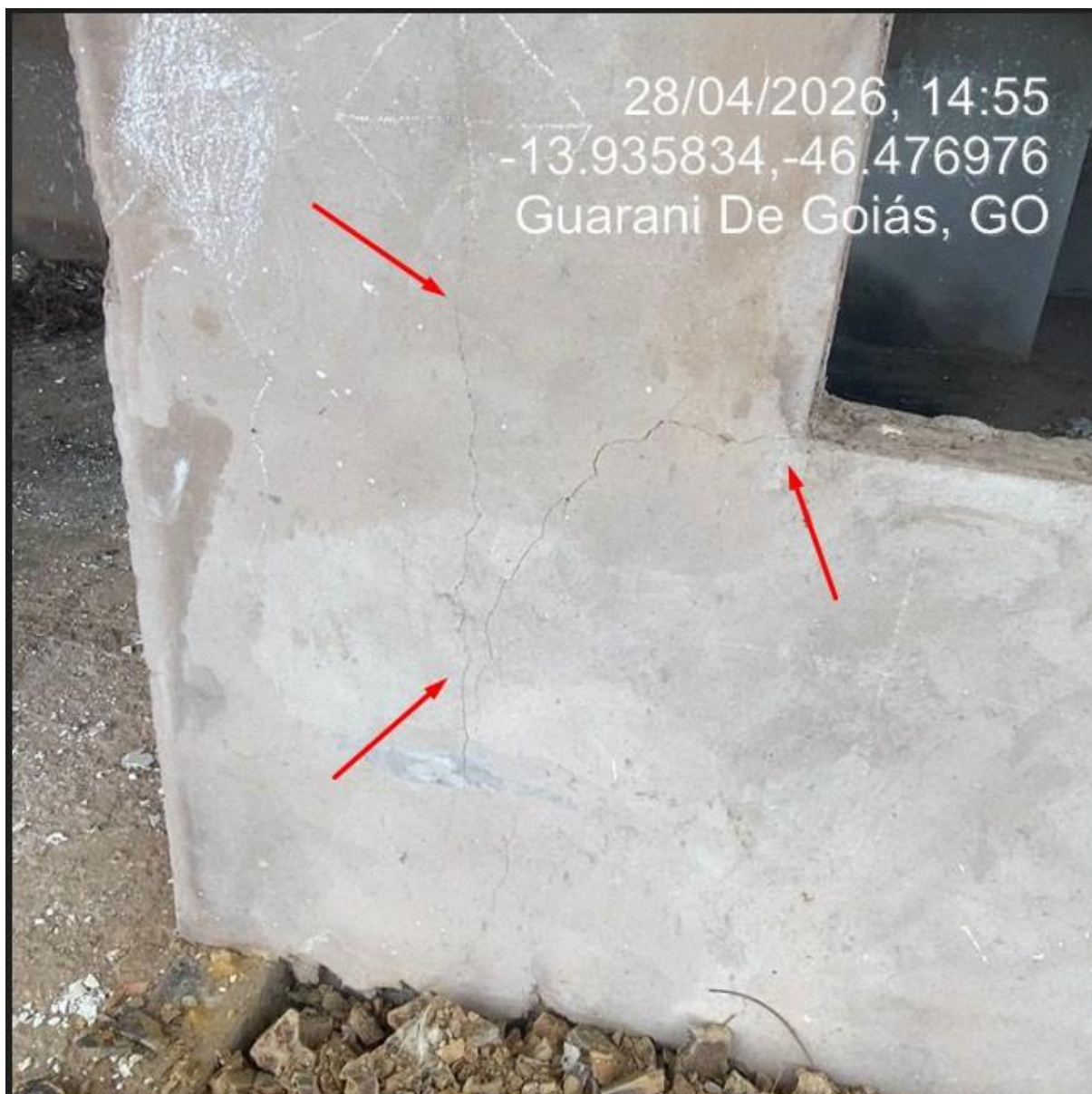
Foto 10: A imagem evidencia trinca inclinada a aproximadamente 45°, com indícios de recalque diferencial, sugerindo movimentação da fundação e possível comprometimento localizado da alvenaria
