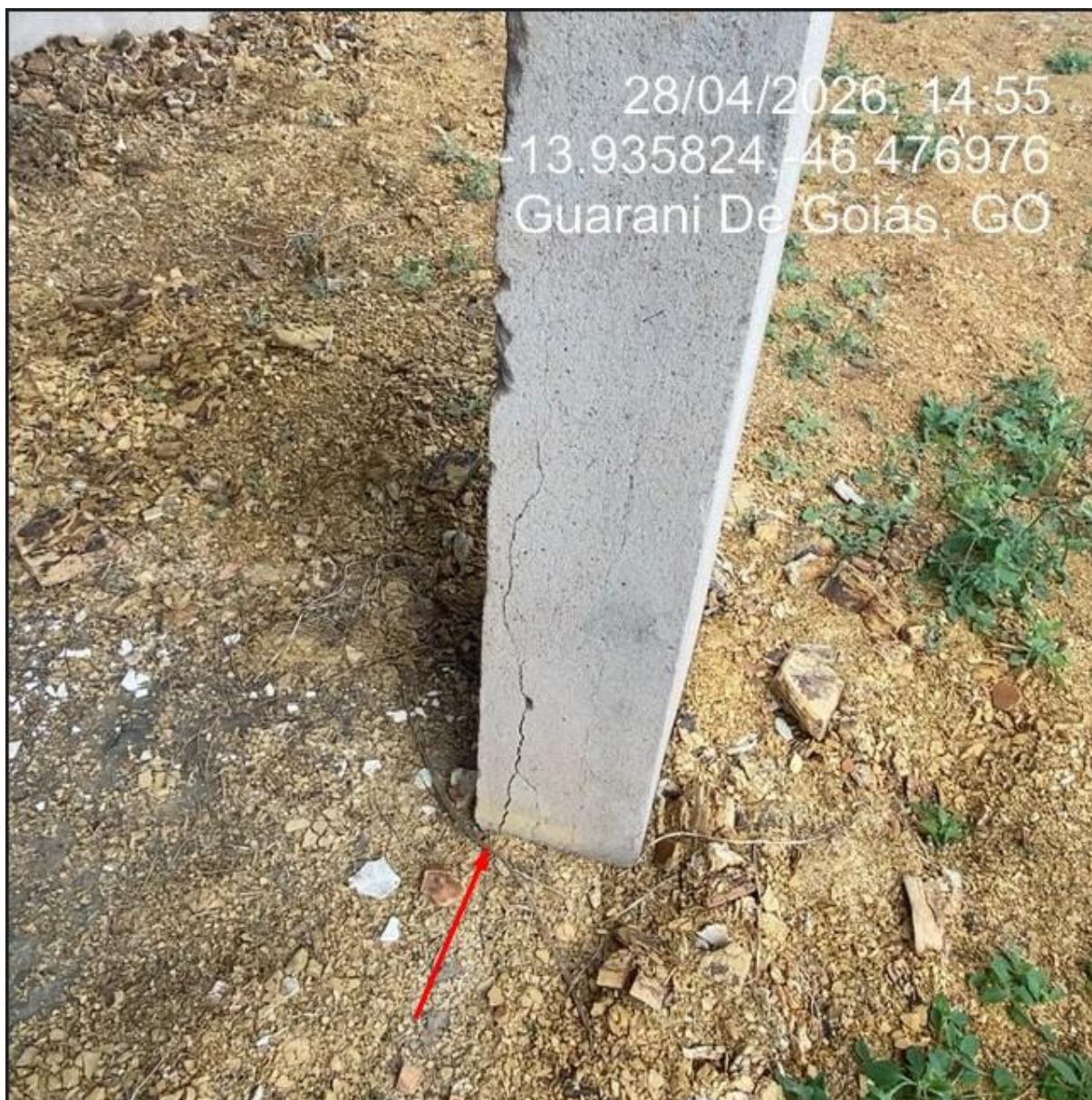
Foto 02: A foto evidencia fissura na base do pilar, com indícios de oxidação da armadura e exposição do elemento estrutural, caracterizando possível processo de deterioração do concreto e necessidade de avaliação técnica complementar.
