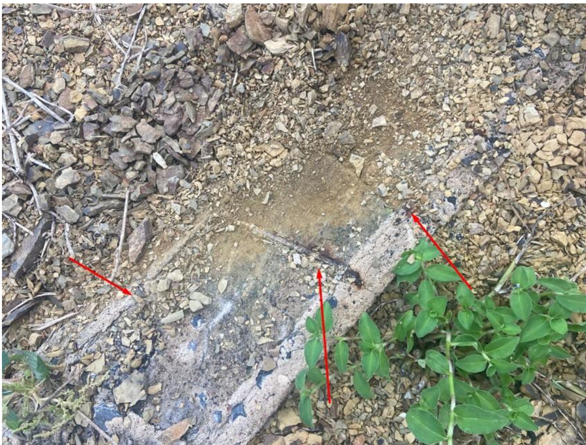
Foto 07: A imagem evidencia armadura exposta na viga baldrame, com indícios de corrosão, indicando deficiência no cobrimento do concreto e possível comprometimento da durabilidade do elemento estrutural.
