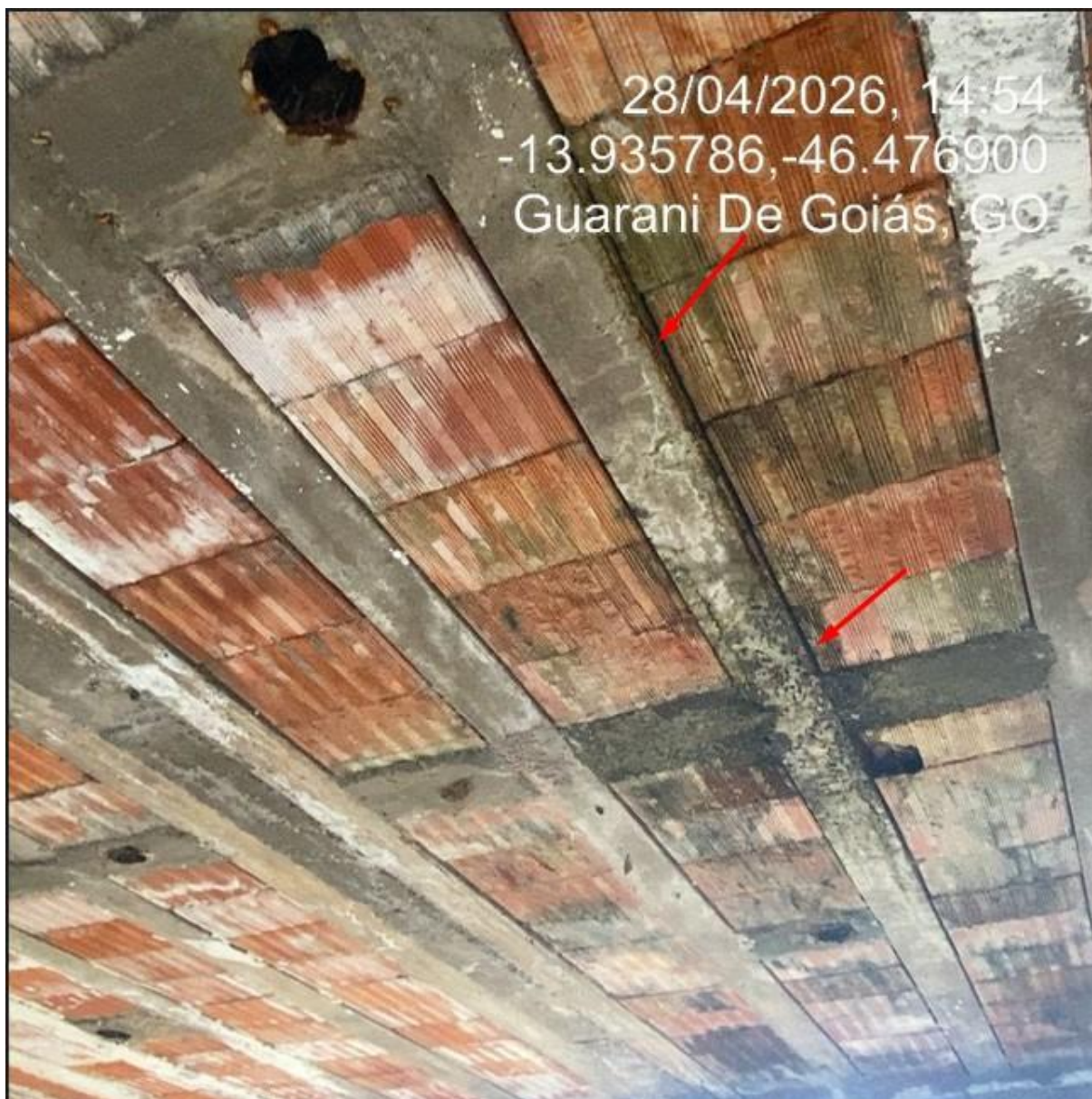
Foto 04: A imagem evidencia laje volterrana com armadura exposta, cobrimento insuficiente e indícios de oxidação, indicando deficiência na proteção da armadura e possível processo de deterioração do elemento estrutural.
