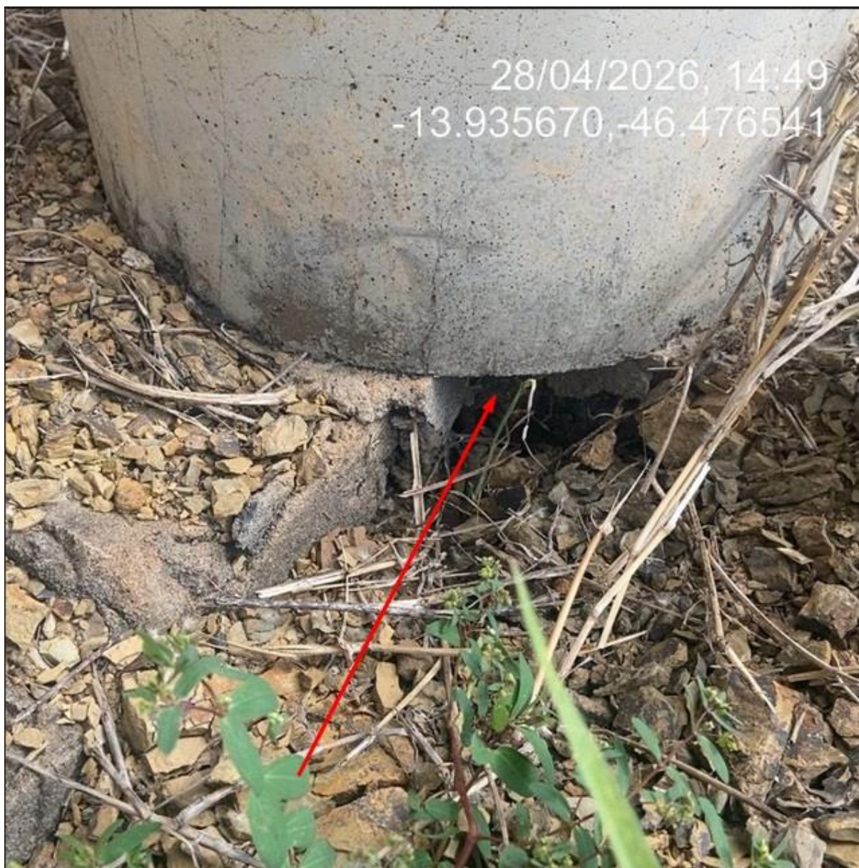
Foto 06: A imagem evidencia pilar executado com possível deslocamento de eixo em relação ao projeto, gerando excentricidade na transferência de cargas para a fundação.
