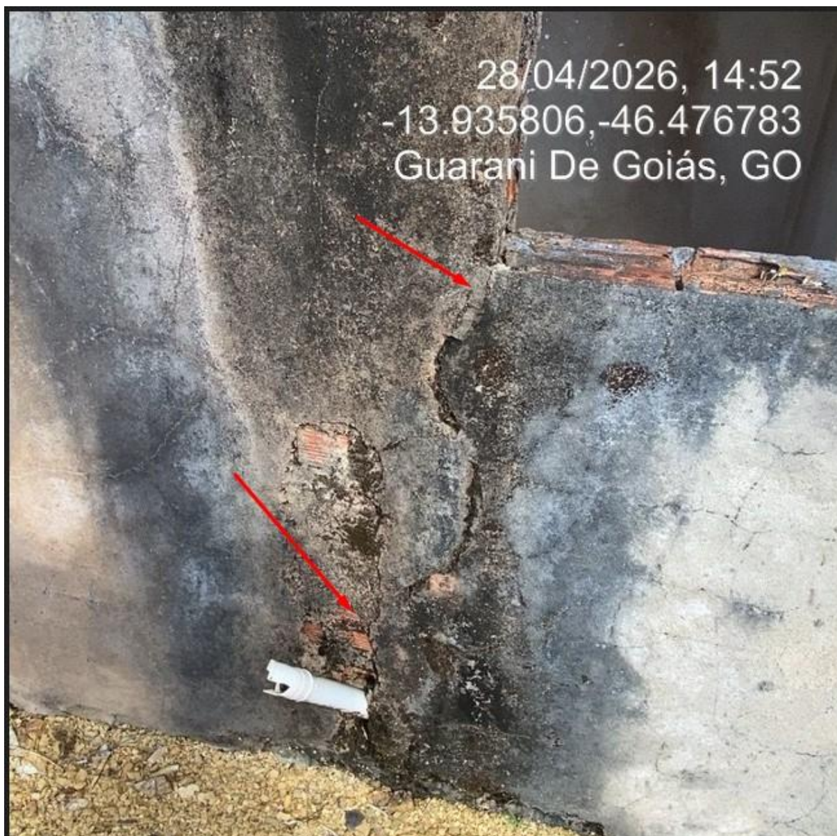
Foto 01: Fissura vertical próxima ao vão da janela, possivelmente associada à ausência de contraverga, indicando falha no reforço estrutural do elemento de abertura.
