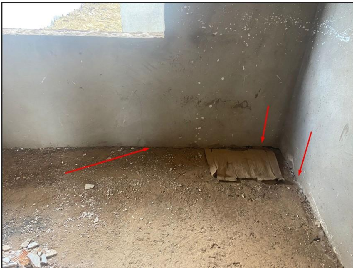
Foto 09: A imagem evidencia abertura/dilatação entre a parede e o piso, com indícios de movimentação da estrutura, podendo estar associada a recalque, acomodação diferencial ou deficiência de vinculação entre os elementos construtivos.
