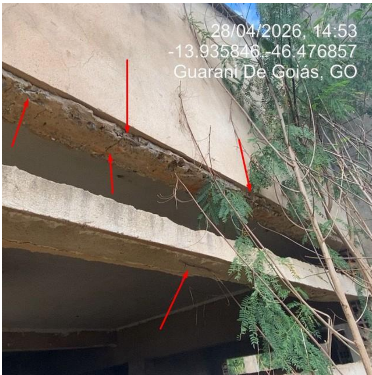
Foto 05: A imagem evidencia armadura exposta, com indícios de oxidação, caracterizando deficiência de cobrimento e potencial processo de deterioração do elemento estrutural.
