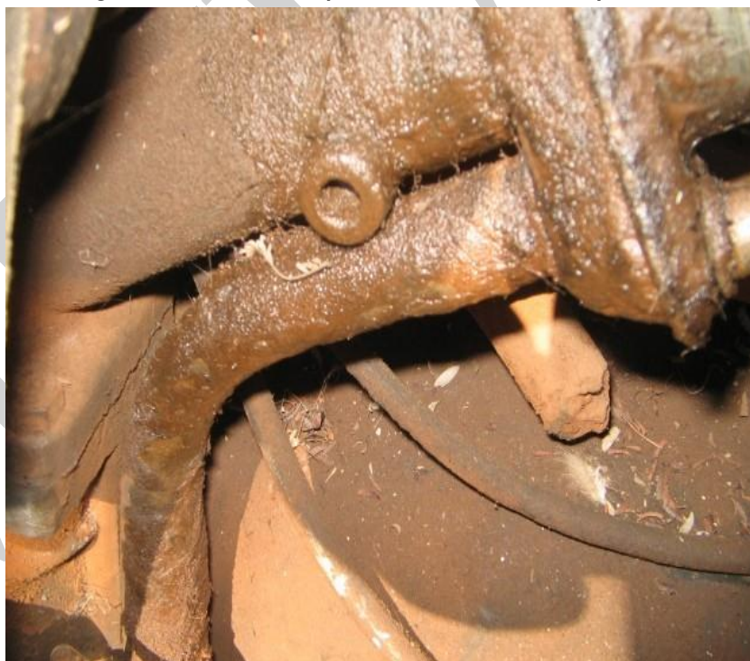
Fig.8 - Inspeção de Motor com vazamento de óleo.
