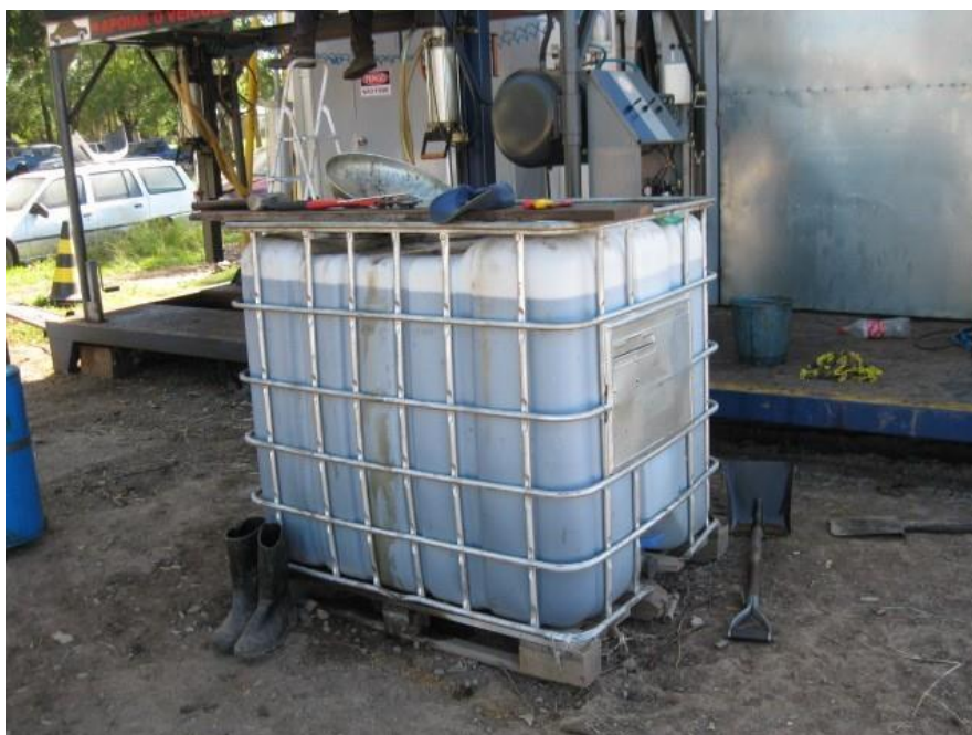
Fig.3 - Reservatório de coleta de fluidos – Combustível ou Lubrificantes;
