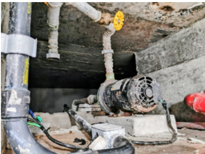
Foto do sistema de elevação de água, falta a bomba que está em manutenção
