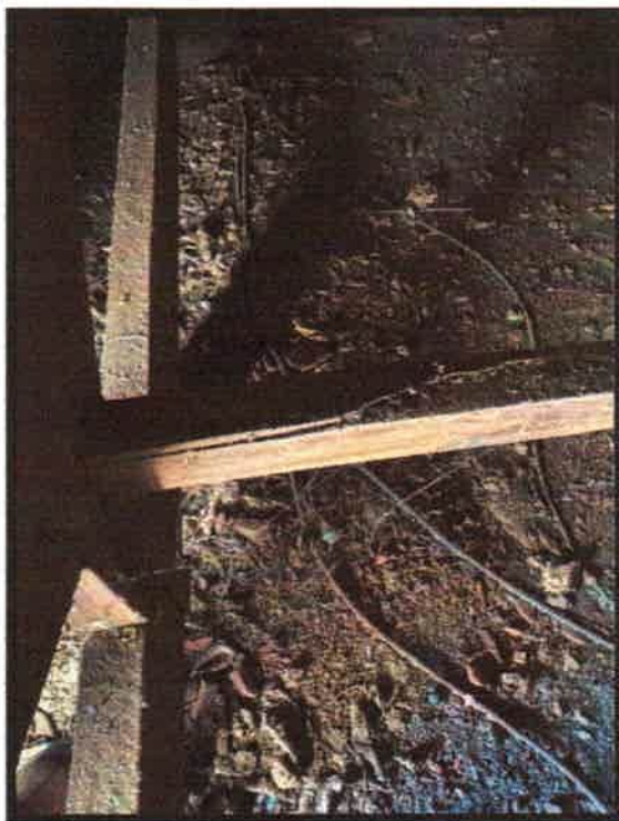
ESTRUTURA DE TRAVAMENTO COM RACHADURAS.
