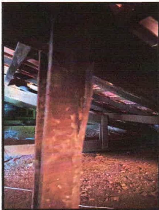
TIRANTES COM ELEMENTOS COMPROMETIDOS.
