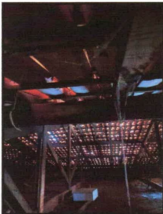
INFESTAÇÃO DE CUPIM NAS RIPAS.
