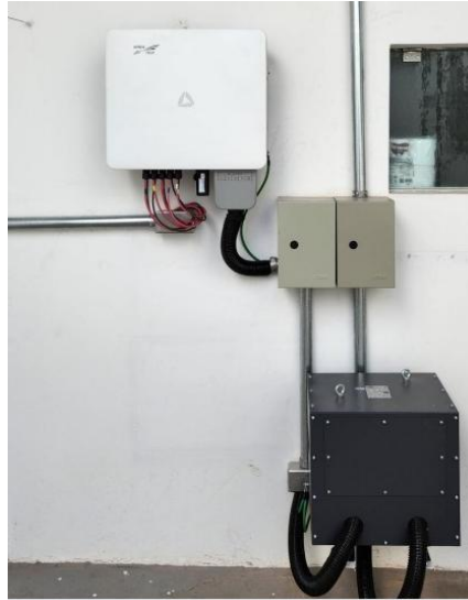
Imagem 02 – Inversor e transformador instalados
