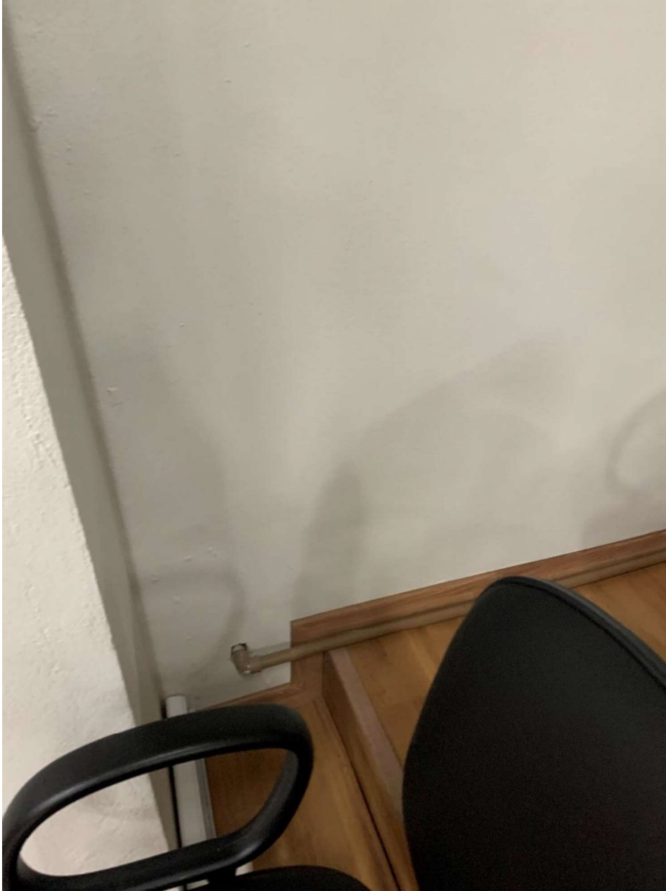
Figura 12 – Vista interna, região da arquibancada, onde observa-se tubulação do dreno do ar-condicionado aparente.
