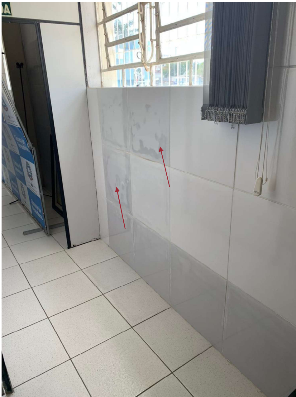
Figura 14 – Vista da parede dos fundos da edificação, face interna, localizada na divisa leste onde observa-se placas cerâmicas com alteração de cor, sinais que indicam presença de umidade.
