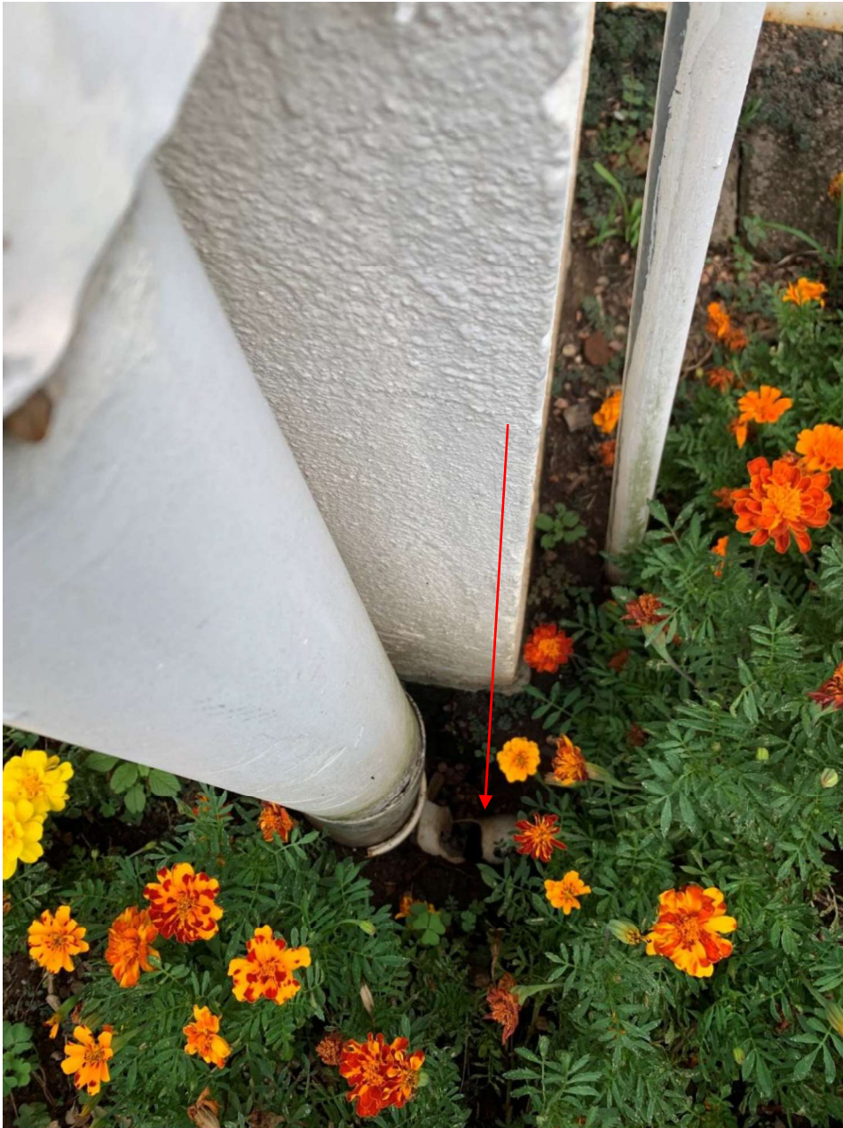
Figura 10 – Vista externa, fundos da edificação, onde observa-se tubulação pluvial rompida.
