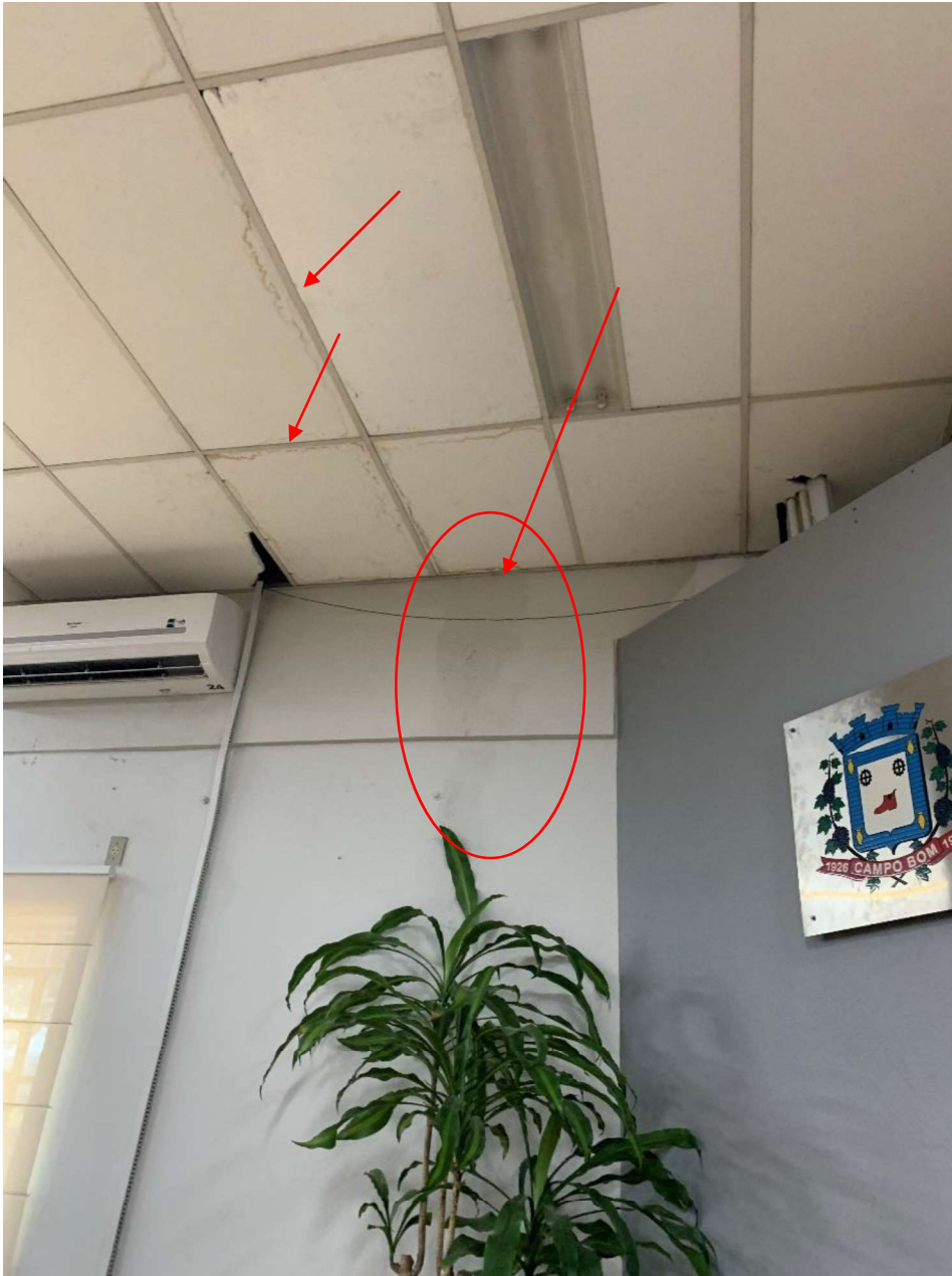
Figura 4 – Vista interna, região com manchas de umidade na parede e no forro, que sinalizam ocorrências de infiltração proveniente da cobertura.
