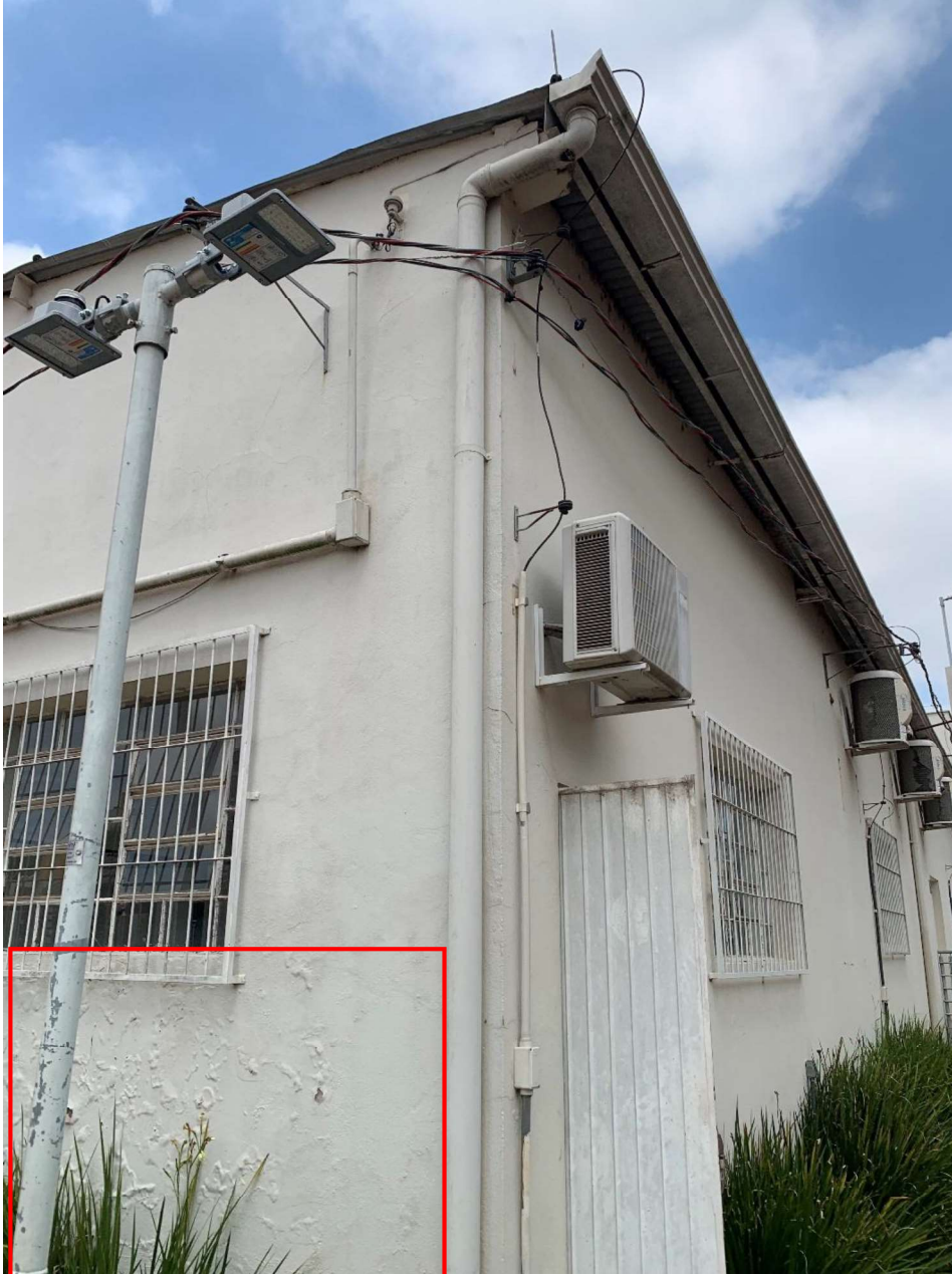
Figura 11 – Vista externa. Fundos da edificação, onde observa-se pintura com bolhas, indícios da presença de umidade.
