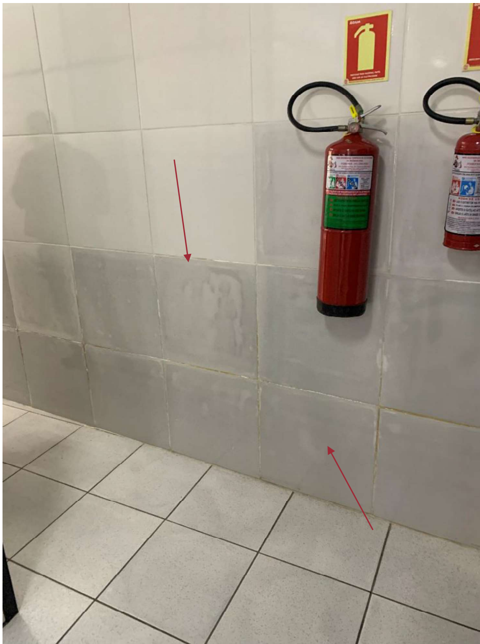
Figura 13 – Vista da parede dos fundos da edificação, face interna, localizada na divisa leste onde observa-se placas cerâmicas com alteração de cor, sinais que indicam presença de umidade.
