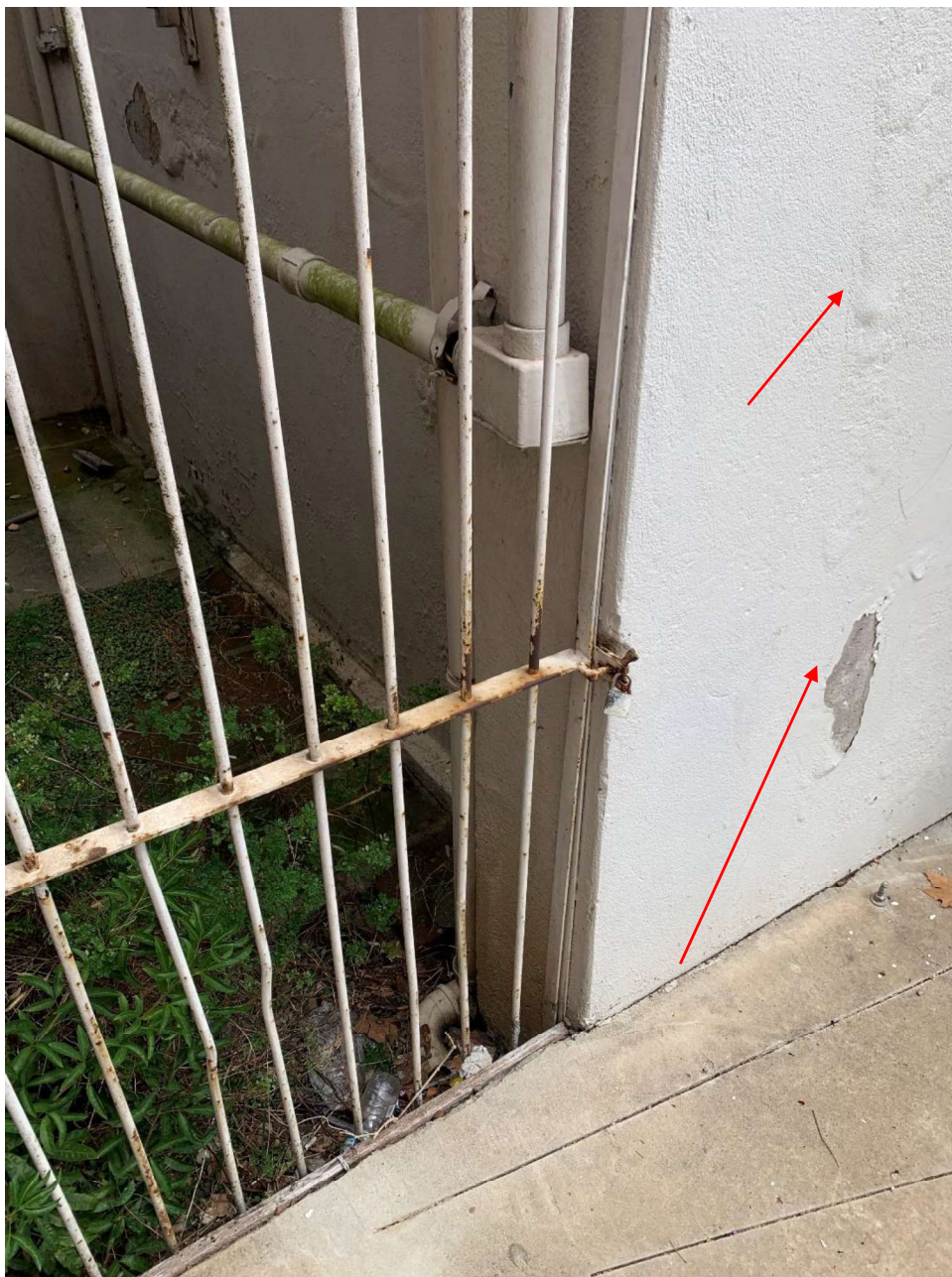
Figura 8 – Vista externa, fundos da edificação, onde observa-se pintura com bolhas e escamação, indícios da presença de umidade.
