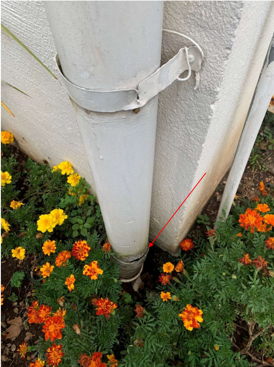
Figura 9 – Vista externa, fundos da edificação, onde observa-se tubulação pluvial rompida.
